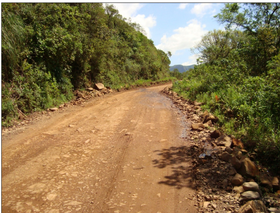
FIGURA 2.1.3 – FOTO: CONDIÇÃO ATUAL DA BR-285 EM SANTA CATARINA
