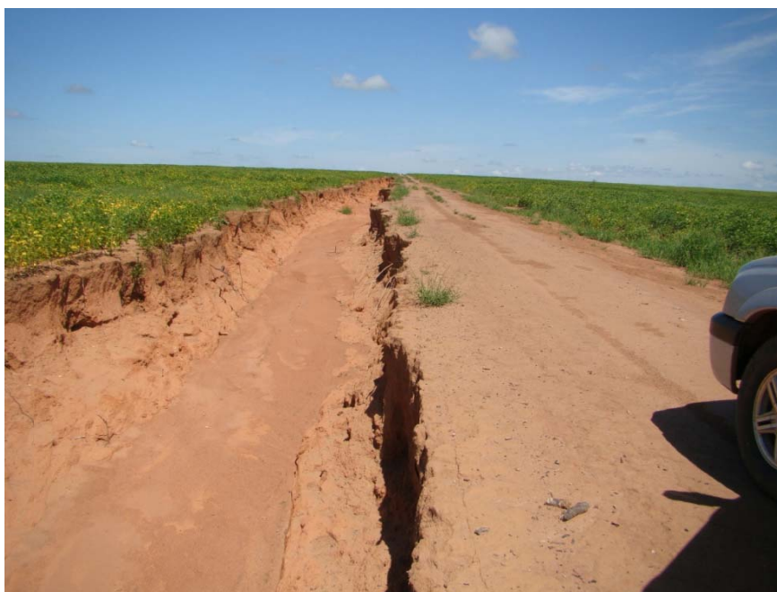
Figura 5-19: Aspecto da feição erosiva linear instalada na estrada da lavoura paralela ao traçado da BR-242 numa vertente ampla onde há plantio de soja e arroz. Nota-se ausência de curvas de nível ou estruturas de contenção das águas pluviais onde predominam os Latossolos Vermelho Amarelos de textura média.
