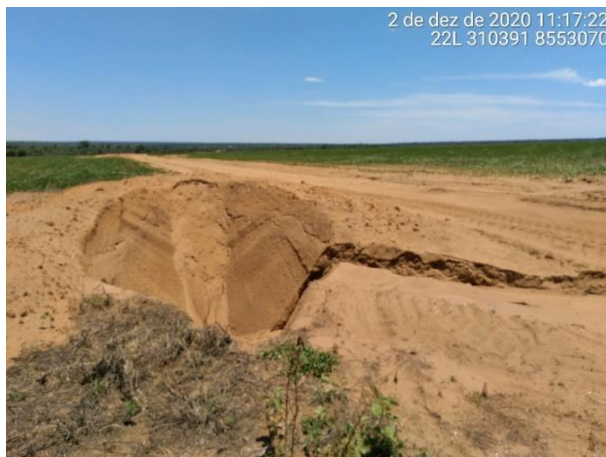
Figura 51: Exposição de areia quartzosa, predisposição a processos erosivos iniciais. Não possui plasticidade. Solos rasos de textura arenosa.
