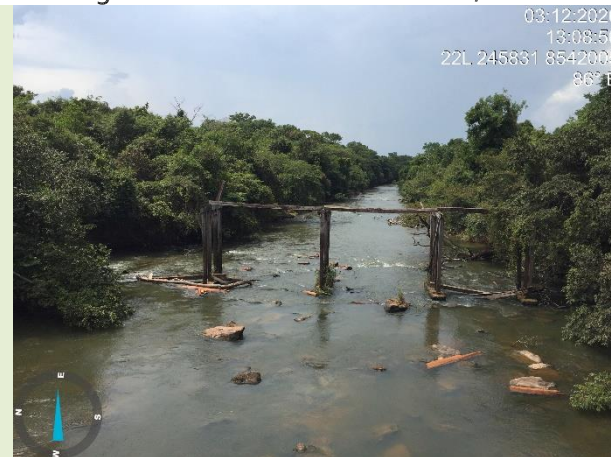
Figura 13: Ponte sobre o rio Pacuneiro, localizada na unidade de relevo Planície Amazônica. UTM: 22 L 242435/8538258.
