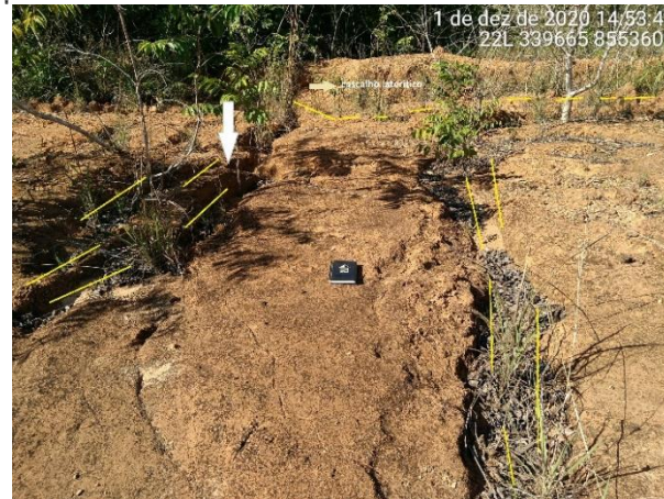
Figura 27: Ravinamento em solo laterítico concrecionário.
