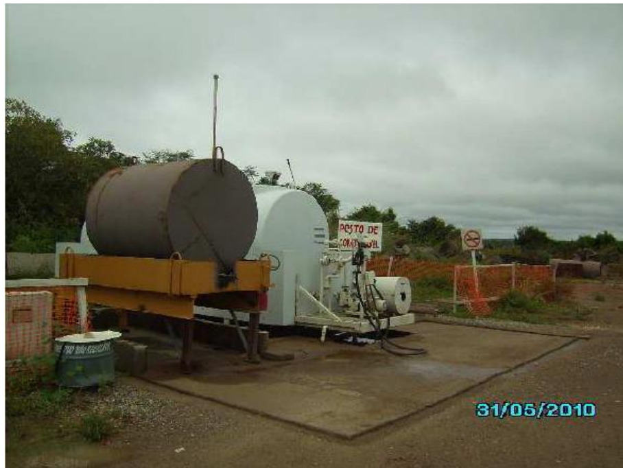
FIGURA 6 – DEPÓSITO DE COMBUSTÍVEL
