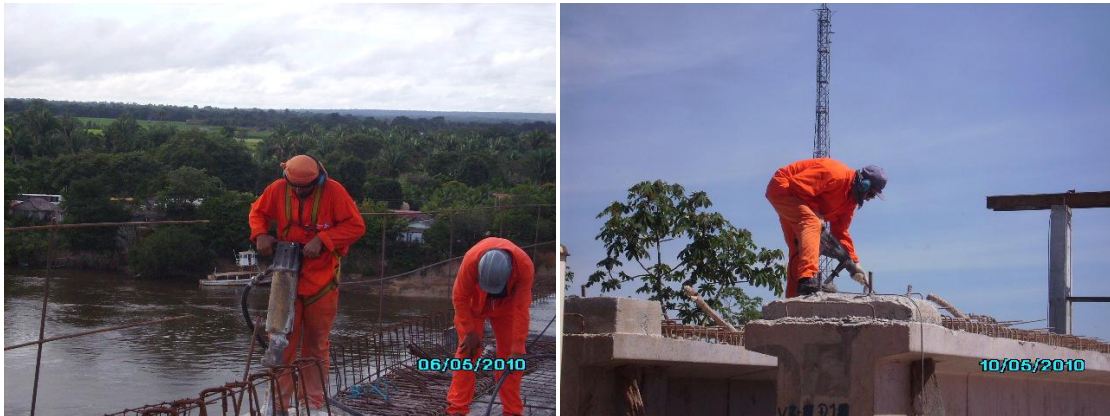
FIGURA 15 – FUNCIONÁRIOS UTILIZANDO PROTEÇÃO AURICULAR
