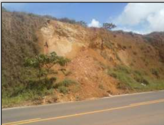
Foto 874 – Desmoronamento de talude para pista de rolamento. Lado esquerdo. Estaca 989. S 03. 25520° W 052. 35238° 25/03/2014.
