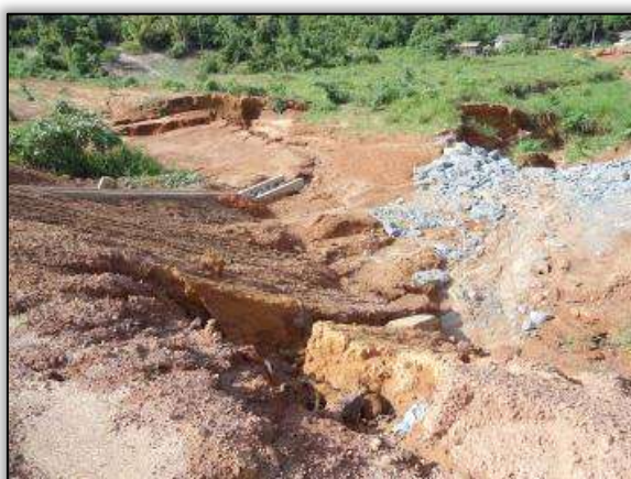
Foto 1363 – (Antes) Processos erosivos na lateral da pista. Lado direito. Estaca 4468. UTM E 406886 N 9656451 09/02/2012
