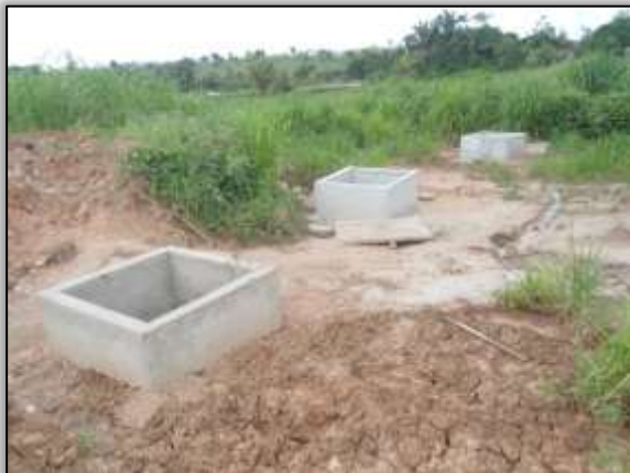
Foto 751 – Construção de caixa separadora de água e óleo. Lado esquerdo. Estaca 561 S 03.45172° e W 051.21874° 09/07/2014
