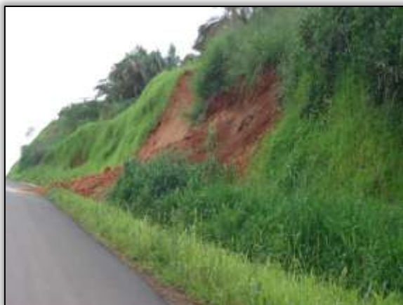
Foto 691 – Desbarrancamento de talude. Lado direito. S 04.04263º W 050.29497º 18/02/2014
