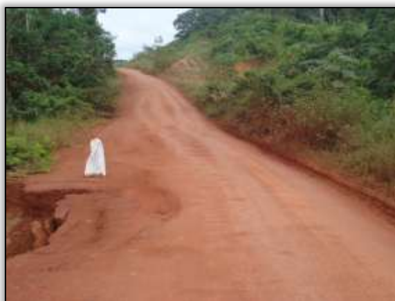
Foto 1209 – Erosão avançando para a parte central da pista. S 03.50248° W 053.06900° 14/05/2014.
