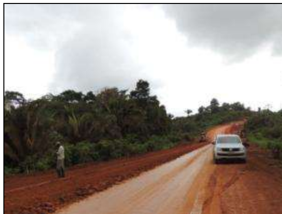
Figura 55. Acompanhamento da terraplenagem entre Marabá e Itupiranga – Lote Único. Data: 11/01/2014_22M 0673000 E / 9440011 N
