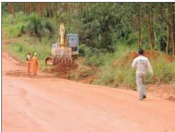
Figura 104. Acompanhamento de limpeza na faixa de domínio, trecho entre Marabá e Itupiranga – Lote único. Data: 16/04/2014 _ 22M 0678830 E / 9429786 N
