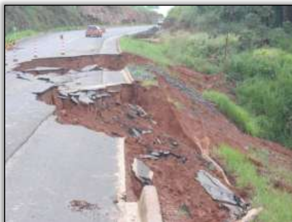
Foto 879 – Processo erosivo na saia do aterro. Lado esquerdo. Estaca 1904. S 03.31088° W 052.54976° 23/03/2014.
