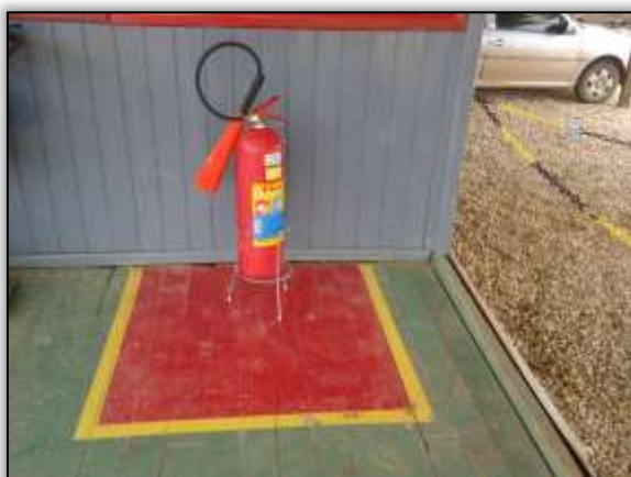
Foto 568 – Extintor de incêndio. S 05.14380° W 049.35746° 13/03/2014
