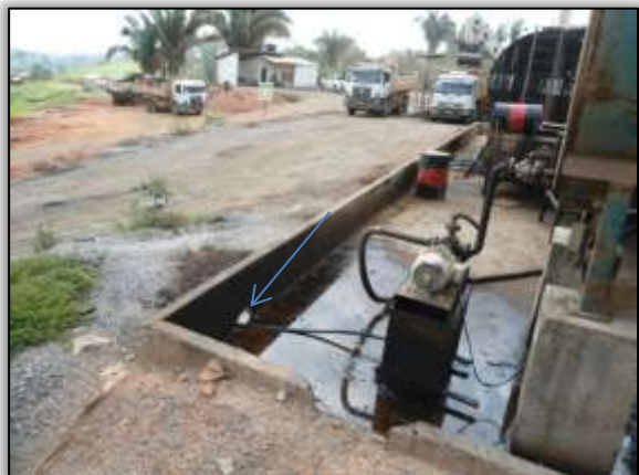
Foto 759 – Vazamento de óleo fora da caixa de contenção em 05/12/2013. Lado esquerdo. Estaca 589. S 03.44761° e W 051.22448°
