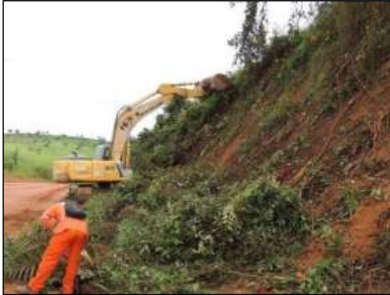
Figura 180. Supressão vegetal em talude no trecho entre Marabá e Itupiranga – Lote Único Data: 12/04/2014 _ 22M 0678654 E / 9430025 N
