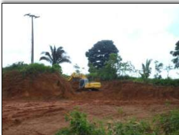
Foto 1075 - Corte em talude. Lado esquerdo. Estaca 9429. S 03.88754°W054. 39362°. 25/02/2014.
