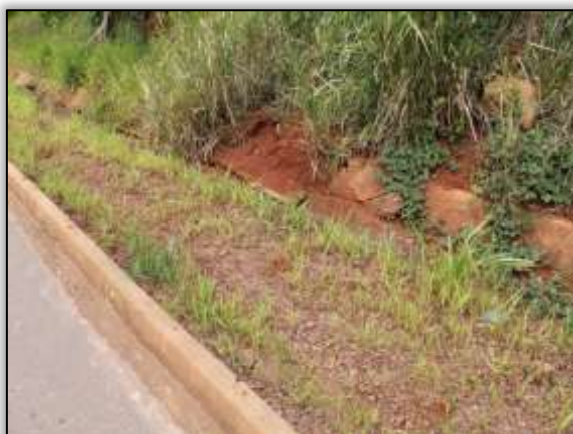
Foto 1338 – Erosão no pé do talude e danificação de sarjeta. Lado Esquerdo. Estaca 2409. S 03. 35645° W 052. 62640° 17/04/2014.
