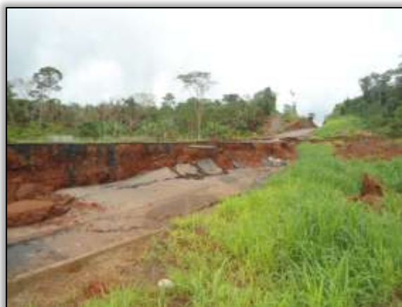
Foto 881 – Processo erosivo na saia do aterro. Lado esquerdo. Estaca 3700. S 03.44083° W 052.83850° 23/03/2014.
