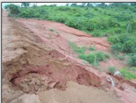
Foto 1359 – (Antes) Processo erosivo na saída do aterro. Lado esquerdo. Estaca 4109. UTM 419217 N 965072 09/02/2012)
