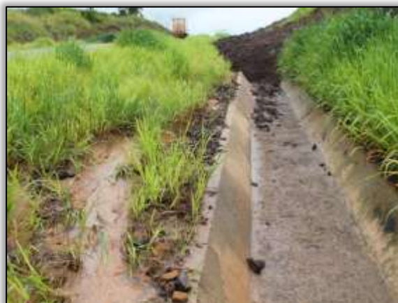
Foto 1331 – Processo erosivo talude de corte e obstrução de sarjeta. Lado direito. Estaca 2660. S 03. 37794° W 052. 66514° 17/04/2014.
