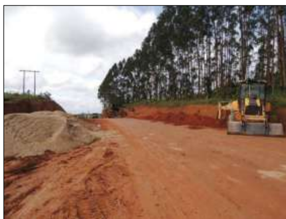
Figura 113. Obra de terraplenagem no trecho entre Marabá e Itupiranga – Lote 01. Data: 24/04/2014 _ 22M 0679062 E / 9429523 N
