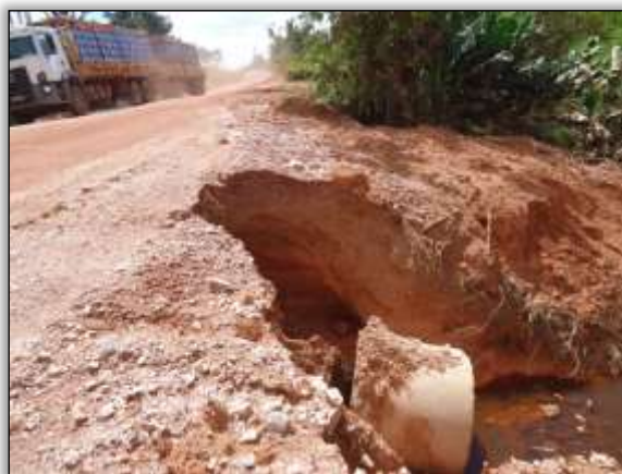
Foto 1213 – Rompimento de bueiro simples tubular de concreto. Lado esquerdo. S 04.21486° W 049.91790° 29/04/2014
