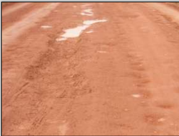
Foto 1193 – Formação de buracos na pista. S 03.68434° W 053.57178° 15/04/2014.
