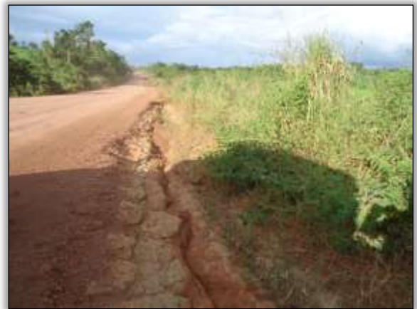
Foto 1239 - Processo erosivo no bordo da pista. Lado direito.04.11344° W 049.83410 24/07/2014
