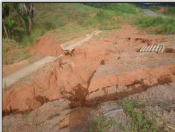
Foto 1316 – Rompimento de dreno/aterro de bota fora solto. Lado esquerdo (antes) S 03.94136º W 050.30764º 18/02/2014
