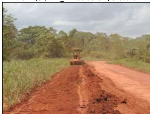
Figura 69. Acompanhamento da terraplenagem no trecho entre Medicilândia e Uruará – Lote 01. Data: 18/01/2014 _ 22M 0238186 E / 9599487 N
