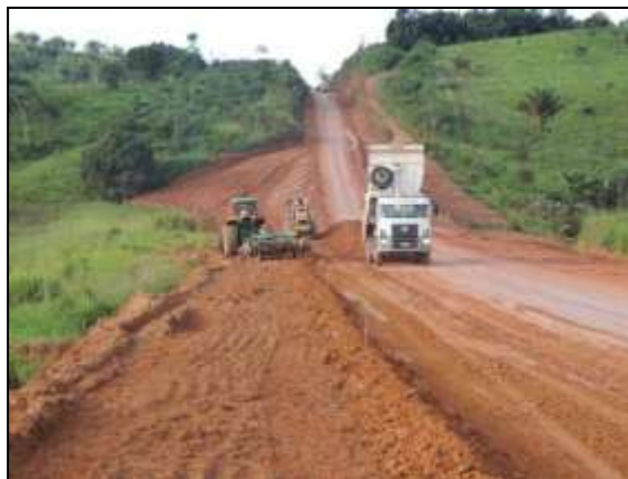
Figura 123. Compactação de aterro entre Itupiranga e Cajazeiras – Lote 01. Data: 05/05/2014 _ 22M 0671245 E / 9445517 N
