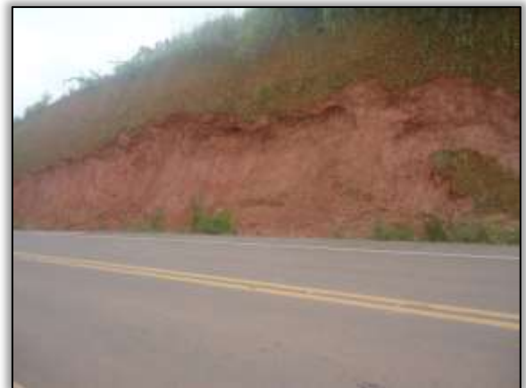
Foto 690 – Desbarrancamento de talude. Lado direito. S 03.97070º W 050.26173º 18/02/2014
