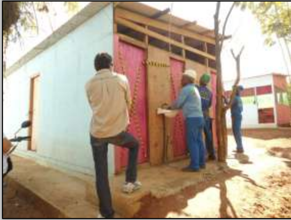
Foto 920 – Interdição dos banheiros. Lado esquerdo. S 03.31975° W 052.56762° 25/06/2014.
