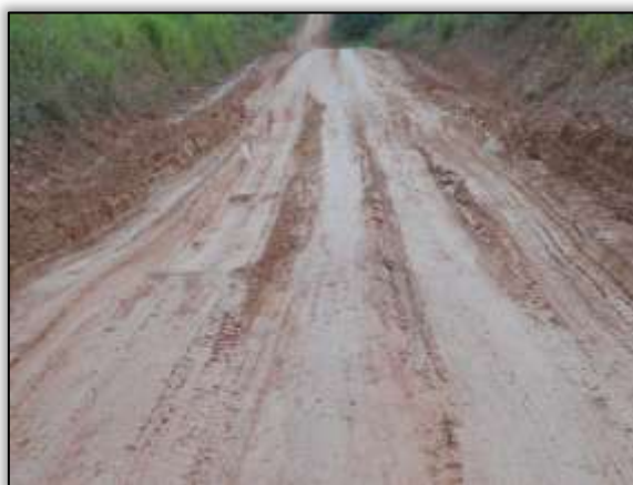
Foto 1176 – Buraco na pista. S 03.51697° W 053.13721° 19/03/2014.
