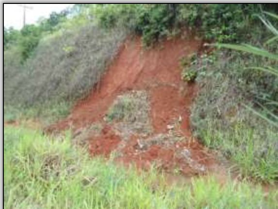
Foto 864 – Desmoronamento de talude de corte e obstrução de sarjeta. Lado direito. Estaca 2322. S 03. 34745° W 052. 61386° 25/03/2014.
