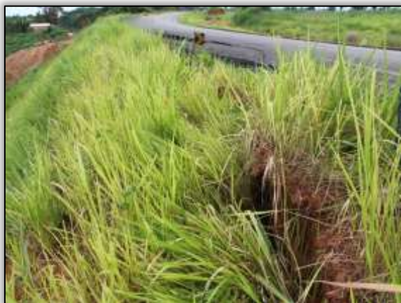
Foto 1336 – Erosão na saia do aterro. Lado Esquerdo. S 03. 36070° W 052. 63250° 17/04/2014.
