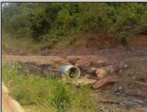
Foto 872 – Erosão e sarjeta e bueiro danificados. Lado direito. Estaca 2660. S 03. 37794° W 052. 66514° 25/03/2014.
