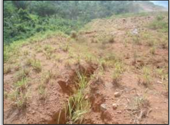
Foto 1145 – Erosão na saia de aterro. Lado direito. S 03.72594° W 050.87890° 25/02/2014
