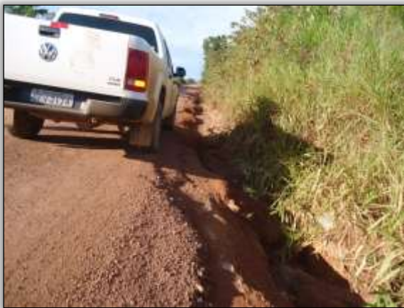
Foto 1238 - Processo erosivo no bordo da pista. Lado direito.04.11844° W 049.84410 24/07/2014
