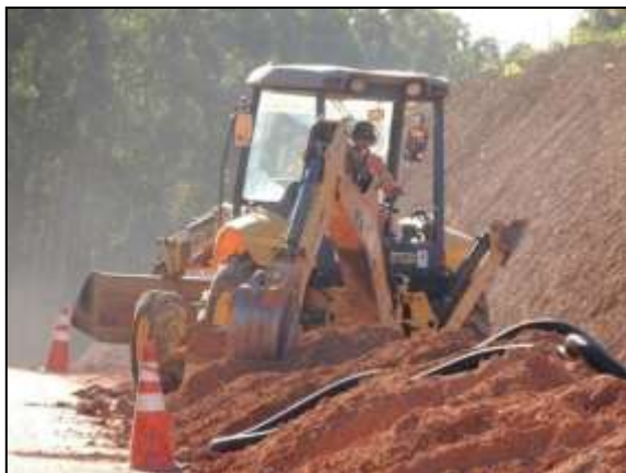
Figura 122. Colocação de dreno, trecho entre Marabá e Itupiranga – Lote único. Data: 05/05/2014 _ 22M 0679213 E / 9429417N
