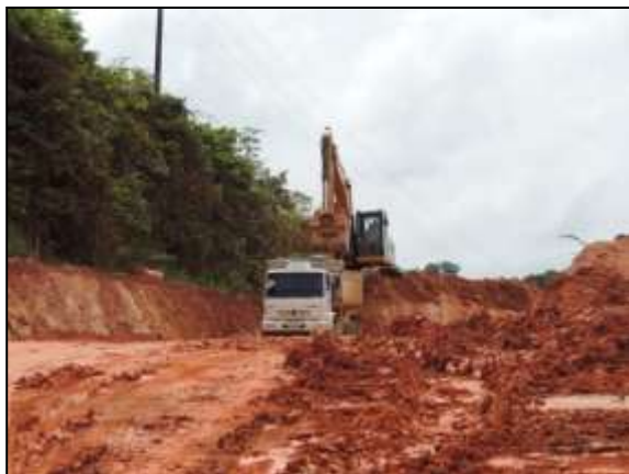
Figura 66. Acompanhamento de retirada de material úmido entre Itupiranga e Cajazeiras – Lote 01. Data: 15/01/2014 _ 22M 0673203 E / 9439844 N
