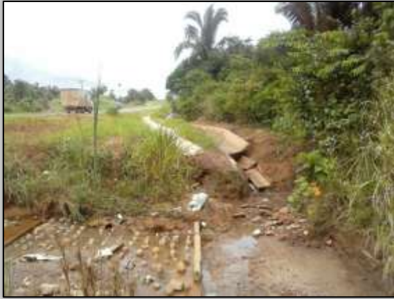
Foto 870 – Erosão e sarjeta danificada. Lado direito. Estaca 2660. S 03. 37794° W 052. 66514° 25/03/2014.
