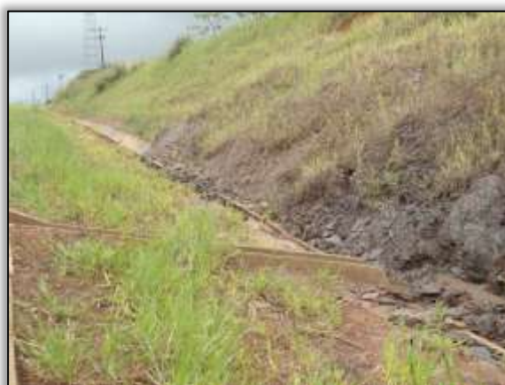
Foto 867 – Desmoronamento de talude de corte e obstrução de sarjeta. Lado direito. Estaca 2420. S 03. 35758° W 052. 62798° 25/03/2014.
