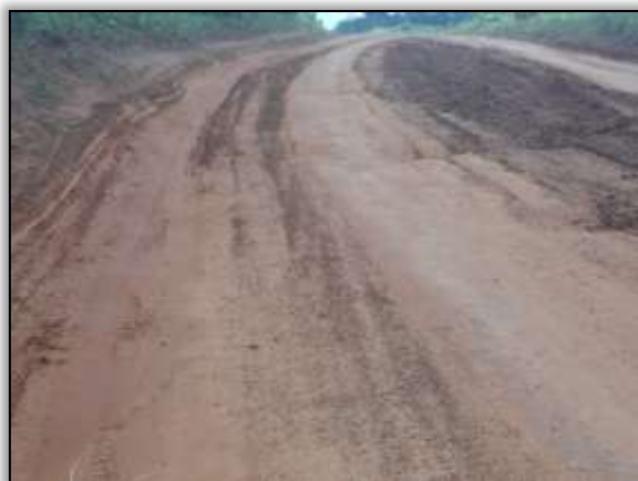
Foto 1159 - Buracos na pista. S 03.63044° W 053.41615°. 26/02/2014.
