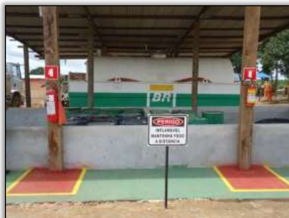
Foto 569 – Área de abastecimento. S 05.14410° W 049.35718° 13/03/2014
