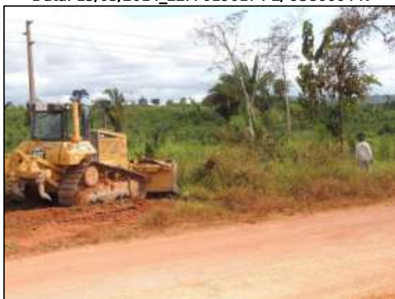
Figura 136. Biólogo vistoriando área, em busca de animais, antes de ocorrer a limpeza no trecho entre Itupiranga e Cajazeiras – Lote 01.
