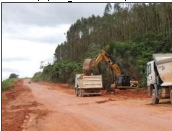
Figura 108. Empréstimo de material, entre Itupiranga e Cajazeiras – Lote 01. Data: 17/04/2014 _ 22M 0670731 E / 9443940 N
