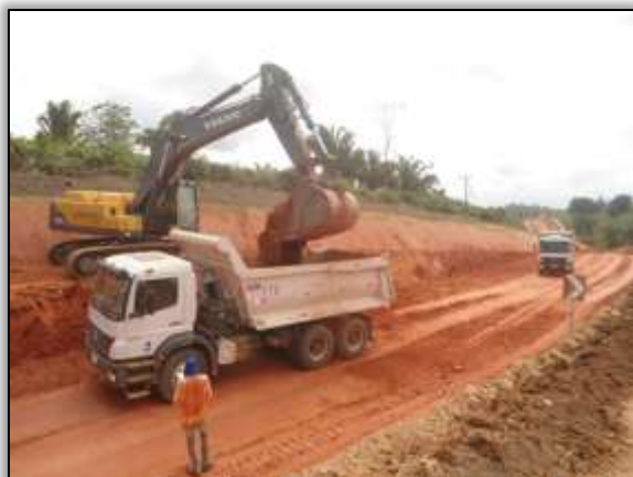
Foto 713 – Corte da rodovia. Lado esquerdo. Estaca 3721. S 03.68355° W 050.93388° 25/06/2014
