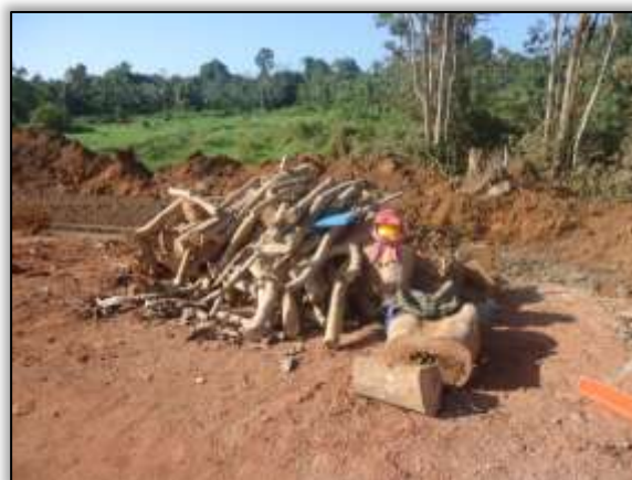
Foto 1649 – Supressão vegetal na faixa de domínio. Lado esquerdo. Estaca 8810. S 03.88955° W 054.28654° 25/07/2014.
