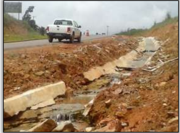
Foto 871 – Erosão em talude e sarjeta danificada. Lado esquerdo. Estaca 2660. S 03. 37794° W 052. 66514° 25/03/2014.
