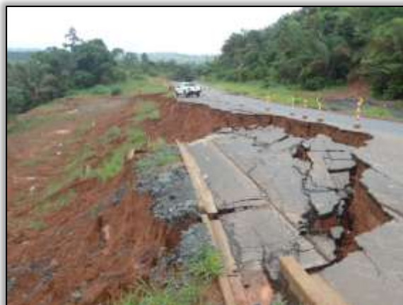
Foto 877 – Processo erosivo na saia do aterro. Lado esquerdo. Estaca 1904. S 03.31088° W 052.54976° 23/03/2014.
