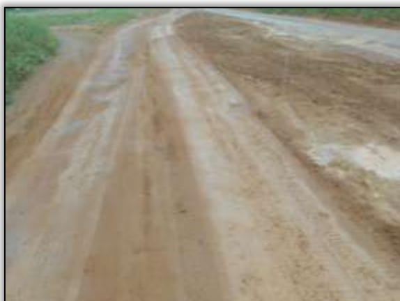
Foto 1199 – Formação de buracos na pista. S 03.65171° W 053.48938° 23/04/2014.
