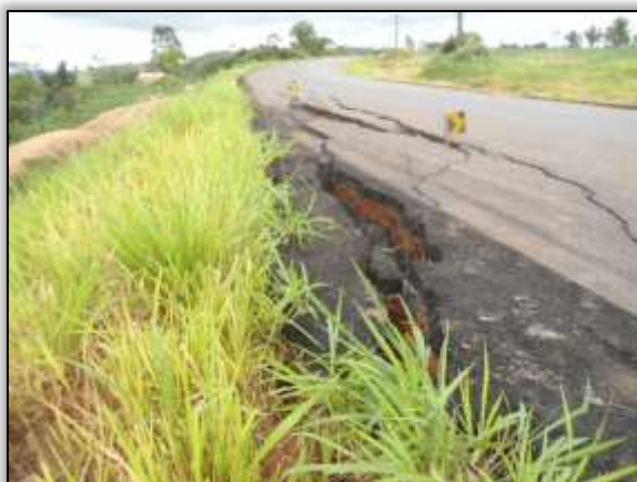
Foto 888– Erosão saída do aterro e pista de rolamento. Lado E. S 03. 36070 W 052. 63250° 15/05/14
