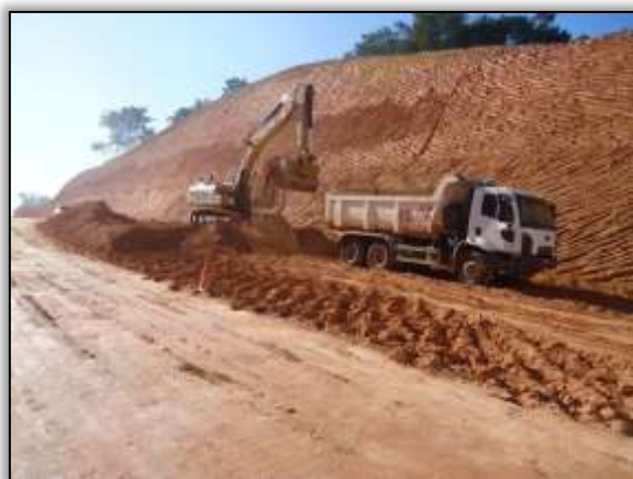
Foto 654 – Corte em corpo estradal. Lado direito. S 04.94901° W 049.46569° 21/07/2014
