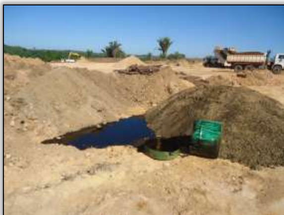
Foto 516 – Vazamento de óleo na jazida. Lado esquerdo. S 05.22094° W 049.34424° 13/06/2014
