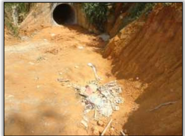
Foto 631 – Resíduos próximos ao córrego. Lado direito. S 05.04689° W 049.45644° 30/06/2014
