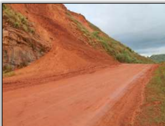
Foto 1190 – Desmoronamento de talude de corte. Lado esquerdo. S 03.85376° W 050.49002° 29/04/2014
