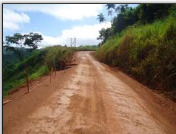
Foto 1219 – Erosão no bordo da rodovia. Lado esquerdo. S 04.06832° W 049.01416° 29/04/2014
