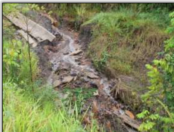
Foto 1330 – Processo erosivo aterro e sarjeta danificada. Lado direito. Estaca 2648. S 03. 37703° W 052. 66367° 17/04/2014.
