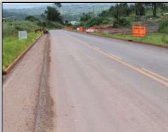
Foto 843- Sinalização antecedendo o desmoronamento. Lado esquerdo e direito. Estaca 1904. S 03.31088° W 052.54976° 14/04/2014.
