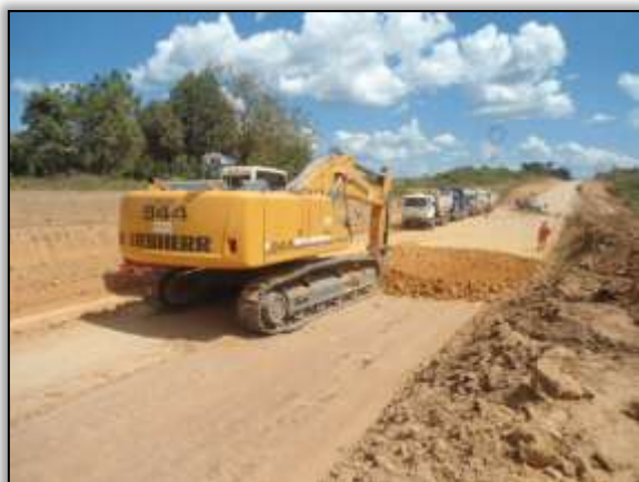
Foto 1040 - Corte na pista de rolamento. Estaca 8605. S 03.88094° W 054.25447° 07/07/2014.
