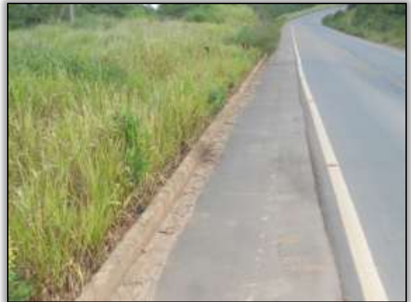
Foto 1352 – (Depois) Pista de rolamento reconformada e plantio com hidrossemeadura na saia de aterro. 05/06/2014
