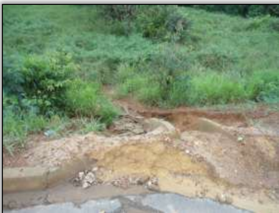
Foto 862 – Processo erosivo na saia do aterro e descida d'água danificada. Lado esquerdo. Estaca 1962. S 03. 31640° W 052. 55971° 25/03/2014.
