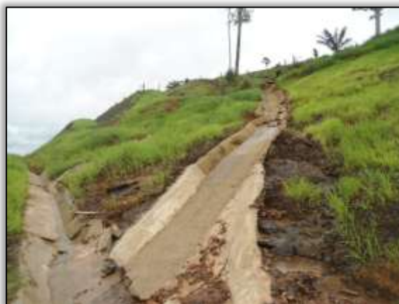
Foto 869 – Erosão e sarjeta danificada. Lado direito. Estaca 2660. S 03. 37794° W 052. 66514° 25/03/2014.
