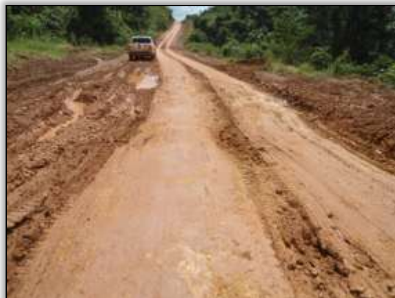
Foto 1154 - Formação de buracos. S 03.49687° W 053.10282°. 26/02/2014.
