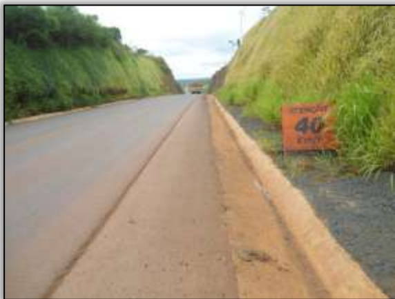
Foto 892. Sinalização insuficiente. Estaca 3700. S 03.44083° W 052.84990° 10/07/2014.
