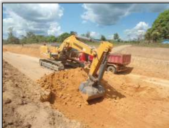
Foto 1041 - Corte na pista de rolamento. Estaca 8605. S 03.88094° W 054.25447° 07/07/2014.
