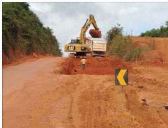
Figura 129. Rebaixamento de pista no trecho entre Itupiranga e Cajazeiras - Lote 01. Data: 08/05/2014_22M 0671466 E / 9445890 N
