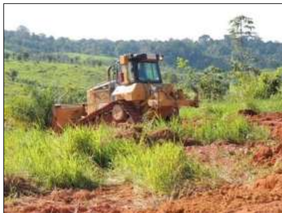
Figura 111. Limpeza da faixa de domínio no trecho entre Itupiranga e Cajazeiras – Lote 01. Data: 22/04/2014 _ 22M 0679417 E / 9429135 N
