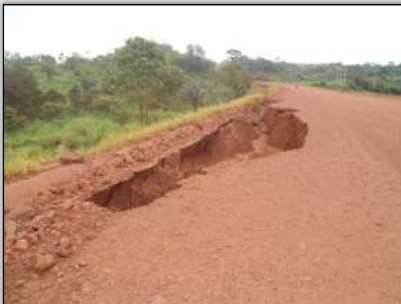
Foto 1146 – Erosão no bordo da pista. Lado esquerdo. Estaca 1024. S 03.85151° W 051.50902° 26/02/2014
