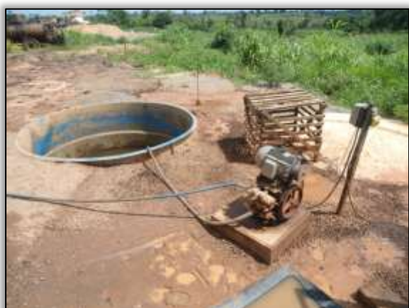
Foto 757 – Bomba sem proteção e caixa d'água descoberta. Lado esquerdo. Estaca 561 S 03.45172° e W 051.21874° 13/12/2013
