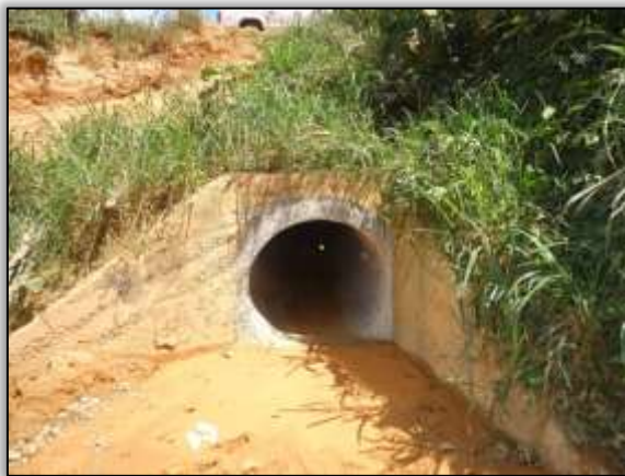
Foto 630 – Reforço em Bueiro. Ambos os lados. S 05.04689° W 049.45644° 30/06/2014
