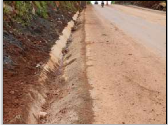
Foto 840 – Sarjeta com deformações causadas pela chuva forte. Lado esquerdo. S 03.44170° W 052.84418° 17/04/2014.
