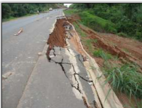
Foto 854 – Processo erosivo na saída do aterro. Lado esquerdo. Estaca 1904. S 03.31088° W 052.54976° 25/02/2014.
