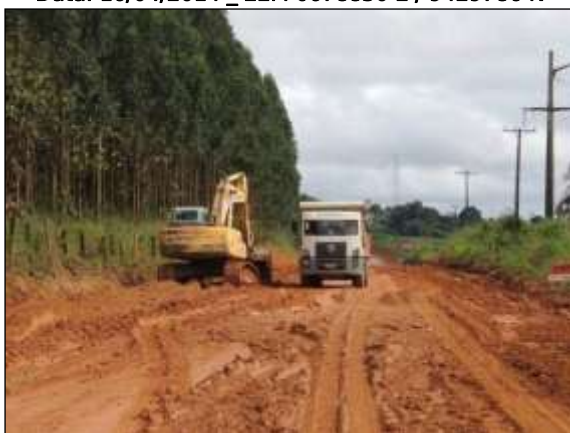
Figura 106. Obra de terraplenagem no trecho entre Marabá e Itupiranga – Lote único. Data: 17/04/2014 _ 22M 0679785 E / 9428566 N
