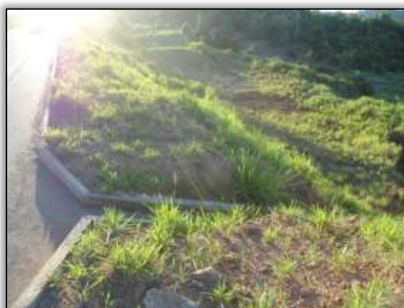
Foto 1364 – (Depois) Reconformação da área, plantio com hidrossemeadura na saída de aterro e construção de descida d'água. 05/06/2014
