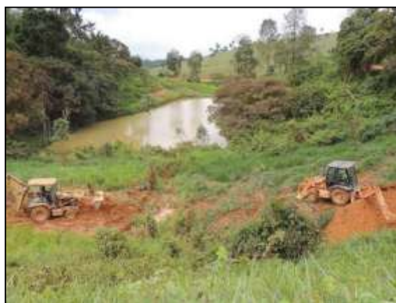
Figura 63. Acompanhamento da construção de escada d'água entre Marabá e Itupiranga – Lote Único. Data: 14/01/2014_22M 0671103 E / 9441920 N
