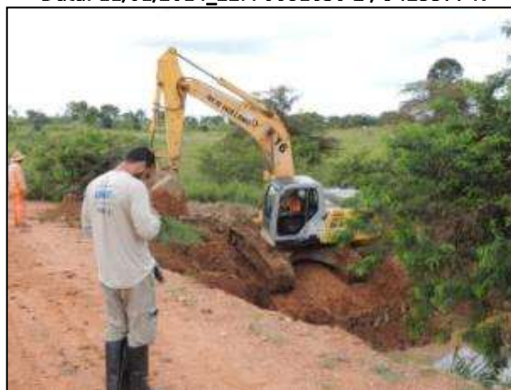
Figura 59. Acompanhamento de construção de escada d'água entre Marabá e Itupiranga – Lote Único. Data: 13/01/2014_22M 0673191 E / 9439839 N
