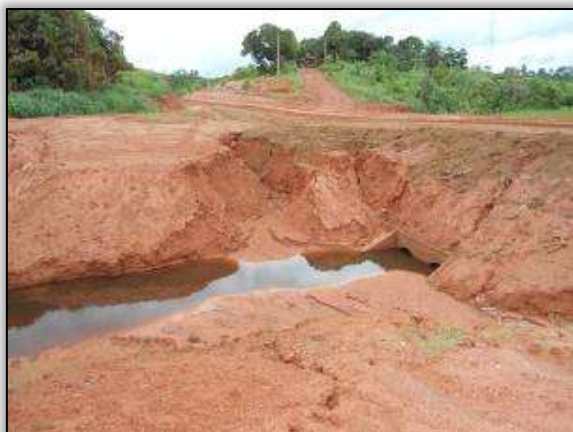
Foto 1355 – (Antes) Processos erosivos faixa de domínio. Lado direito. Estaca 4109. UTM E 420242 N 9653632 09/02/2012
