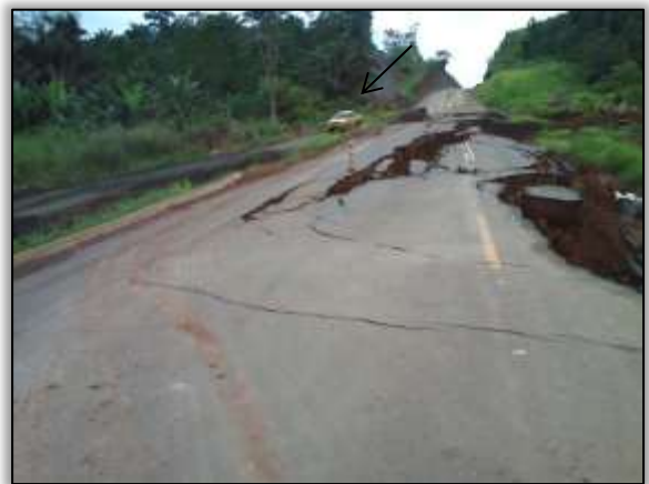
Foto 885 – Processo erosivo na saída do aterro. Lado direito. Estaca 3700. S 03.44083° W 052.83850° 02/04/2014.
