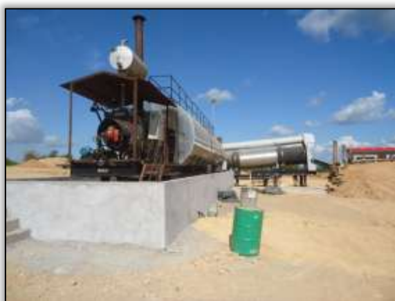
Foto 512 – Usina de asfalto móvel bom base de apoio. Lado esquerdo. S 05.21944° W 049.34484° 03/06/2014
