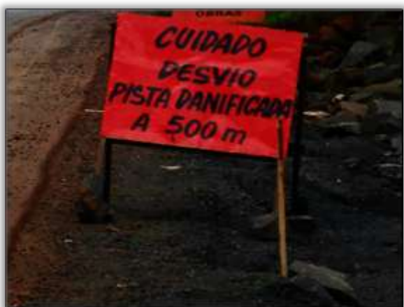
Foto 211 – O DNIT implementou sinalização de alerta para evitar acidentes com a população e transeuntes – 16/04/2014
