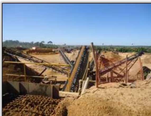
Foto 513 – Separador de agregado instalado. Lado esquerdo. S 05.21944° W 049.34484° 13/06/2014
