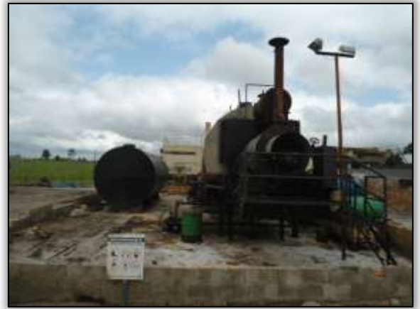
Foto 770 – Usina de asfalto. Lado direito. Estaca 1880. S 03.30814° W 052.54790°
