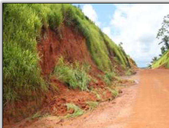
Foto 1189 – Desmoronamento de talude de corte. Lado esquerdo. S 03.57874° W 051.07657° 29/04/2014
