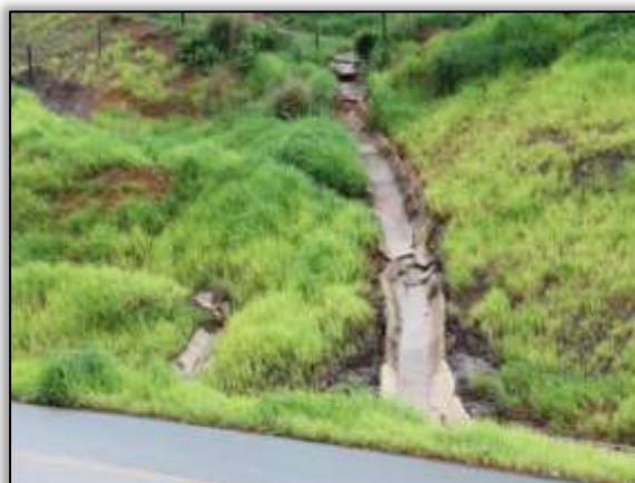
Foto 1333 – Processo erosivo talude de corte e danificação de sarjeta. Lado direito. Estaca 2660. S 03. 37794° W 052. 66514° 17/04/2014.
