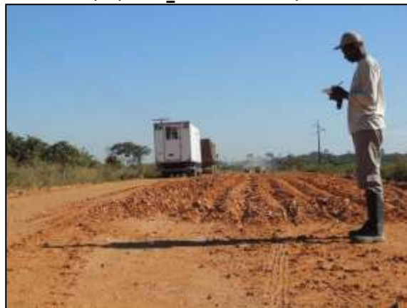
Figura 151. Acompanhamento de obras de terraplenagem no trecho entre Itupiranga e Marabá – Lote Único. Data: 02/06/2014 _22M 0684874 E / 9420258 N
