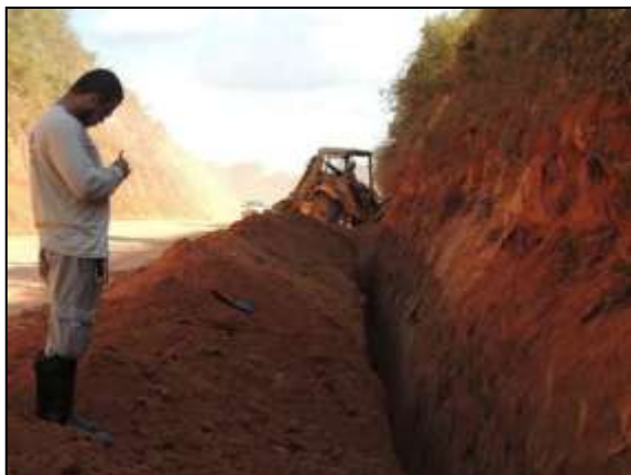
Figura 152. Abertura de vala para locação de dreno, trecho entre Itupiranga e Cajazeiras- Lote 01. Data: 03/06/2014 _22M 0671386 E / 9445754 N
