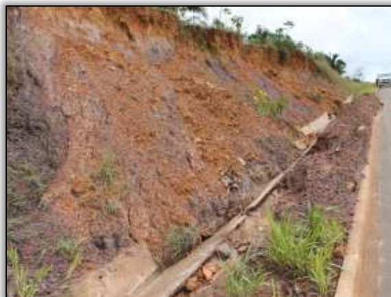
Foto 1337 – Desmoronamento de talude de corte e obstrução de sarjeta. Lado Esquerdo. Estaca 2419. S 03. 35721° W 052. 62742° 17/04/2014.
