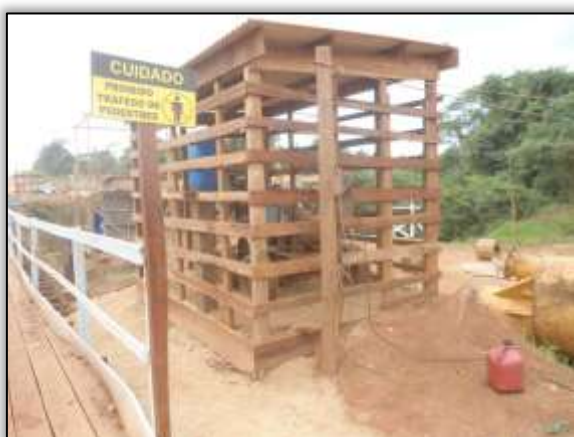
Foto 928 - Sinalização. Estaca 1827. S 03.30872° W 052.53631° 30/07/2014.
