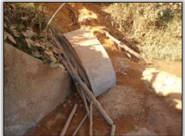
Foto 617 – Deposição irregular de resíduos. Lado direito. S 05.01652° W 049.45953° 03/06/2014
