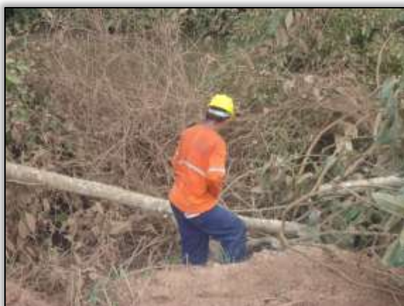
Foto 1648 – Supressão vegetal na faixa de domínio. Lado esquerdo. Estaca 8810. S 03.88955° W 054.28654° 25/07/2014.
