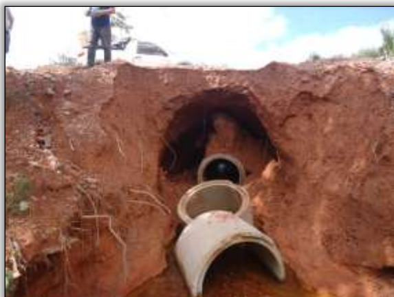
Foto 1214 – Rompimento de bueiro simples tubular de concreto. Lado esquerdo. S 04.21486° W 049.91790° 29/04/2014
