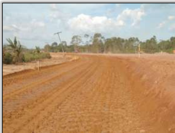
Foto 1128 – Aterro. Lado direito. Estaca 8810. S 03.88936° W 054.28686° 29/07/2014.
