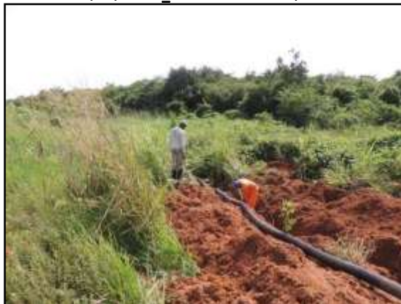
Figura 115. Abertura de canaleta para locação de dreno entre Marabá e Itupiranga – Lote único. Data: 29/04/2014 _ 22M 0684519 E / 9421081 N
