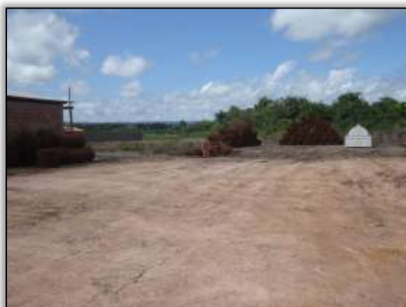
Foto 945 – Área onde está sendo construído o canteiro de obras. Lado esquerdo. S 03.87131° W 054.22242° 10/06/2014.
