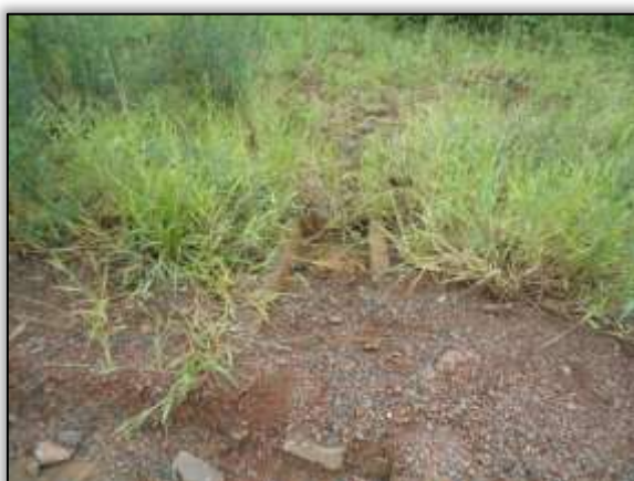
Foto 866 – Descida d'água obstruída. Lado direito. Estaca 2403. S 03. 35568° W 052. 62541° 25/03/2014.
