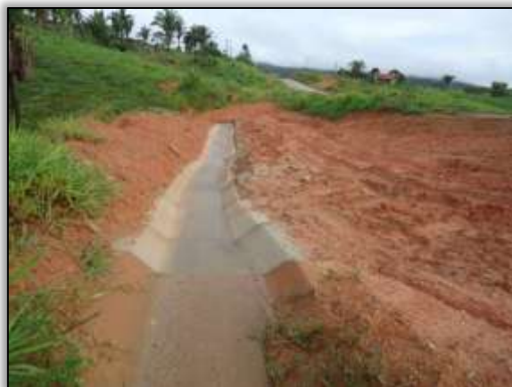
Foto 1317 – Processo erosivo recuperado. Lado esquerdo (depois). S 04.19449º W 050.01511º 24/04/2014
