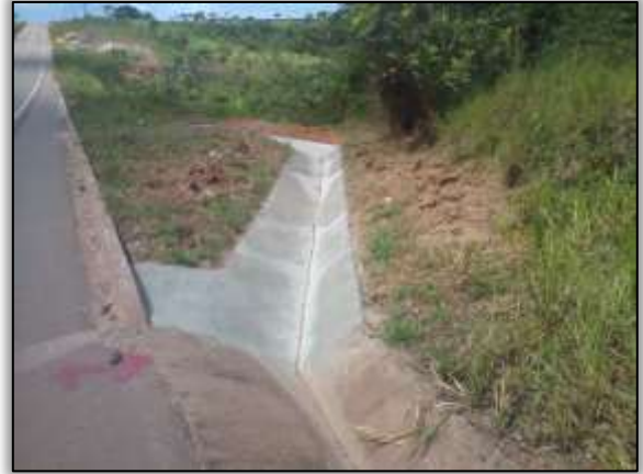
Foto 737 –Reconformação da descida d' água e meio fio danificados.Lado esquerdo. S 03.10419° W 053.90980° 30/07/2014
