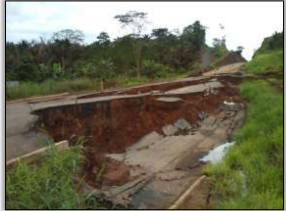
Foto 883 – Processo erosivo na saída do aterro. Lado direito. Estaca 3700. S 03.44083° W 052.83850° 02/04/2014.
