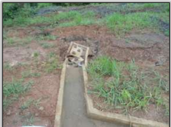
Foto 863 – Processo erosivo na saia do aterro e descida d'água danificada. Lado direito. Estaca 2134. S 03. 33345° W 052. 58400° 25/03/2014.
