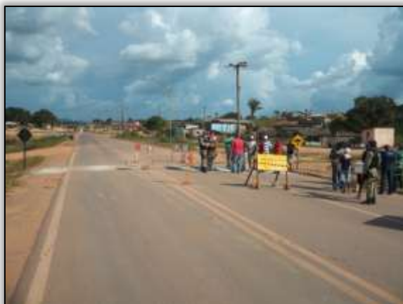
Foto 763 – Construção de lombada rodovia (área urbana de Anapu). Lado Direito e esquerdo. S 03.46050° W 051.20865° 28/03/2014.
