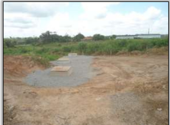
Foto 752 – Caixa separadora de água e óleo pronta. Lado esquerdo. Estaca 561 S 03.45172° e W 051.21874° 24/07/2014
