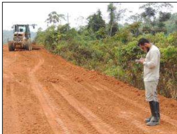
Figura 61. Acompanhamento da terraplenagem entre Itupiranga e Cajazeiras – Lote 01. Data: 13/01/2014_22M 0672428 E / 9440549 N
