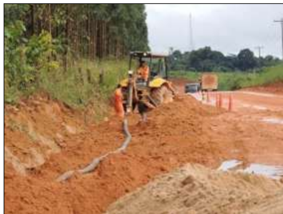
Figura 91. Colocação de dreno no trecho entre Marabá e Itupiranga – Lote único. Data: 11/04/2014 _ 22M 0679777 E / 9428582 N
