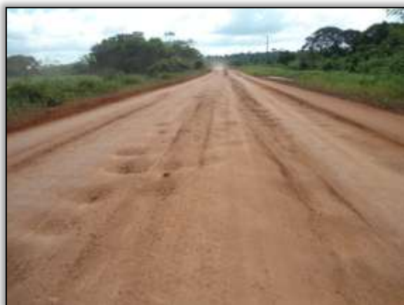
Foto 1161 - Pista esburacada. S 03.67563° W 053.55022°. 26/02/2014.
