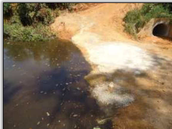
Foto 633 – Derramamento de óleo em corpo hídrico. Lado direito. S 05.04689° W 049.45644° 30/06/2014
