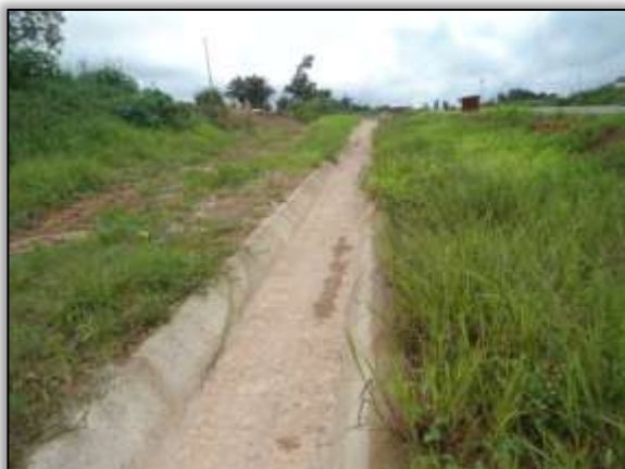
Foto 1273 – Valeta concluída e crescimento de gramíneas. Lado direito. Estaca 1891. S 03.30983° W 052.54798° 25/02/2014.
