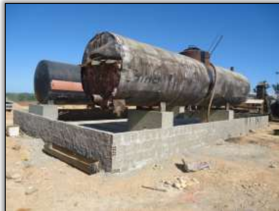
Foto 515 – Tanque de emulsão suspenso e com caixa de contenção. Lado esquerdo. S 05.22108° W 049.34438° 13/06/2014
