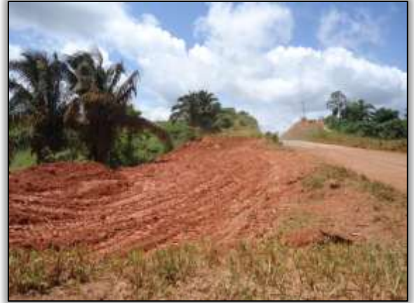
Foto 1323 – Recuperação do processo erosivo em 29/05/2013. Lado esquerdo. S 04.02377° W 049.28563°
