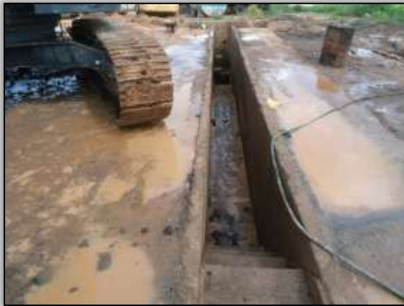
Foto 749 –Resíduos no lava a jato. Lado esquerdo. Estaca 561 S 03.45172° e W 051.21874° 13/12/2013
