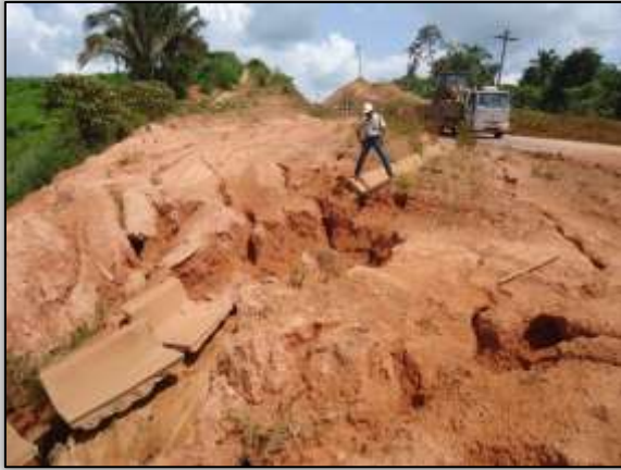
Foto 1322 – Rompimento de dreno em 12/12/2013. Lado esquerdo. S 04.02377° W 049.28563°
