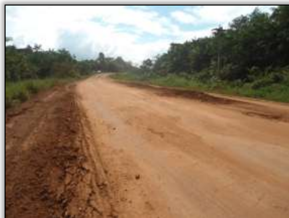
Foto 1160 - Formação de buracos na pista. S 03.67508° W 053.53600°. 26/02/2014.
