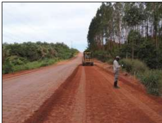
Figura 141. Acompanhamento de obra de terraplenagem no trecho entre Marabá e Itupiranga – Lote único. Data: 22/05/2014 _22M 0686055 E / 9418185 N
