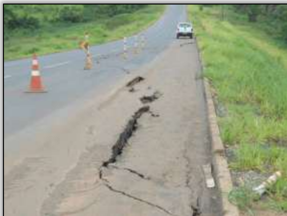
Foto 886– Erosão saída do aterro e pista de rolamento. Lado direito. S 03.29980° W 052.499.69° 15/05/14
