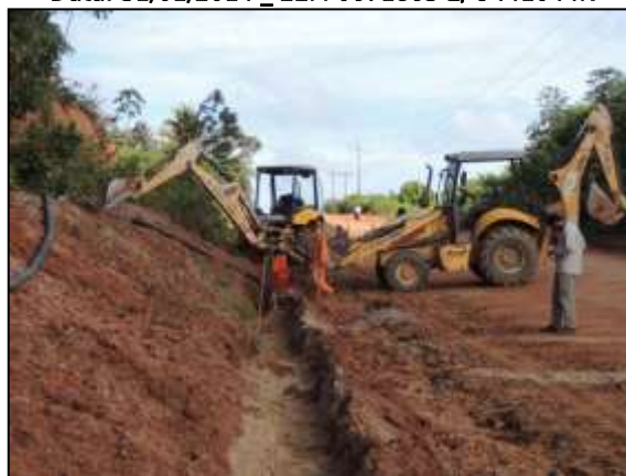
Figura 77. Acompanhamento de abertura de vala para locação de dreno entre Itupiranga e Cajazeiras – Lote 01.
