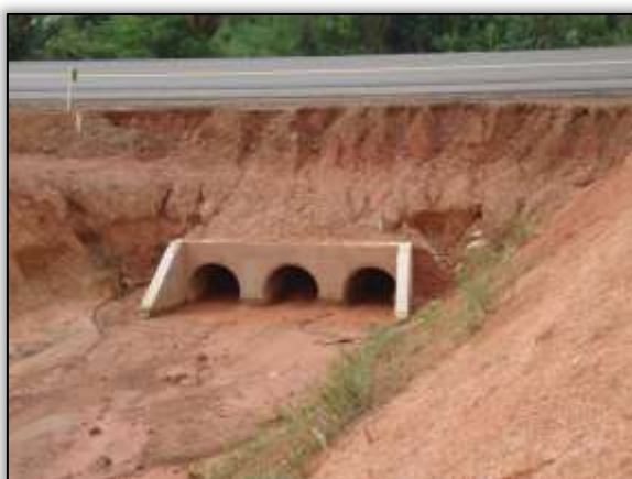
Foto 1301 – Bueiro obstruído 12/12/2013. Lado direito. S 04.19449° W 050.01511°
