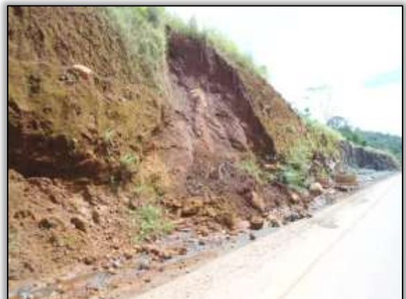
Foto 875 – Desmoronamento de talude. Lado esquerdo. Estaca 3428. S 03. 44230° W 052. 84491° 26/03/2014.
