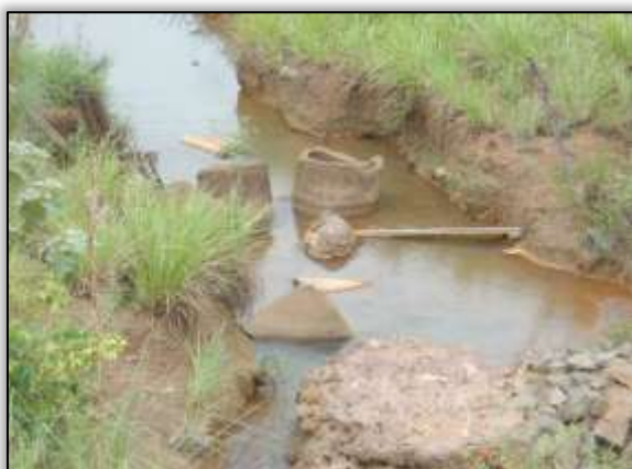
Foto 890– Bueiro de concreto dentro de corpo hídrico Lado esquerdo. S 03. 34192° W 052. 59692° 15/05/2014.
