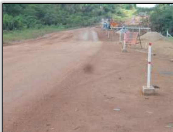
Foto 919 – Sinalização Horizontal. Lado esquerdo. S 03.31975° W 052.56762° 11/06/2014.
