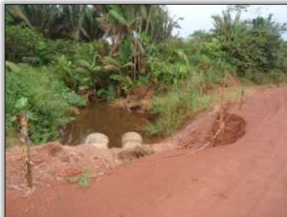
Foto 1164 - Processo erosivo por rompimento de bueiro. Lado esquerdo. S 04.05071° W 049.80114° 27/02/2014
