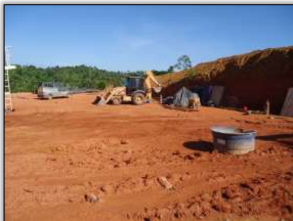
Foto 573 – Material para instalação do britador. Lado direito. S 04.90479° W 049.47627° 04/06/2014
