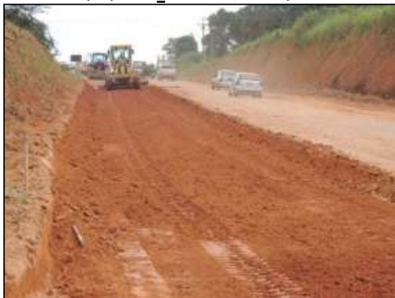
Figura 126. Terraplanagem no trecho entre Marabá e Itupiranga – Lote único. Data: 07/05/2014 _ 22M 0678667 E / 9429741N
