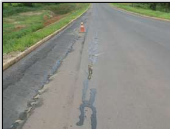
Foto 817 – Rachaduras no asfalto. Lado esquerdo. Estaca 1612. S 03.29984° W 052.49980° 18/02/2014.
