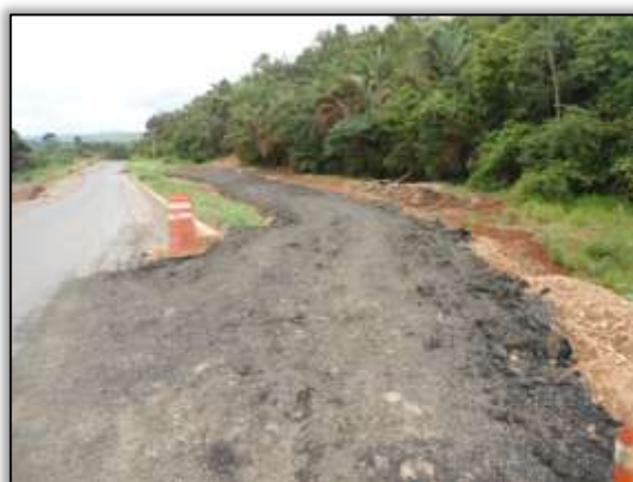
Foto 857 - Desvio na pista. Lado direito. Estaca 1904. S 03.31088° W 052.54976° 25/02/2014
