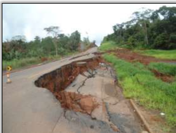
Foto 880 – Processo erosivo na saia do aterro. Lado esquerdo. Estaca 3700. S 03.44083° W 052.83850° 23/03/2014.
