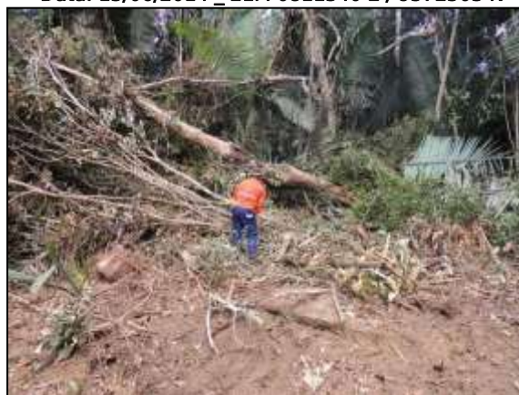
Figura 167. Supressão vegetal em via de acesso à pedreira, próximo a Placas – Lote 02. Data: 16/06/2014 _ 21M 0813640 E / 9579030 N
