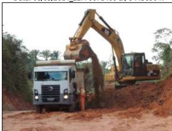
Figura 131. Rebaixamento da pista no trecho entre Itupiranga e Cajazeiras - Lote 01. Data: 09/05/2014_22M 0671310 E / 9445634N
