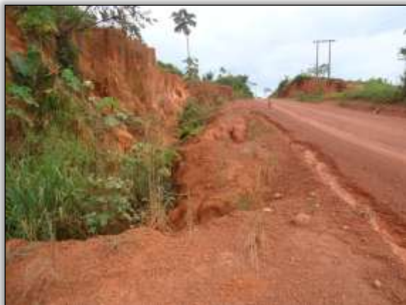
Foto 1165 – Desbarrancamento de talude. Lado esquerdo. S 04.02952° W 049.79452° 27/02/2014
