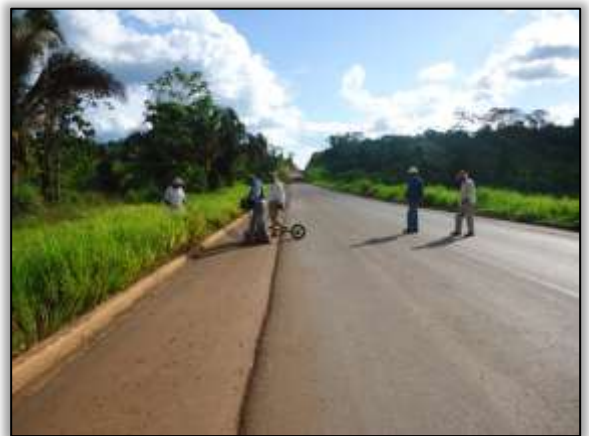
Foto 903. Estudos geotécnicos - processos erosivos no corpo estradal. Lado esquerdo e direito. S 03.44075° W 052.84987° 18/07/2014.
