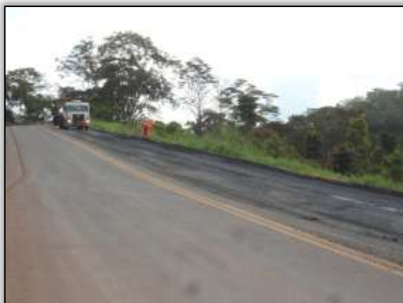
Foto 828 – Recuperação asfáltica. Lado esquerdo. Estaca 2396. S 03.35458° W 052.62405° 23/03/2014.
