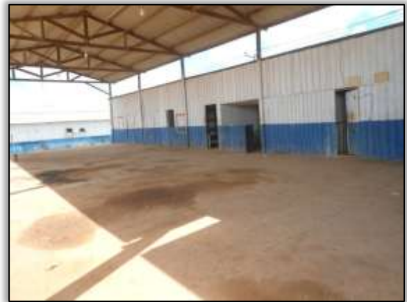
Foto 780. Canteiro de obras- mancha de óleo no chão da oficina. Lado esquerdo. Estaca 1827. S 03.30872° W 052.53631° 10/07/2014.
