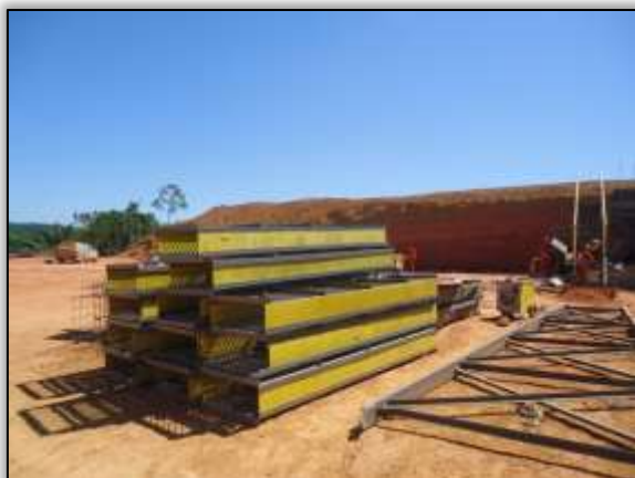
Foto 575 – Material para instalação do britador. Lado direito. S 04.90479° W 049.47627° 01/07/2014
