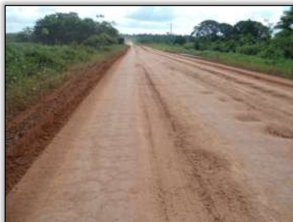
Foto 1162 - Pista esburacada. S 03.67563° W 053.55022°. 26/02/2014.
