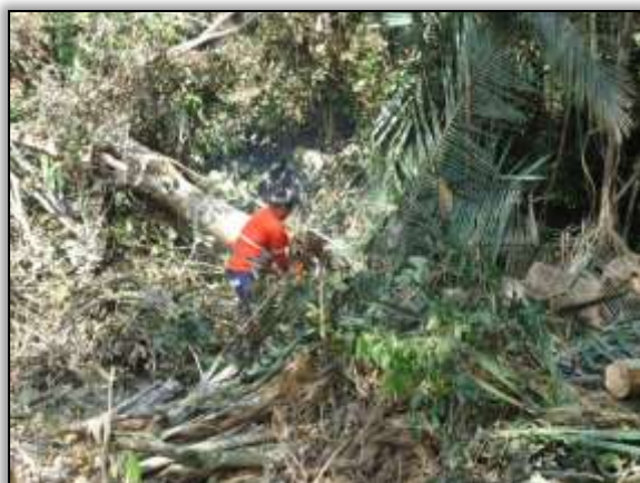
Foto 1454 - Supressão no acesso da pedreira. Lado direito. S 03.80608° W 054.18146° 16/06/2014.
