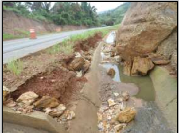
Foto 859 – Processo erosivo no talude de corte. Lado direito. Estaca 3554. S 03. 43131° W 052. 81432° 25/03/2014.
