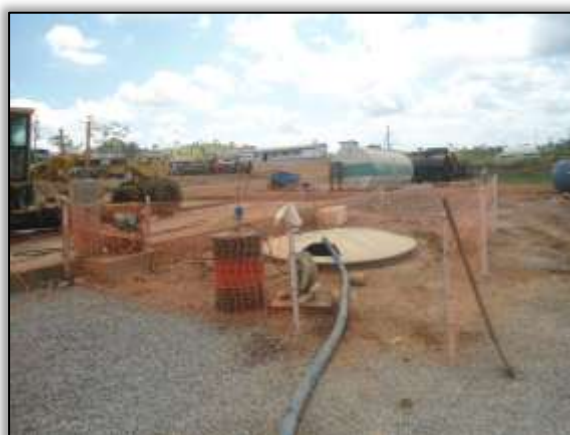
Foto 758 – Bomba sem proteção e caixa d'água descoberta. Lado esquerdo. Estaca 561 S 03.45172° e W 051.21874° 30/07/2014
