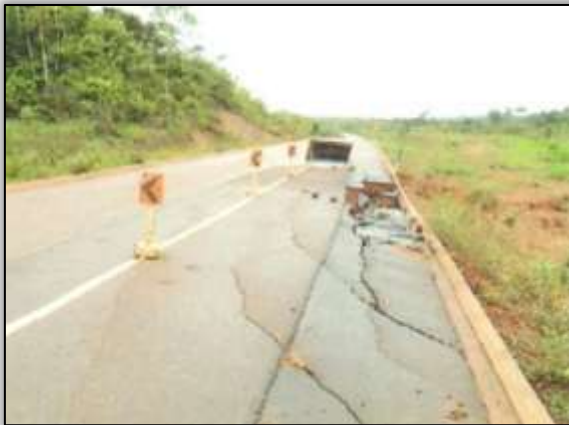
Foto 1351 – (Antes) Processos erosivos na pista de rolamento. Lado esquerdo. Estaca 6060. UTM E 387698 N 9649724 09/02/2012
