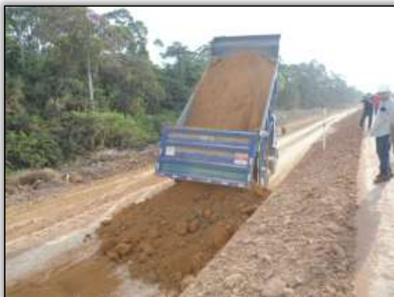
Foto 1129 – Aterro. Lado direito. Estaca 8810. S 03.88936° W 054.28686° 29/07/2014.
