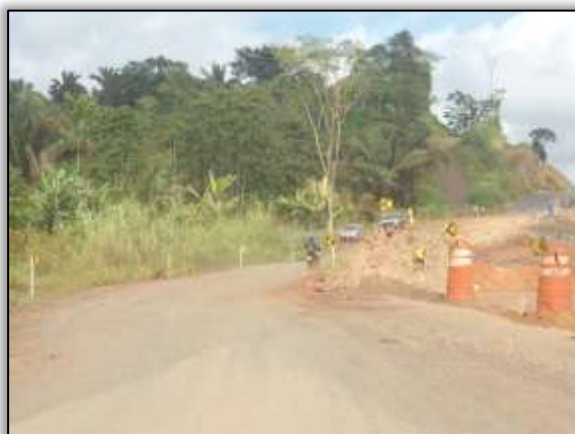
Foto 898. Sinalização com delineadores e placas refletivas- Dnit. Estaca 3700. S 03.44083° W 052.84990° 31/07/2014.
