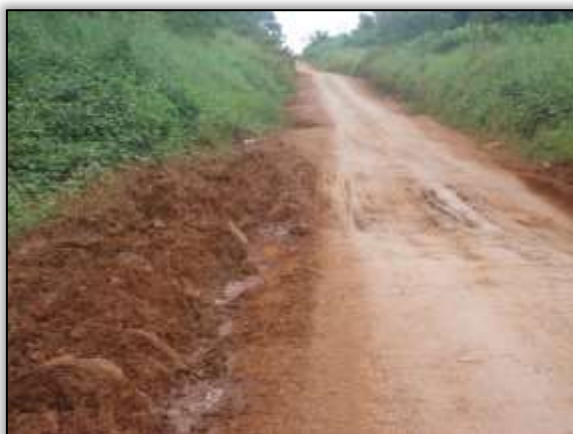
Foto 1206 – Buraco na pista. S 03.48146° W 052.95593° 07/05/2014.
