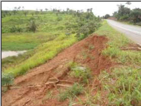
Foto 860 – Processo erosivo na saia do aterro e descida d'água danificada. Lado direito. Estaca 1935. S 03. 31384° W 052. 55559° 25/03/2014.
