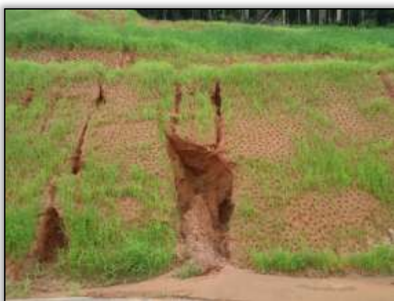
Foto 693 – Desbarrancamento de talude. Lado esquerdo. S 04.05558º W 050.24564º 18/02/2014
