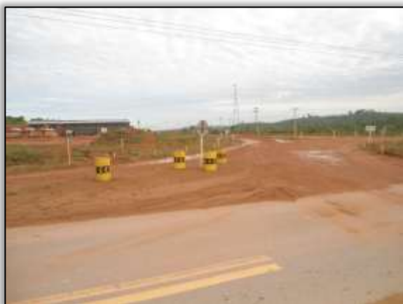
Foto 477. Acesso ao canteiro Bela Vista – Canais e Diques. Lado esquerdo. Estaca 4258. S 03.12479° W 051.73776° 02/06/2014
