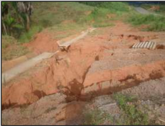
Foto 687 – Rompimento de dreno/aterro de bota fora solto. Lado esquerdo. S 03.94136º W 050.30764º 18/02/2014
