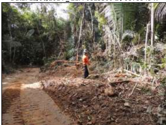
Figura 166. Supressão e enleiramento na via de acesso à pedreira, próximo a Placas – Lote 02. Data: 16/06/2014 _ 21M 0813258 E / 9578745 N
