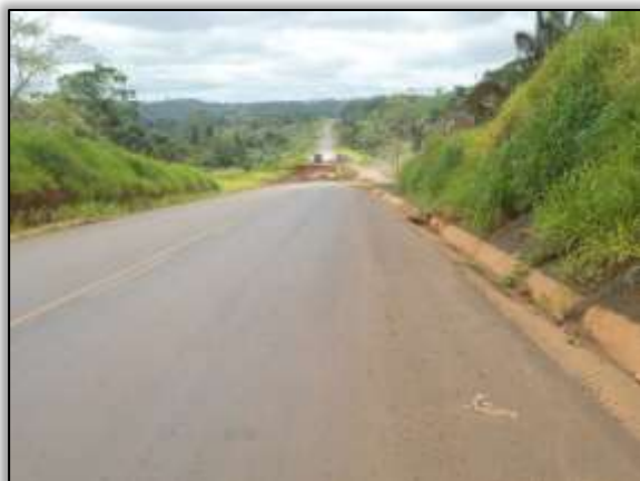
Foto 894. Sinalização insuficiente. Estaca 3700. S 03.44083° W 052.84990° 10/07/2014.
