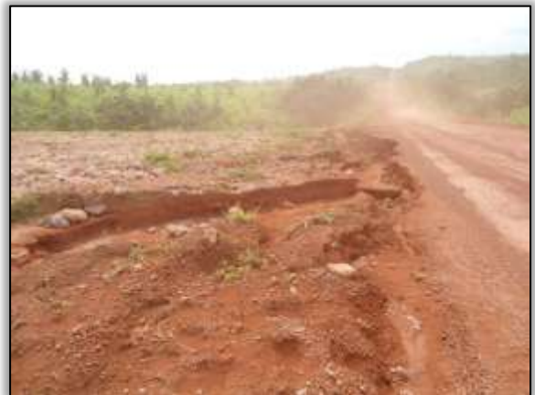
Foto 1147 – Processo erosivo no bordo da pista. Lado esquerdo. Estaca 1270. S 03.84714° W 050.54906° 26/02/2014
