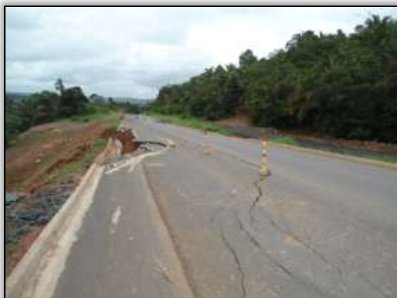
Foto 876 – Processo erosivo na saia do aterro. Lado esquerdo. Estaca 1904. S 03.31088° W 052.54976° 25/02/2014.
