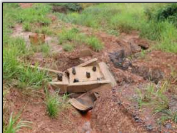
Foto 1328 – Processo erosivo na saída do aterro e descida d'água danificada. Lado direito. Estaca 2134. S 03. 33345° W 052. 58400° 17/04/2014.
