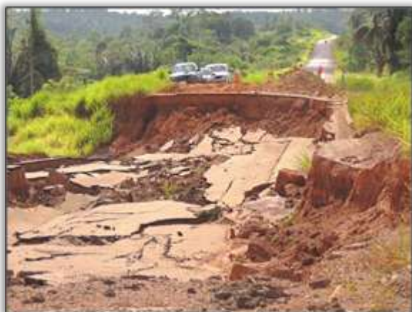
Foto 425 – Trecho onde ocorreu deslizamento situado no km 85 rodovia BR-230/PA. Medicilândia/PA, 17/07/2014.
