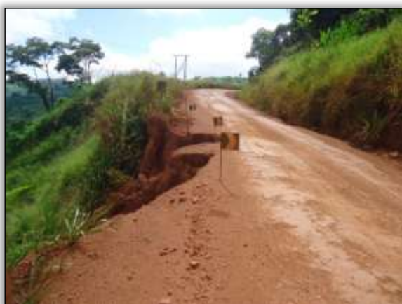
Foto 1218 – Erosão no bordo da rodovia. Lado esquerdo. S 04.06832° W 049.01416° 29/04/2014
