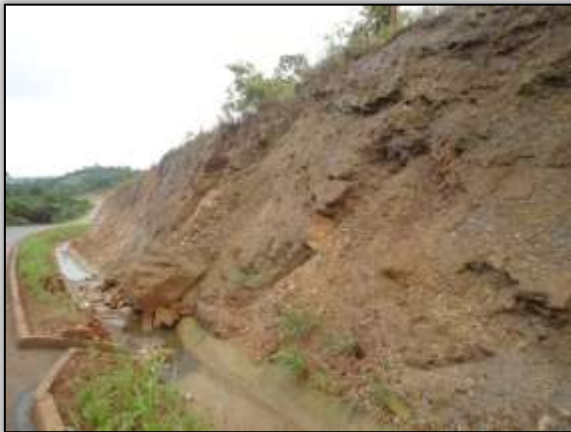
Foto 858 – Desmoronamento de talude de corte e sistema de drenagem danificado. Lado direito. Estaca 1923. S 03. 31327° W 052. 55287° 25/03/2014.
