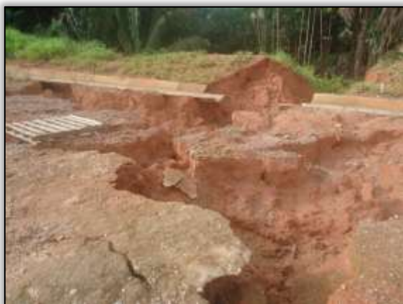
Foto 1318 – Rompimento de dreno/aterro de bota fora solto. Lado esquerdo (antes). S 03.94136º W 050.30764º 18/02/2014
