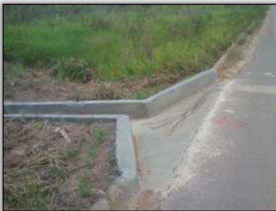
Foto 738 –Reconformação da descida d' água e meio fio danificados.Lado esquerdo. S 03.15491° W 053.98684° 30/07/2014
