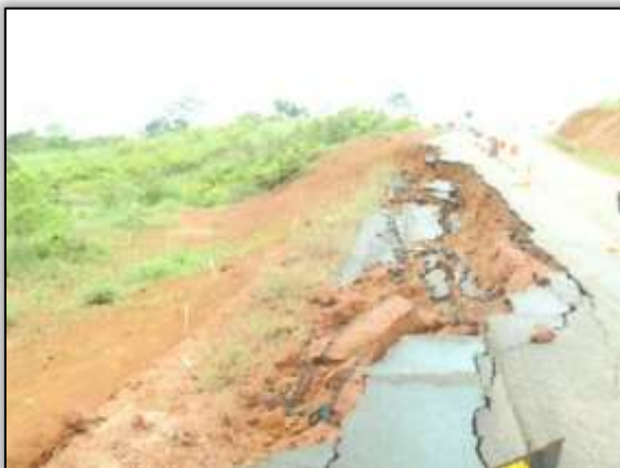
Foto 1353 – (Antes) Processos erosivos na pista de rolamento. Lado esquerdo. Estaca 6071. UTM E 387533 N 9649629 09/02/2012
