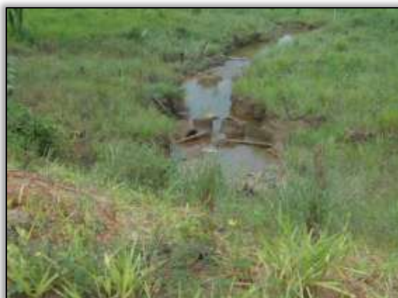
Foto 891– Bueiro de concreto dentro de corpo hídrico Lado esquerdo. S 03. 34192° W 052. 59692° 15/05/2014.
