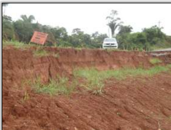
Foto 878 – Processo erosivo na saia do aterro. Lado esquerdo (sentido contrário da rodovia). Estaca 1904. S 03.31088° W 052.54976° 23/03/2014.
