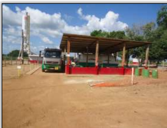
Foto 498 – Ponto de abastecimento. S 05.24769° W 049.35731° 30/06/2014
