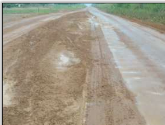
Foto 1200 – Formação de buracos na pista. S 03.65171° W 053.48938° 23/04/2014.
