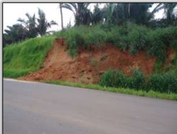
Foto 692 – Desbarrancamento de talude. Lado direito. S 04.04263º W 050.29497º 18/02/2014
