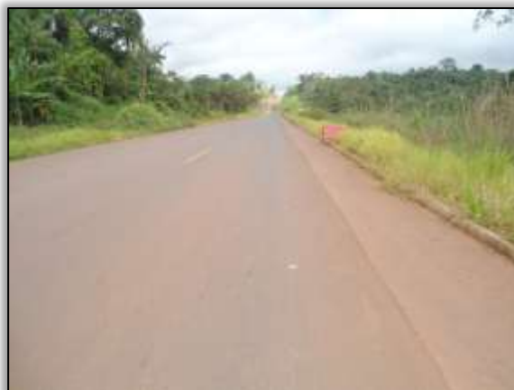
Foto 895. Sinalização insuficiente. Estaca 3700. S 03.44083° W 052.84990° 10/07/2014.
