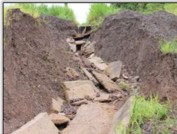
Foto 1329 – Processo erosivo aterro e sarjeta danificada. Lado direito. Estaca 2648. S 03. 37703° W 052. 66367° 17/04/2014.
