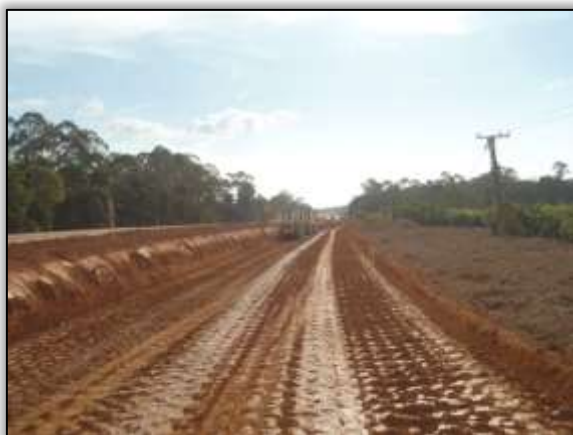
Foto 1127 – Aterro. Lado direito. Estaca 8810. S 03.88936° W 054.28686° 29/07/2014.
