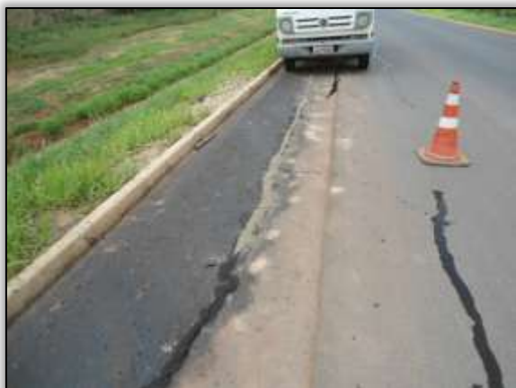
Foto 816 – Rachaduras no asfalto. Lado esquerdo. Estaca 1612. S 03.29984° W 052.49980° 18/02/2014.
