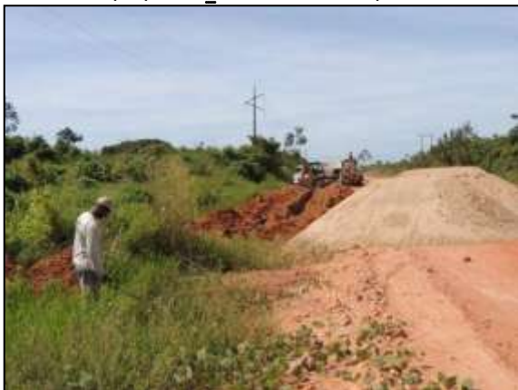
Figura 114. Acompanhamento de abertura de canaleta para locação de dreno entre Marabá e Itupiranga – Lote único. Data: 29/04/2014 _ 22M 0684519 E / 9421081 N
