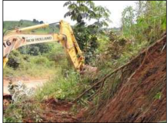
Figura 181. Limpeza de talude, trecho entre Marabá e Itupiranga – Lote Único Data: 12/04/2014 _ 22M 0678654 E / 9430025 N
