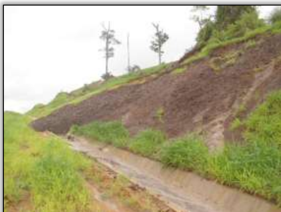
Foto 868 – Desmoronamento de talude e obstrução de sarjeta. Lado direito. Estaca 2660. S 03. 37794° W 052. 66514° 25/03/2014.
