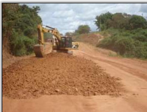
Foto 594 – Corte no corpo estradal da rodovia. S 05.05076° W 049.45440° 13/03/2014
