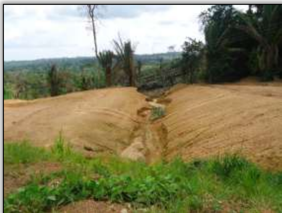
Foto 1320 – Processo erosivo em aterro em 12/12/2013. Lado esquerdo. S 03.93081º W 050.33004º
