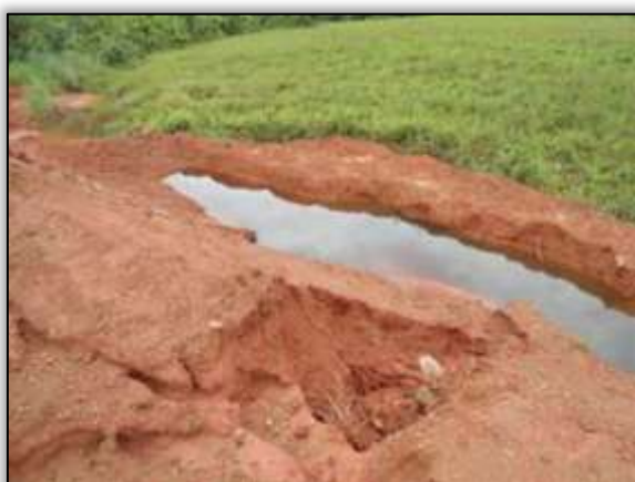
Foto 1357 – (Antes) Processo erosivo na saída do aterro. Lado esquerdo. Estaca 4109. UTM E 420242 N 9653632 09/02/2012
