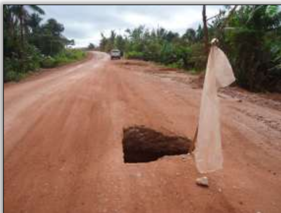
Foto 1212 – Erosão no eixo da rodovia. S 04.21486° W 049.91790° 29/04/2014
