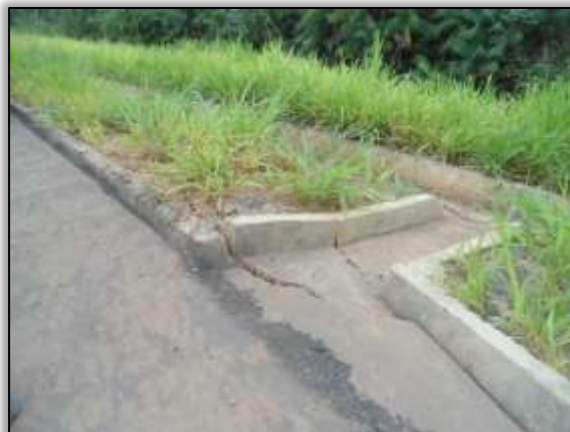
Foto 887– Erosão na saída do aterro e danificação de sarjeta. Lado direito. S 03.29980° W 052.499.69° 15/05/14
