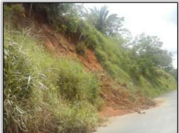
Foto 873 – Desmoronamento de talude para pista de rolamento. Lado esquerdo. Estaca 1294. S 03. 28305° W 052. 45607° 25/03/2014.
