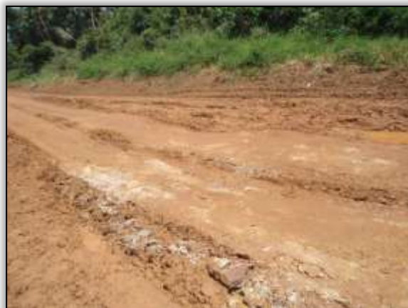
Foto 1156 - Formação de buracos. S 03.49687° W 053.10282°. 26/02/2014.
