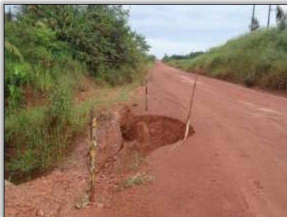
Foto 1163 - Processo erosivo. Lado esquerdo. S 04.05479° W 049.80360° 27/02/2014
