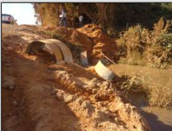
Foto 618 – Deposição irregular de resíduos. Lado direito. S 05.01652° W 049.45953° 03/06/2014
