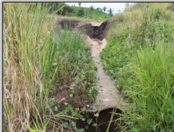
Foto 1335 – Erosão no aterro e danificação de sarjeta. Lado Esquerdo. Estaca 2683. S 03. 38001° W 052. 66970° 17/04/2014.
