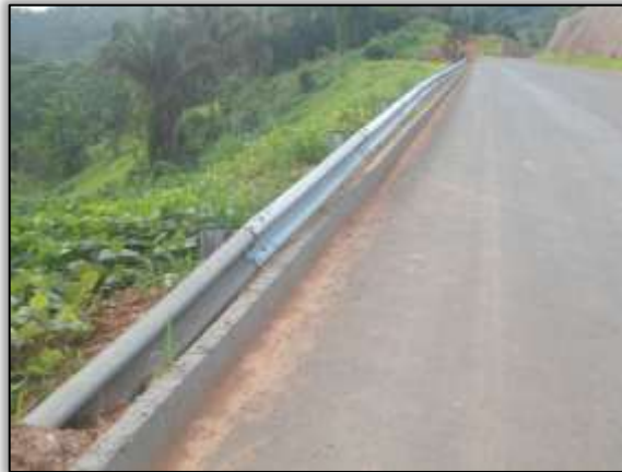
Foto 1272 – Defesa metálica. Lado esquerdo. Estaca 4725. S 03.57708° W 051.07824° 26/02/2014
