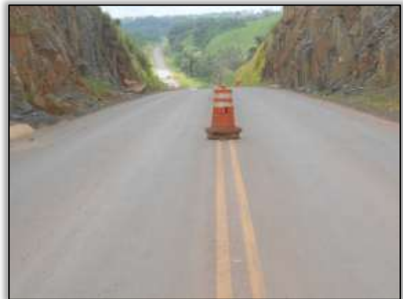
Foto 893. Sinalização insuficiente. Estaca 3700. S 03.44083° W 052.84990° 10/07/2014.
