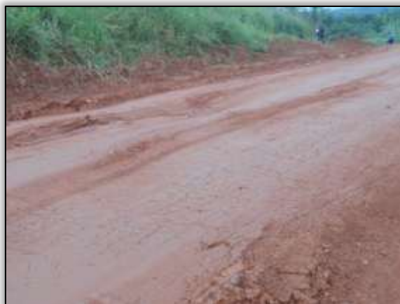
Foto 1172 – Formação de buracos. S 03.50167° W 053.01052° 19/03/2014.
