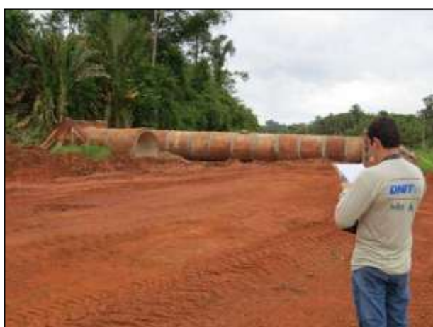
Figura 442. Obras de execução de bueiro tubular entre as cidades de Placas e Rurópolis – Lote 03.
