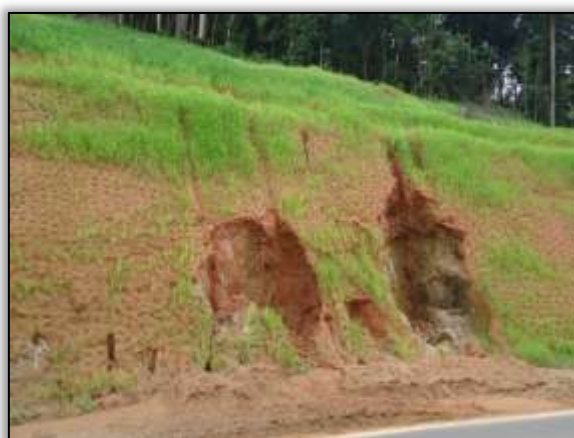
Foto 694 – Desbarrancamento de talude. Lado direito. S 04.05558º W 050.24564º 18/02/2014
