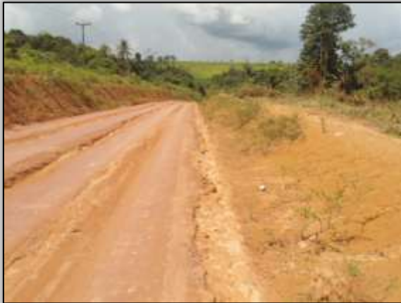
Foto 1191 – Formação de valas na pista. S 03.68723° W 053.58799° 15/04/2014.
