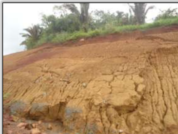
Foto 853 – Processo erosivo no talude de corte. Lado esquerdo. Estaca 3554. S 03. 43131° W 052. 81432° 26/02/2014.
