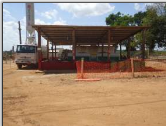
Foto 504 – Posto de combustível do canteiro. S 05.14410° W 049.35730° 29/07/2014
