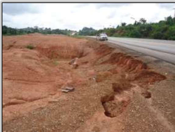
Foto 1299 – Processo erosivo em aterro 12/12/2013. Lado direito. S 04.19449° W 050.01511°
