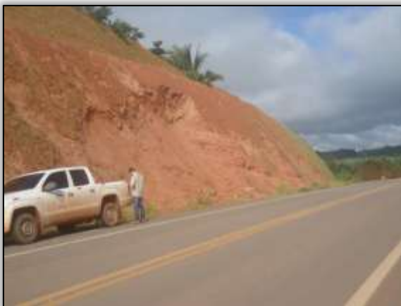
Foto 689 – Desbarrancamento de talude. Lado esquerdo. S 03.94304º W 050.30402º 18/02/2014
