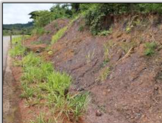
Foto 1339 – Desmoronamento de talude e obstrução de bueiro. Lado esquerdo. staca 2104. S 03. 32859° W 052. 58040° 17/04/2014.
