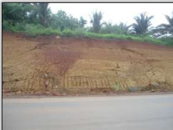
Foto 852 – Processo erosivo no talude de corte. Lado esquerdo. Estaca 3554. S 03. 43131° W 052. 81432° 26/02/2014.
