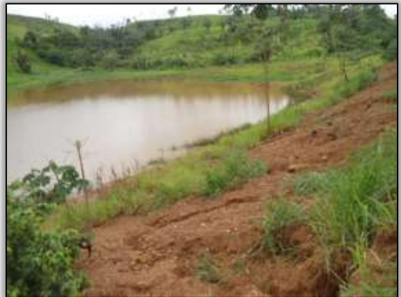
Foto 861 – Processo erosivo na saia do aterro e descida d'água danificada. Lado esquerdo. Estaca 1945. S 03. 31388° W 052. 55585° 25/03/2014.
