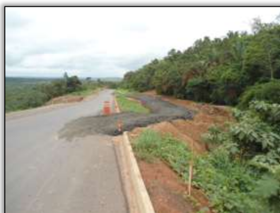
Foto 856 - Desvio na pista. Lado direito. Estaca 1904. S 03.31088° W 052.54976° 25/02/2014
