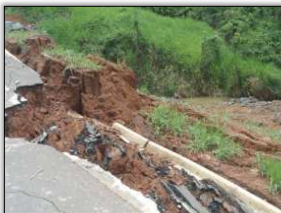
Foto 855 – Processo erosivo na saída do aterro. Lado esquerdo. Estaca 1904. S 03.31088° W 052.54976° 25/02/2014.
