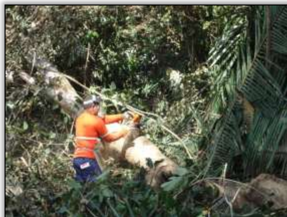
Foto 1455 - Supressão no acesso da pedreira. Lado direito. S 03.80608° W 054.18146° 16/06/2014.
