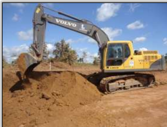
Foto 1027 - Corte em talude. Lado esquerdo Estaca 8620. S 03.88208° W 054.25644° 10/06/2014.
