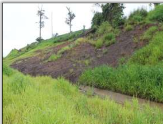
Foto 1332 – Processo erosivo talude de corte e obstrução de sarjeta. Lado direito. Estaca 2660. S 03. 37794° W 052. 66514° 17/04/2014.
