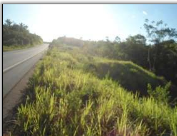
Foto 1358 – (Depois) Reconformação da área, plantio com hidrossemeadura e condução da revegetação natural. 05/06/2014
