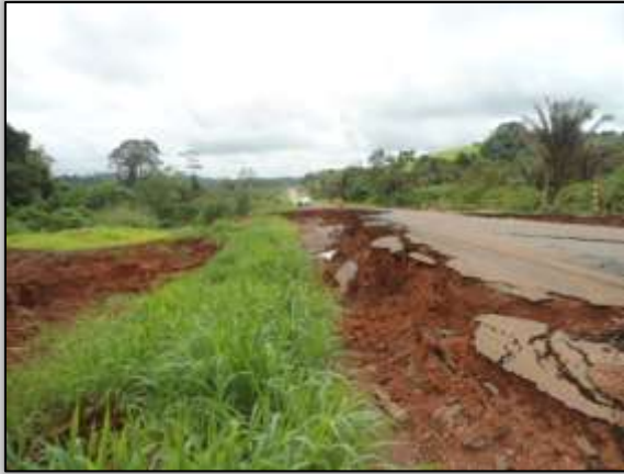
Foto 882 – Processo erosivo na saída do aterro. Lado esquerdo. Estaca 3700. S 03.44083° W 052.83850° 23/03/2014.
