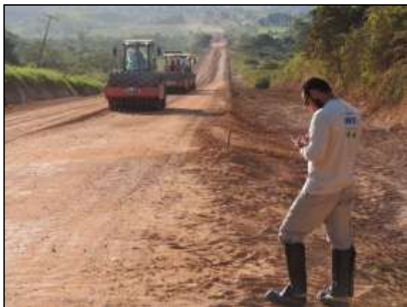
Figura 158. Equipe acompanhando obra de terraplenagem no trecho entre Marabá e Itupiranga – Lote Único.
