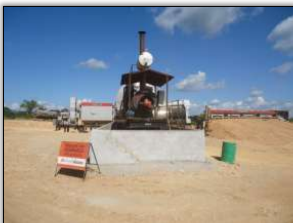
Foto 511 – Usina de asfalto móvel com base de apoio. Lado esquerdo. S 05.21944° W 049.34484° 03/06/2014
