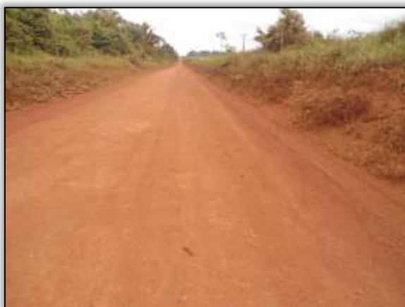
Foto 1228 – Pista em boas condições. S 03. 60797° W 053. 28453° 01/07/2014
