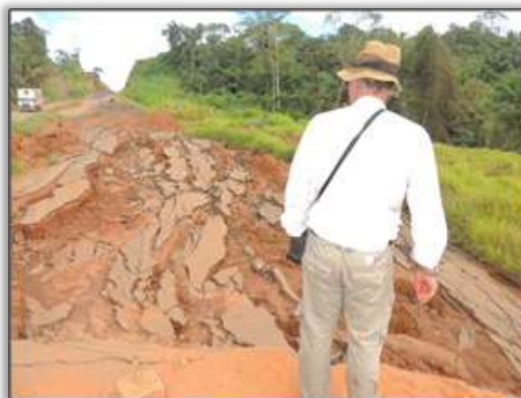
Foto 426 – Trecho onde ocorreu deslizamento situado no km 85 rodovia BR-230/PA. Medicilândia/PA, 17/07/2014.
