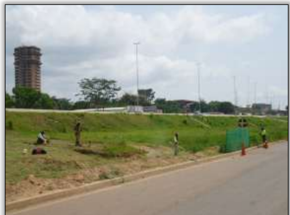
Foto 6 - Roço em talude. S 05.35081° W 049.10607° 28/10/2013
