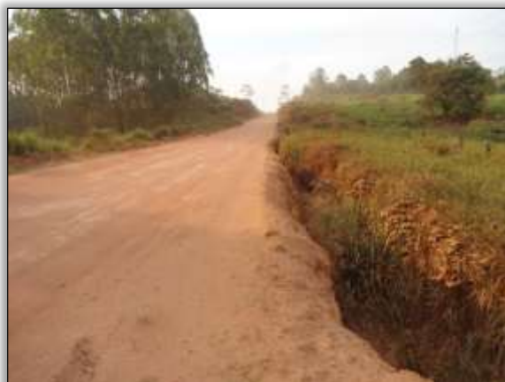
Foto 8 – Processo erosivo. Lado Direito. S 05.17236° W 049.28852°. 12/11/2013
