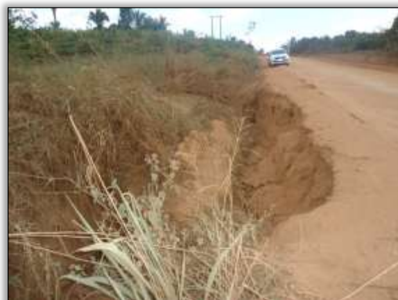
Foto 6 – Processo erosivo avançando para a pista de rolamento. Lado direito. S 05.22189° W 049.34289° 17/09/2013
