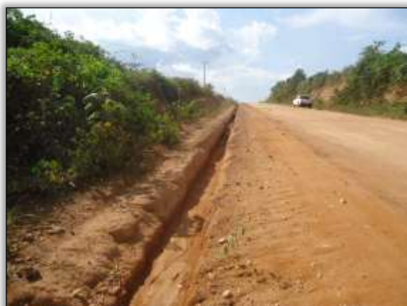
Foto 5– Processo erosivo por rompimento de dreno subterrâneo. Lado esquerdo. S 05.22129° W 049.34314° 16/10/2013
