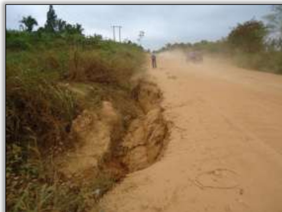
Foto 4 – Processo erosivo avançando para a pista de rolamento. Lado direito. S 05.15259° W 049.38886° 17/09/2013
