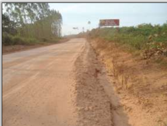
Foto 7 – Processo erosivo. Lado Direito, S 05.27222° W 049.21853°. 12/11/2013
