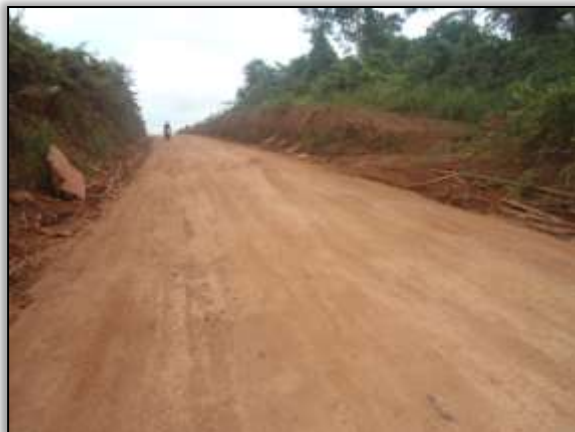
Foto 40 - Buracos em declive. S 03.49606° W 053.09583°. 28/11/2013.
