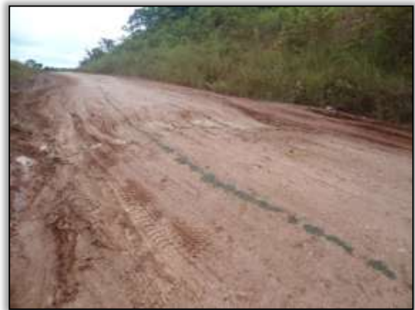
Foto 55 - Buracos na pista. S 03.50261° W 053.07058° 29/01/2014
