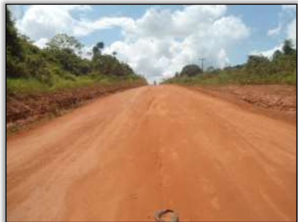
Foto 48 - Buracos em declive. S 03.63302° W 053.43375°. 27/12/2013.
