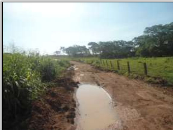
Foto 85 - Caminho de serviço desativado. Lado esquerdo. Estaca 8751 S 03.89072° W 054.27675°. 26/11/2013.
