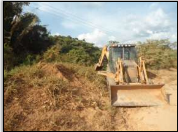
Foto 26 – Limpeza de descida d'água. Lado direito. Trecho Medicilândia/ Uruará. S 03.70489° W 053.67689°. 27/09/2013.
