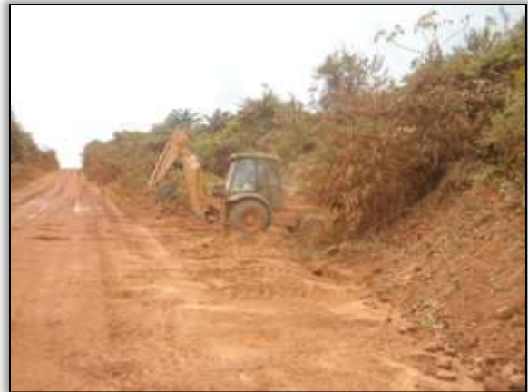
Foto 20 – Limpeza de descida d'água. Lado esquerdo. Trecho Placas/ Rurópolis. S 03.91629° W 054.55464°. 20/09/2013.
