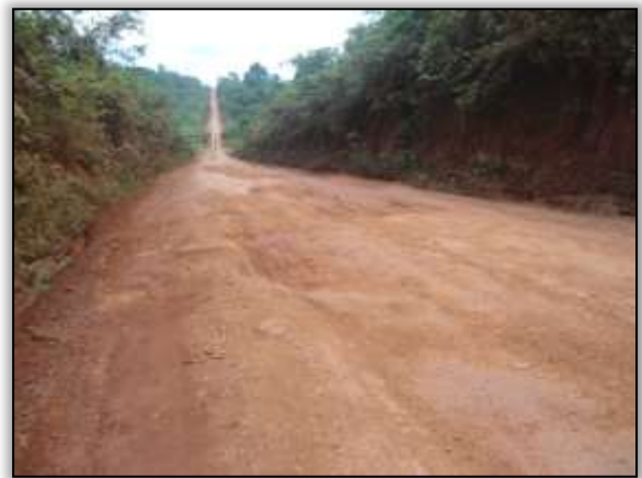
Foto 37 - Buracos em declive. S 03.49546° W 052.98211° . 19/11/2013.
