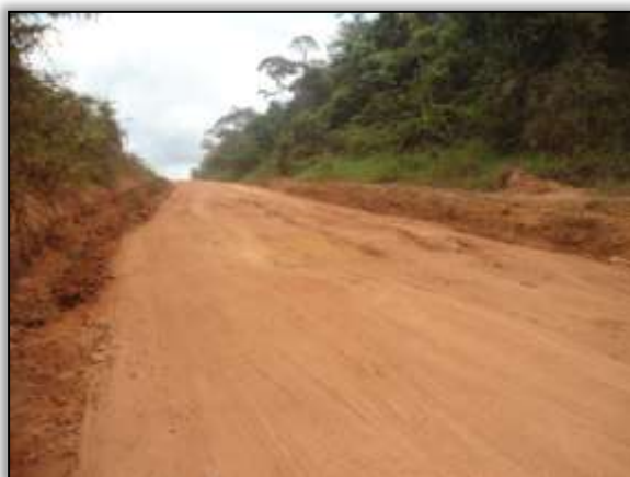
Foto 42 - Buracos em declive. S 03.56712° W 053.20827°. 28/11/2013.
