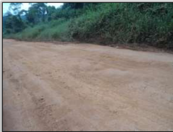
Foto 36 - Buracos em declive. S 03.48482° W 052.95997° . 19/11/2013.
