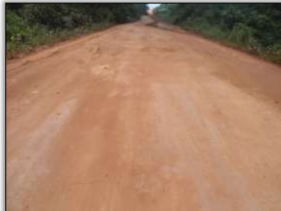
Foto 49 - Buracos na pista. S 03.63379° W 053.43819°. 27/12/2013.
