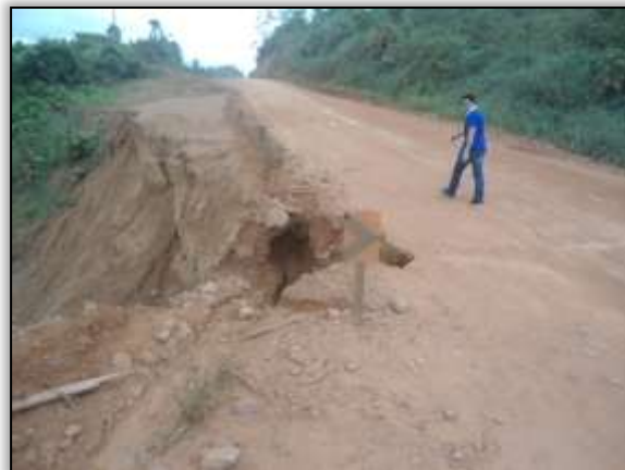
Foto 41 - Erosão invadindo a pista. Lado direito. S 03.50088° W 053.11529°. 28/11/2013.
