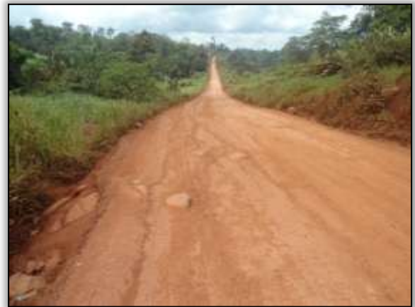
Foto 39 - Buracos em declive com aflocação rochosa. S 03.50313° . W 053.01603° . 19/11/2013.
