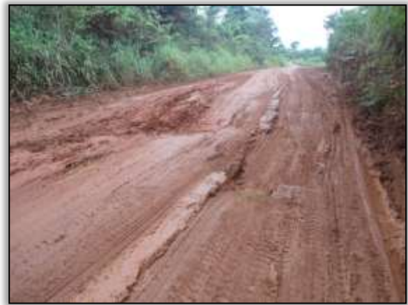
Foto 53 - Buracos na pista. S 03.50149° W 053.00661° 29/01/2014
