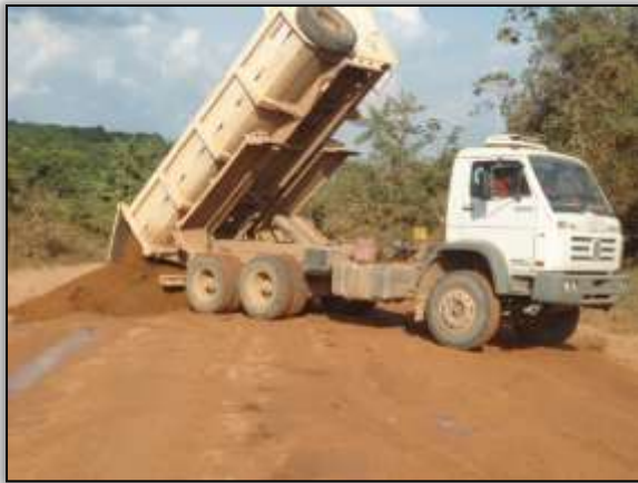
Foto 25 – Conservação da rodovia. Trecho Medicilândia/ Uruará. S 03.70601° W 053.69453°. 27/09/2013
