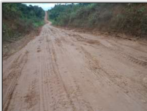
Foto 56 - Buracos na pista. S 03.49649° W 053.10155° 29/01/2014
