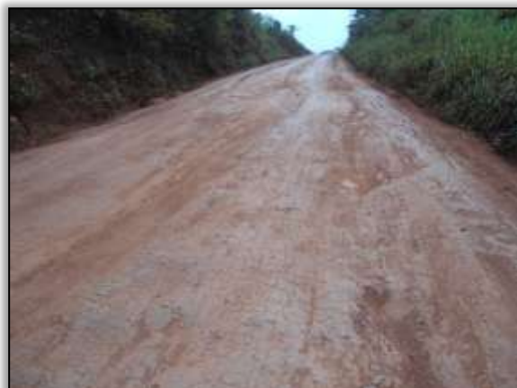
Foto 4 - Formação de vala em declive. Trecho Medicilândia / Uruará. S 03.50317° W 053.01620°. 21/08/2013.
