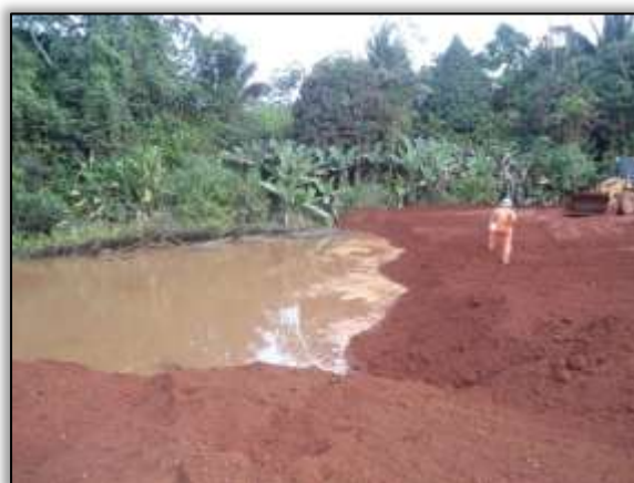
Foto 18 - Aterro de área alagada no período de inverno. Lado direito. Estaca 3255. S 03.40780° W 52. 76634° 20/08/2013.
