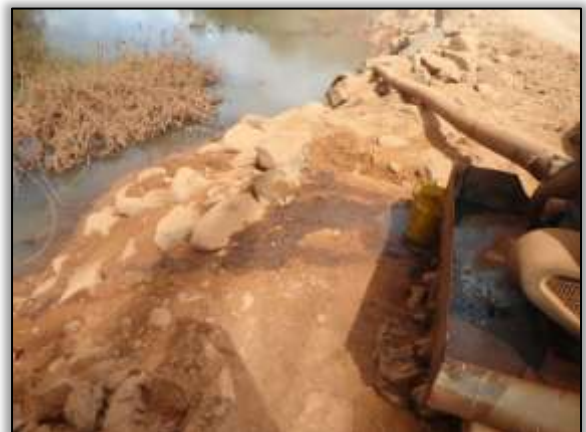
Foto 6 - Vazamento de óleo na bomba de captação de água. Lado esquerdo. S 03. 39049° W 052. 71481° 14/08/2013
