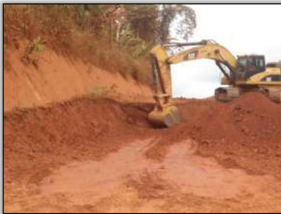
Foto 9 - Corte na pista de rolamento. Estaca 3289. S 03. 40957° W 052. 77177° 14/08/2013
