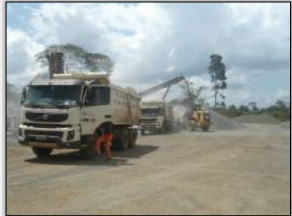
Foto 133 – Britador Sanches Tripoloni. Lado direito. Estaca 3775. S 03.44206° W 052.85213° 17/12/2013.
