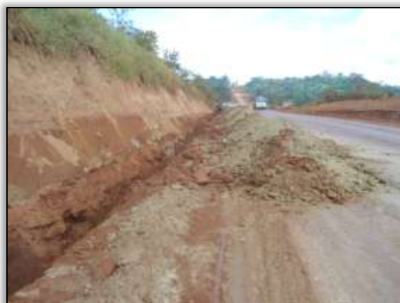
Foto 14 - Sistema de drenagem profunda. Estaca 3669. Lado esquerdo. S 03. 43908° W 052. 83287° 14/08/2013
