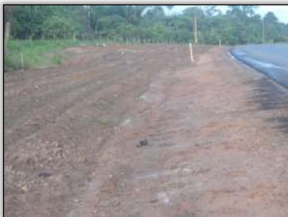
Foto 172 - Hidrossemeadura realizada em caminho de serviço. Lado direito. Estaca 1657. S 03. 30209° W 052 50866° 21/01/2014
