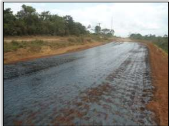
Foto 75 - Camada de piche na pista. Estaca 2458. S 03.36099° W 052.63317°. 10/10/2013.
