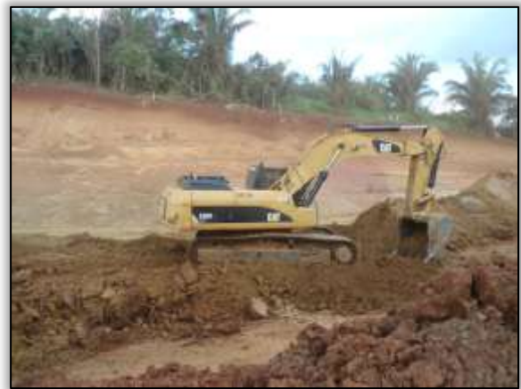
Foto 51 – Corte na pista de rolamento. Lado esquerdo. Estaca 3547. S 03. 43161° W 052. 81446° 10/09/2013.
