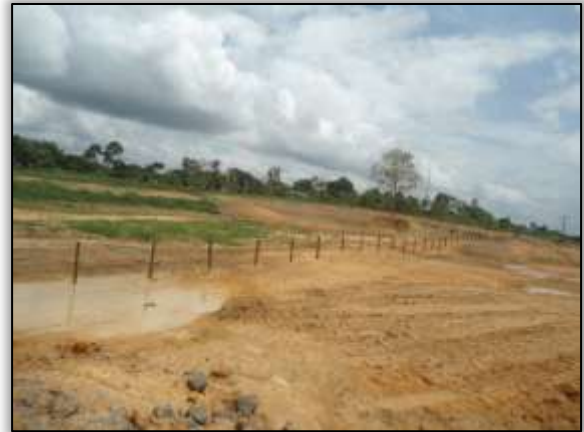
Foto 169 - Jazida explorada na faixa de domínio em fase de recuperação. Lado direito. Estaca 2463. S 03.36076° W 052.63377° 23/01/2014
