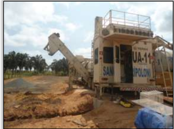
Foto 37 – Usina de asfalto. Estaca 1880. Lado direito. S 03. 30814° W 052. 54790° 27/09/2013.
