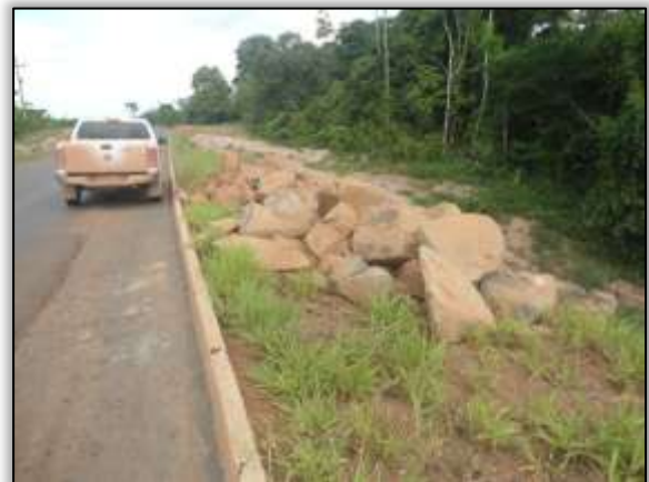
Foto 143 – Material rochoso na faixa de domínio. Lado esquerdo. S 03.39429° W 052.72554° 17/12/2013.
