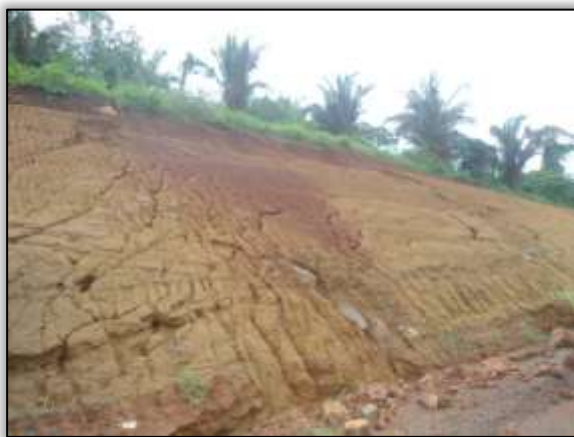
Foto 178 - Processo erosivo no talude de corte. Lado esquerdo. Estaca 3554. S 03. 43131° W 052. 81432° 28/01/2014
