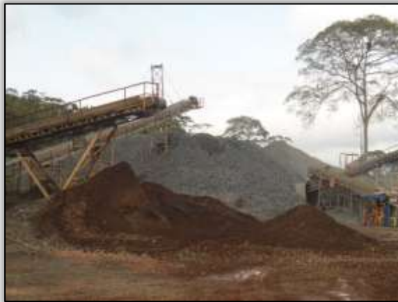
Foto 100 – Britador Sanches Tripoloni. Lado direito. Estaca 3775. S 03.44206° W 052.85213° 14/11/2013.
