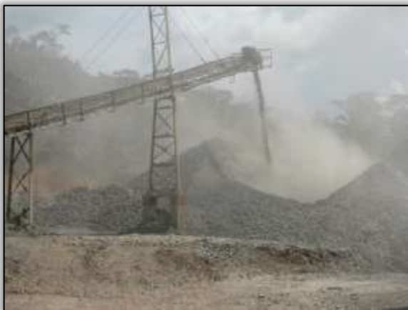
Foto 29– Britador Sanches Tripoloni. Lado direito. Estaca 3775. S 03.44206° W 052. 85213°. 20/08/2013.
