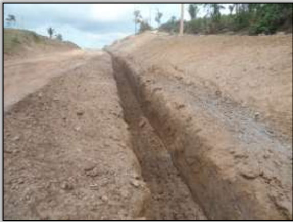
Foto 76 - Drenagem profunda. Lado direito. Estaca 2653. S 03.37715° W 052.66383°. 10/010/2013
