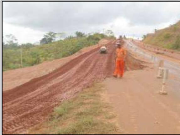
Foto 55 – Reconformação da rodovia e da saia de aterro (Gabião). Lado esquerdo. S 03.16962° W 052.01243° 12/11/2013
