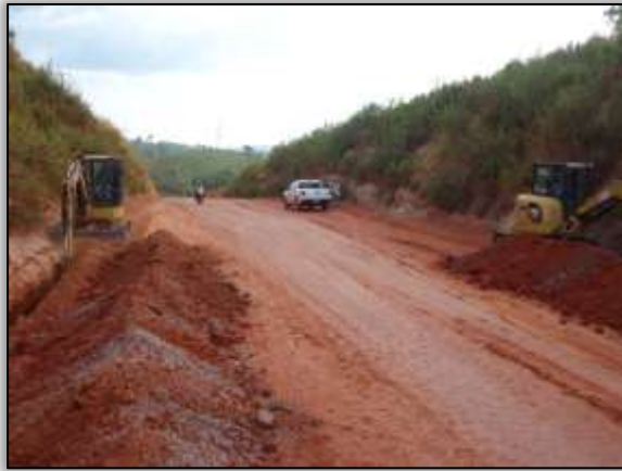
Foto 13 – Dreno profundo. Lado direito/esquerdo. Estaca 4065. S 03.13222° W 051.71058° 29/08/2013.
