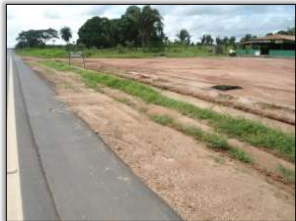
Foto 100– Resíduo de obra. Estaca 3214. Lado Esquerdo. S 03.14527° W 051.58142° 24/01/2014
