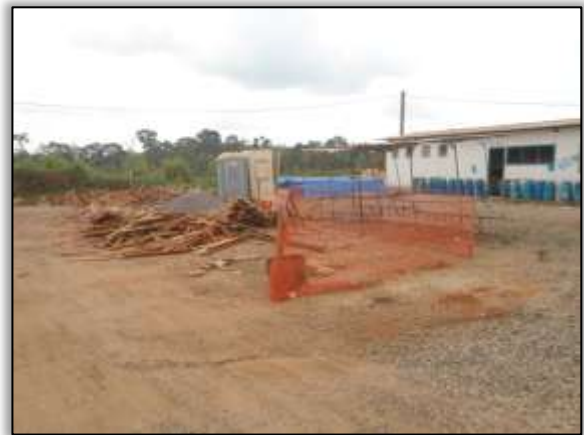
Foto 52 – Material armazenado inadequadamente no canteiro. Lado esquerdo. S 03.45018° W 051.21936° 26/11/2013
