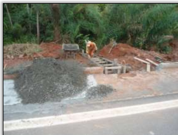
Foto 62 – Descida d'água. Lado esquerdo. Estaca 3672. S 03.10585° W 051.65064° 20/11/2013
