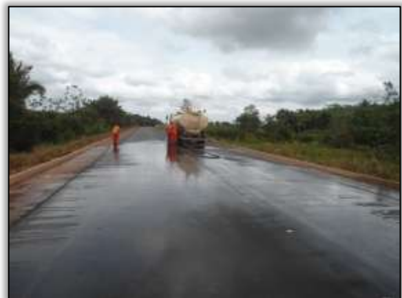
Foto 48- Preparo da pista para a sinalização (lavagem). Lado esquerdo e direito. Estaca 2948. S 03.18307° W 051.55235° 29/10/2013
