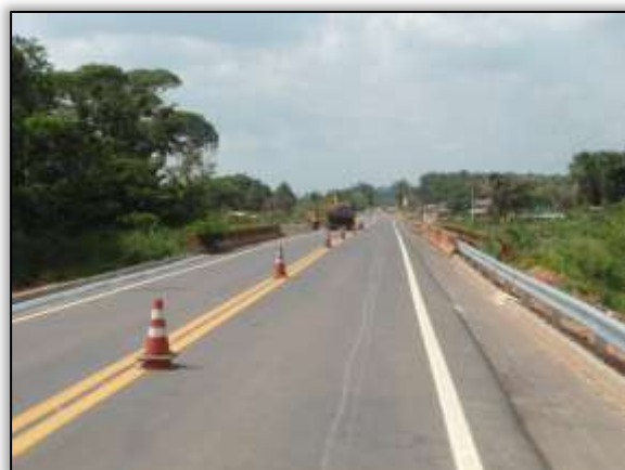
Foto 80– Defesa metálica. Estaca 3292. Lado Direito. S 03.13557° W 051.59121°. 06/12/2013.
