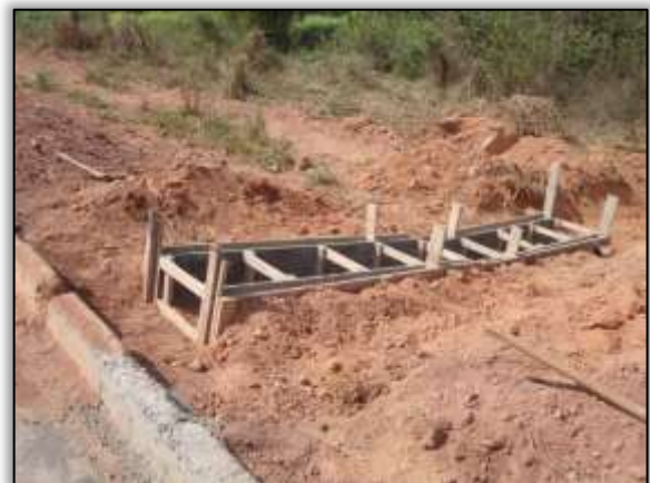
Foto 41 – Construção de sistema de drenagem (descida d'água). Lado direito. Estaca: 3368. S 03.12524° W 051.60093° 22/10/2013
