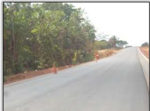
Foto 39. Preparo para construção de sistema de drenagem (meio fio). Estaca: 3186. S 03.14890° W 051.57792° 22/10/2013
