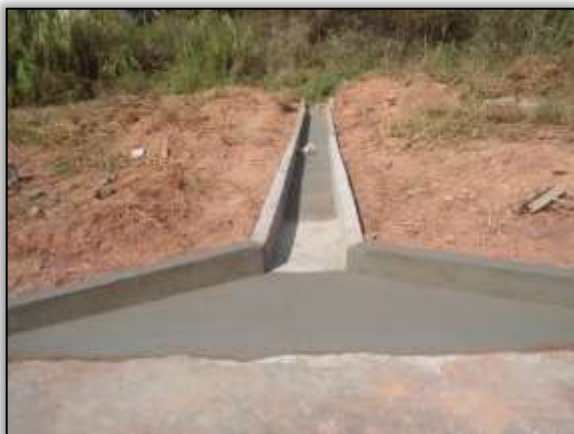
Foto 40 – Construção de sistema de drenagem (descida d'água). Lado direito. Estaca: 3365. S 03.12568° W 051.60022° 22/10/2013
