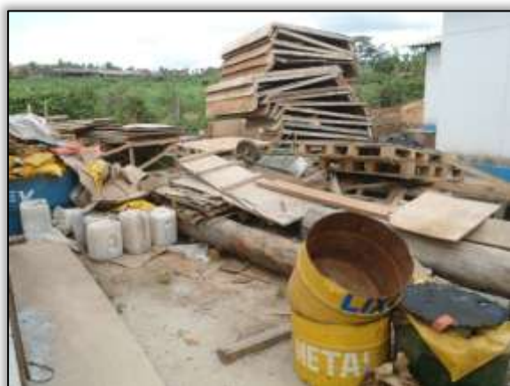
Foto 71– refugo de madeira armazenada de forma inadequada. Estaca 561. Lado Esquerdo. S 03.45124° W 051.21974°. 13/12/2013.
