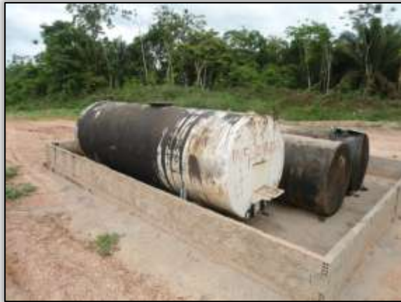
Foto 85– Vazamento de material betuminoso. Estaca 3478. Lado Direito. S 03.11609° W 051.61851°. 12/12/2013.
