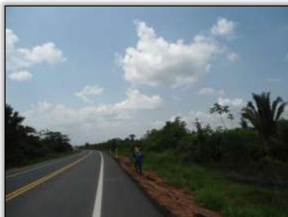
Foto 82– sinalização vertical. Estaca 3098. Lado Direito. S 03.16118° W 051.56741°. 06/12/2013.
