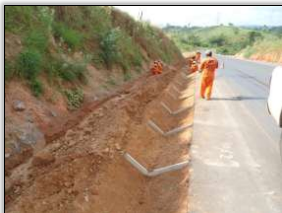
Foto 61 – Dispositivo de drenagem (Sarjeta). Lado esquerdo. Estaca 4318. S 03.12625° W 051.75865° 20/11/2013
