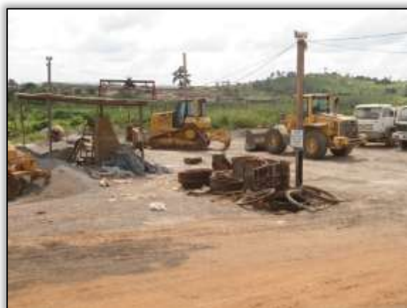
Foto 72– armazenamento inadequado de sucatas e britas. Estaca 561. Lado Esquerdo. S 03.45201° W 051.21883°. 13/12/2013.
