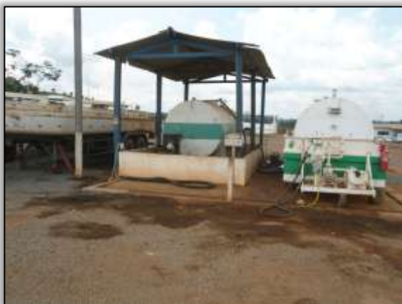
Foto 53 – Vestígio de vazamento de produto combustível. Lado esquerdo. S 03.45018° W 051.21936° 26/11/2013
