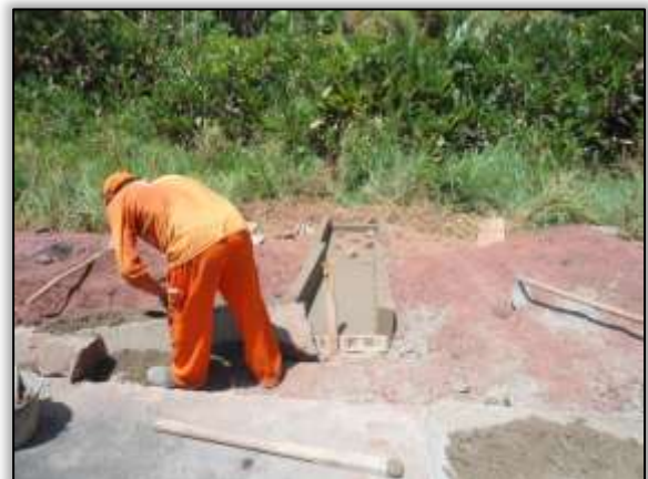
Foto 23 – Construção de sistema de drenagem (descida d'água). Lado esquerdo. Estaca 3084. S 03.16293° W 051.56593° 25/09/2013
