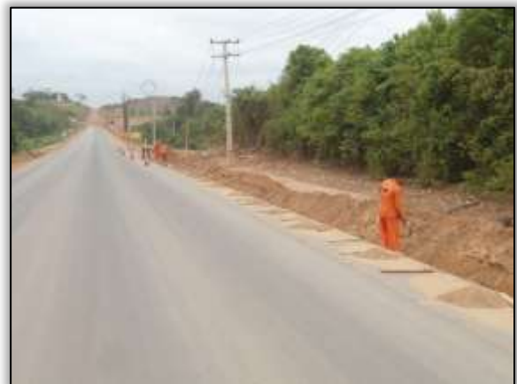
Foto 60 – Dispositivo de drenagem (Sarjeta). Lado esquerdo. Estaca 4730. S 03.57708° W 051.07933° 12/11/2013
