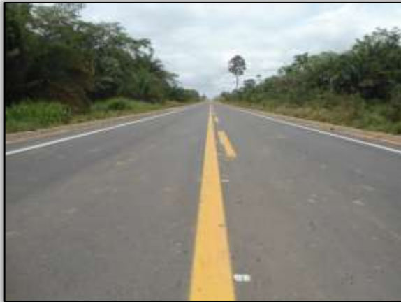
Foto 49- Sinalização horizontal. Lado esquerdo e direito. Estaca 2314. S 03.25880° W 051.46691° 29/10/2013
