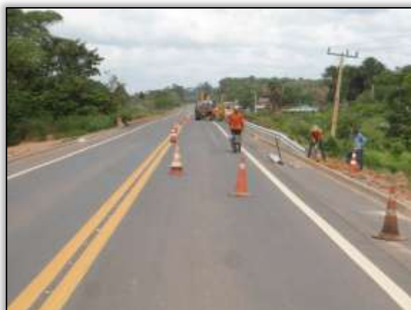
Foto 79– Defesa metálica. Estaca 3292. Lado Direito. S 03.13557° W 051.59121°. 06/12/2013.
