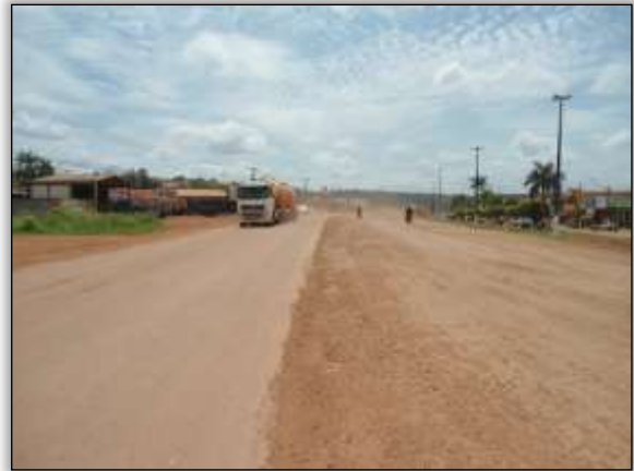
Foto 14 – Rodovia com aplicação da primeira camada asfáltica. Eixo da rodovia. S 04.25213° W 049.94488° 20/11/2013
