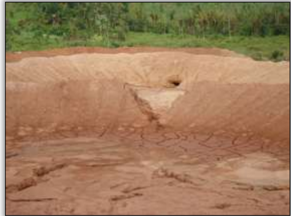
Foto 19 – Rompimento de bacia de contenção. Lado direito. S 04.18025° W 050.03599° 12/12/2013
