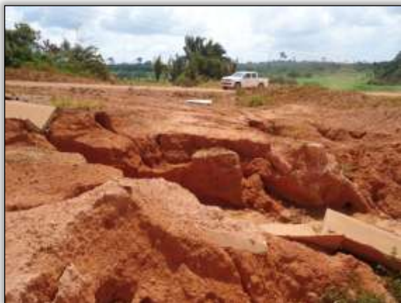
Foto 20 – Rompimento de dreno. Lado esquerdo. S 04.02377° W 049.28563° 12/12/2013
