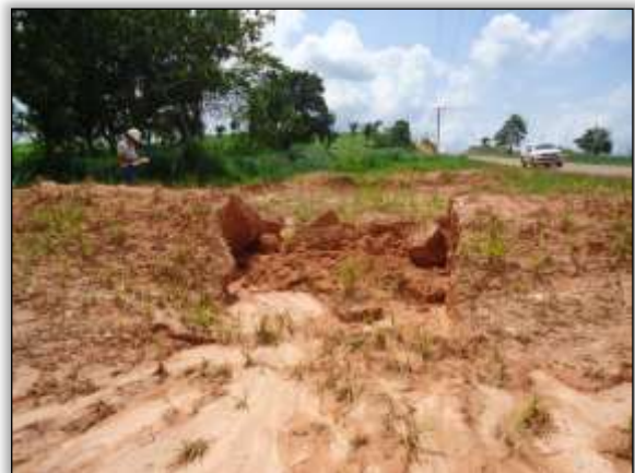
Foto 21 – Rompimento de bacia de contenção. Lado direito. S 04.02002° W 050.28389° 12/12/2013
