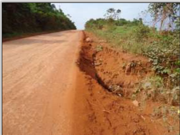
Foto 11 – Processo erosivo. Lado direito 05.12553° W 049.39997° 13/11/2013
