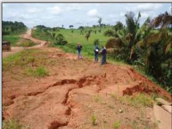
Foto 19 – Rompimento de dreno. Lado esquerdo. S 04.02377° W 049.28563° 29/01/2014
