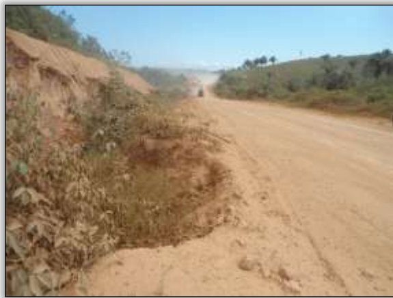
Foto 1 – Processo erosivo no bordo da rodovia. Lado esquerdo. 05.12553° W 049.39887° 23/08/2013
