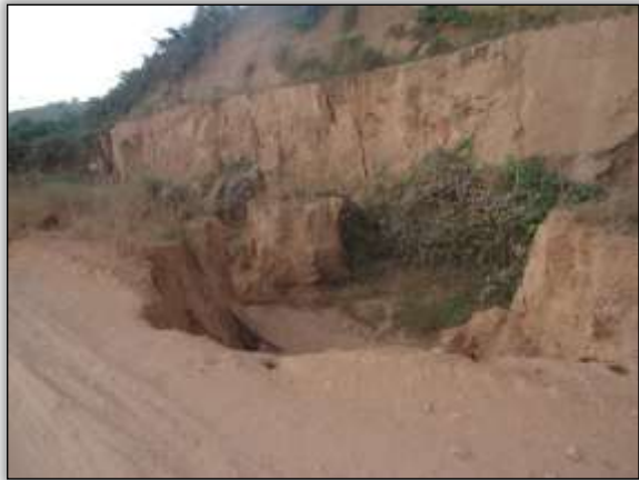
Foto 7 – Processo erosivo por rompimento de sistemas de drenagem subterrâneos avançando para pista de rolamento. Lado direito. S 05.25879° W 049.39858° 16/10/2013
