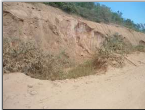
Foto 2– Desbarrancamento de Talude. Lado esquerdo. 05.12552° W 049.39879° 23/08/2013
