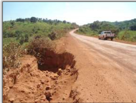
Foto 3– Processo erosivo no bordo da pista. 05.01112° W 049.45319° 23/08/2013
