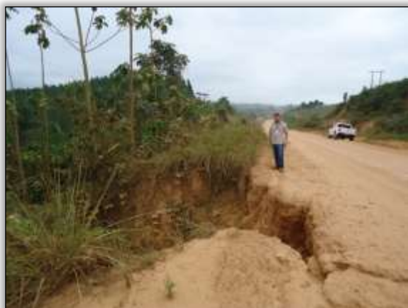
Foto 5 – Processo erosivo avançando para pista de rolamento. Lado direito. S 05.13100° W 049.39625° 17/09/2013
