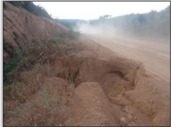
Foto 8 – Processo erosivo avançando para pista de rolamento. Lado esquerdo. S 05.25878° W 049.39857° 16/10/2013
