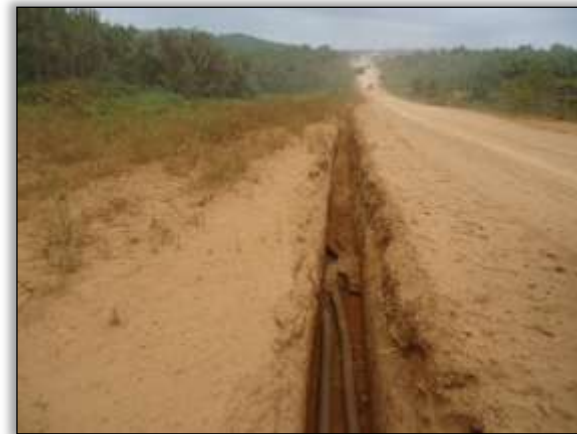
Foto 4 – Processo erosivo por rompimento de sistemas de drenagem subterrâneos. Lado esquerdo. S 05.14276° W 049. 39044° . 17/09/2013
