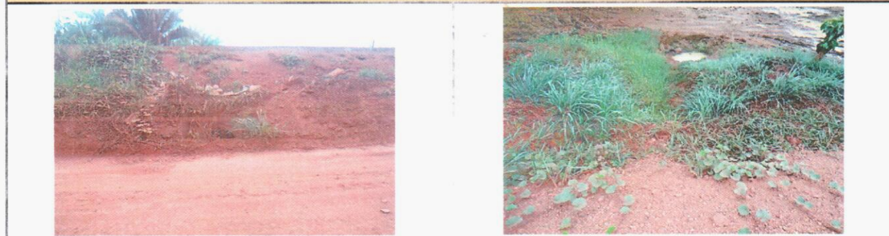
Foto 01 - Obstrução de bueiro.
