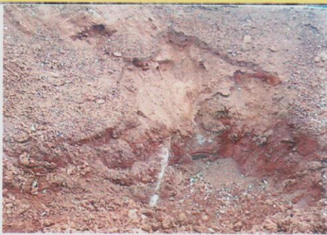
Foto 01 - Obstrução de bueiro.
