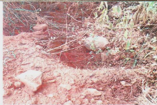
Foto 02 - Obstrução de bueiro.
