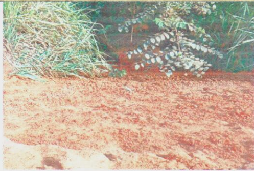
Foto 01 - Sedimento excedente na boca do bueiro.
