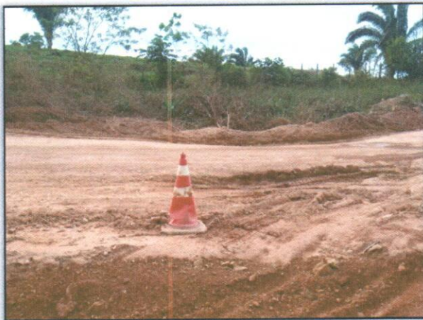
Foto 1 – Obstrução de material excedente na boca do bueiro. Lado: Direito/Esquerdo. Estaca: 3075. S 03.39785° W 052.73565° 17/10/2012
