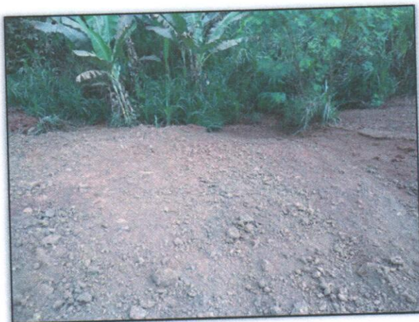
Foto 1 – Obstrução de material excedente na boca do bueiro. Lado: Direito/Esquerdo. Estaca: 3855. S 03.43894° W 052. 86495° 18/10/2012
