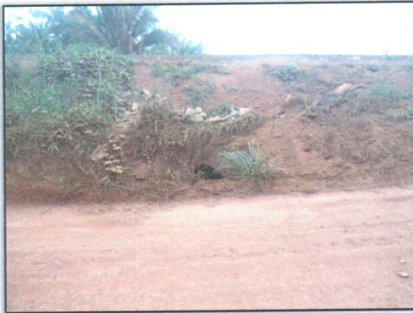
Foto 1 – Obstrução de material excedente na boca do bueiro. Lado: Direito/Esquerdo. Estaca: 4068. S 03.44551° W 052. 90198° 18/10/2012
