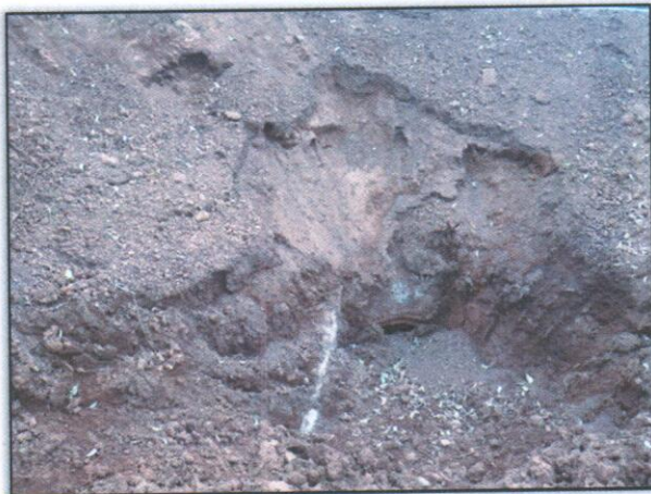
Foto 1 – Obstrução de material excedente na boca do bueiro. Lado: Direito/Esquerdo. Estaca: 3798+15. S 03.44207° W 052.85532° 18/10/2012
