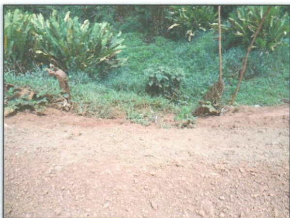
Foto 1 – Obstrução de bueiro. Lado: Esquerdo. Estaca: 4177. S 03.45109° W 052. 92046° 18/10/2012
