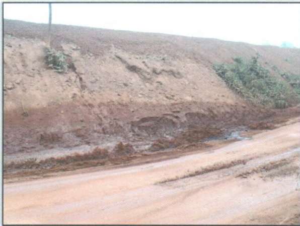
Foto 1 – Obstrução de bueiro. Lado: Esquerdo. Estaca: 4131. S 03. 44822° W 052. 91297° 18/10/2012
