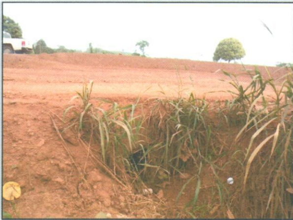
Foto 1 – Obstrução de bueiro. Lado: Esquerdo. Estaca: 4049. S 03.44496° W 052. 89866° 18/10/2012
