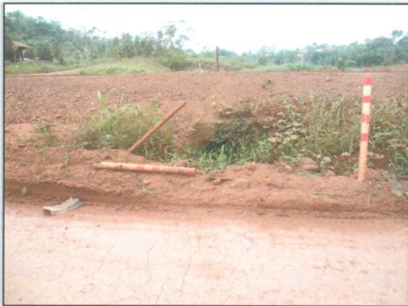
Foto 1 – Obstrução de bueiro. Lado: Direito. Estaca: 3968. S 03.44078° W 052.88467° 18/10/2012
