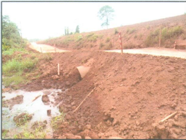
Foto 1 – Obstrução de bueiro. Lado: Direito. Estaca: 3940. S 03. 43952° W 052. 87969° 18/10/2012
