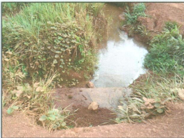
Foto 1 – Obstrução de bueiro. Lado: Direito. Estaca: 3896. S 03.43744° W 052.87251° 18/10/2012
