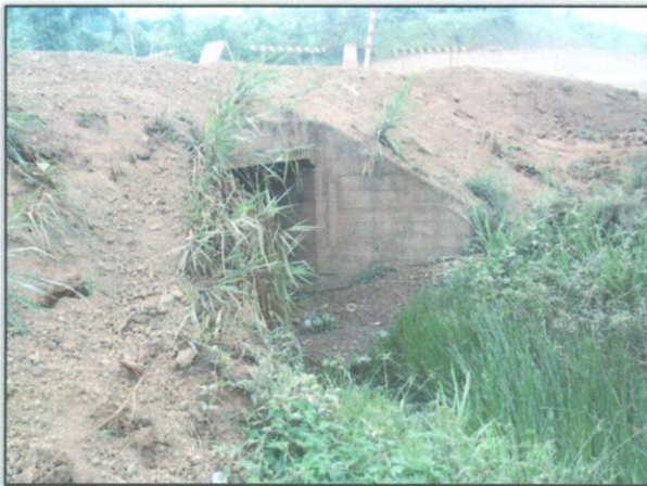
Foto 1 – Obstrução de bueiro. Estaca: 3833. S 03.43959° W 052. 86113° 18/10/2012
