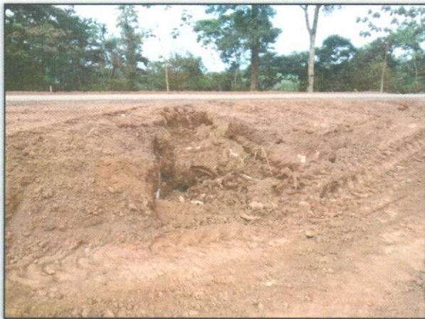
Foto 1 – Obstrução de bueiro. Estaca: 3818. S 03.44074° W 052. 85849° 18/10/2012
