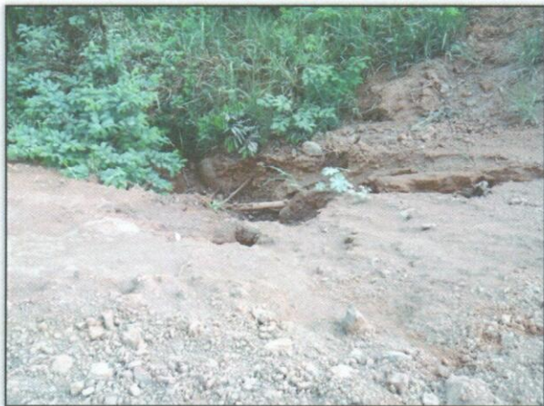
Foto 1 – Obstrução de bueiro. Estaca: 3786. S 03.44258° W 052.85361° 18/10/2012
