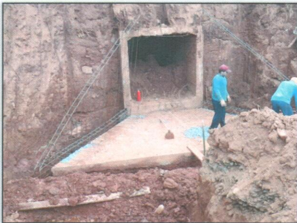
Foto 1 – Obstrução de bueiro. Lado: Esquerdo. Estaca: 3766. S 03.44278° W 052. 84949° 18/10/2012
