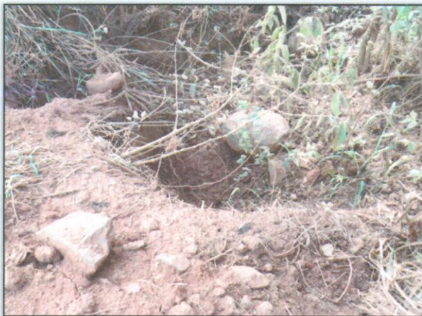
Foto 1 – Obstrução de bueiro. Estaca: 3699. S 03.44039° W 052.83799° 18/10/2012
