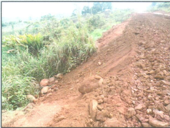
Foto 1 – Obstrução do bueiro. Lado: Direito. Estaca: 3683+15. S 03.43981° W 052. 83508° 18/10/2012
