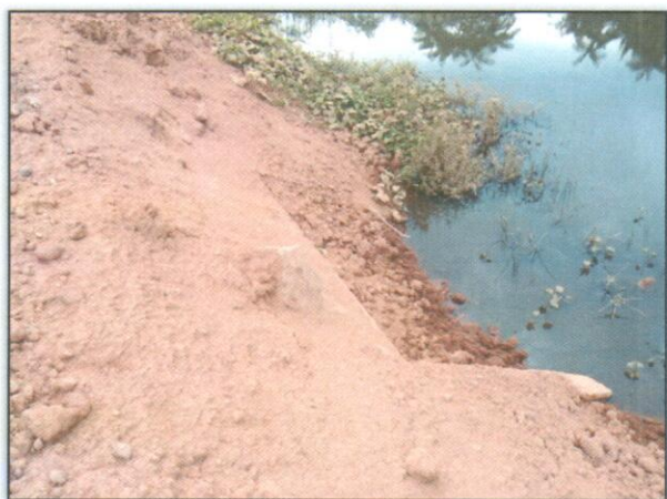
Foto 1 – Sedimentos excedentes obstruindo a boca do bueiro. Lado: Direito. Estaca: 3150. S 03.40163° W 052.74860° 17/10/2012
