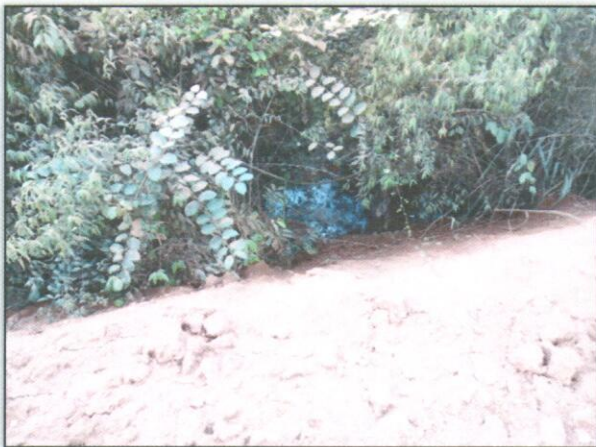
Foto 1 – Bueiro obstruído. Estaca: 3133. S 03. 40090° W 052. 74556° 17/10/2012
