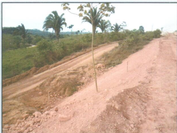
Foto 1 – Bueiro obstruído. Lado: Direito. Estaca: 3063. S 03.39729° W 052.73390° 17/10/2012.
