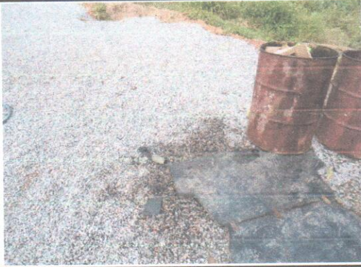
Foto 05 - Mancha no solo oriundo do vazamento de óleo combustível.
