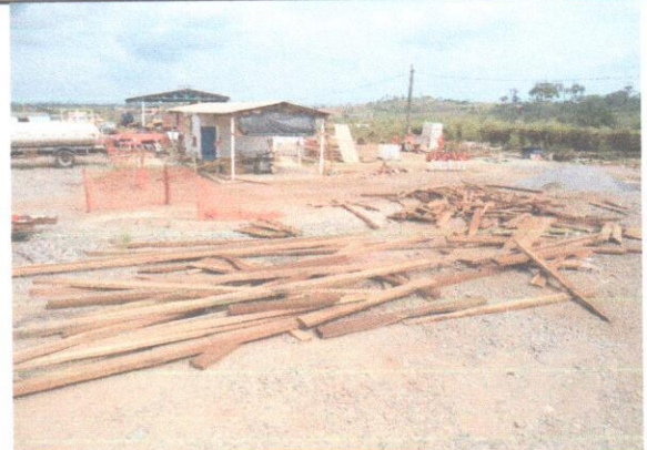
Foto 08 - Material combustivo (madeira) depositado inadequadamente
