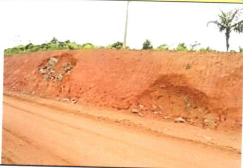
Foto 01 - Processo Erosivo no Talude de Corte (Médio) (Km 576,84 Estaca 4162 UTM: 419268/965046 Lado Direito).
