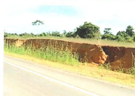
Foto 04 - Processo Erosivo no Talude de Corte (Médio) (UTM: 406024/9656858 Lado Esquerdo).
