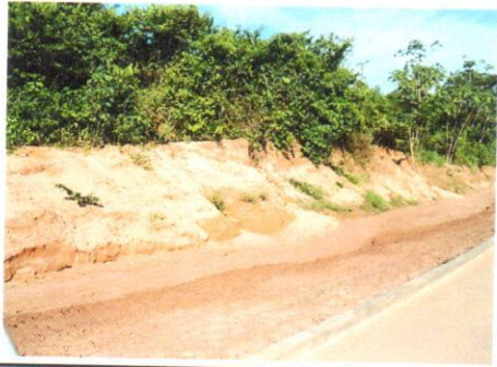
Foto 05 - Processos Erosivos no Pé do Talude de Corte (Médio) (Km 591,8 estaca 4910 UTM: 405626/9657087 Lado Direito).
