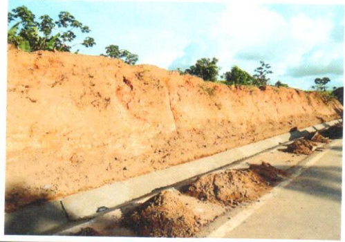
Foto 06 - Processos Erosivos no Talude de Corte (Médio) (km 596,4 estaca 5122 UTM: 402482/9657945 Lado Direito).
