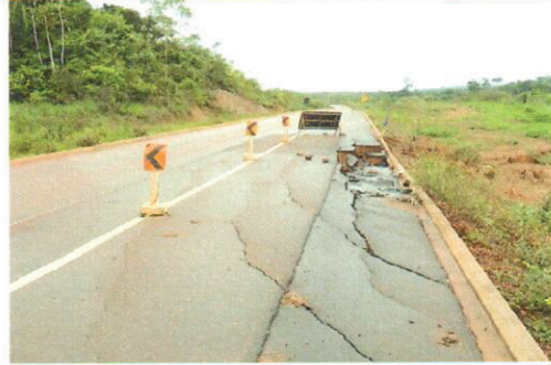
Foto 02 - Processos Erosivos na Pista de Rolamento (Grave) (Km 614,80 estaca 6060 UTM: 387698/9649724 Lado Esquerdo).
