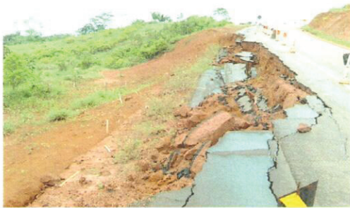
Foto 03 - Processos Erosivos na Pista de Rolamento (Grave) (Km 615,02 estaca 6071 UTM: 387533/9649629 Lado Esquerdo).
