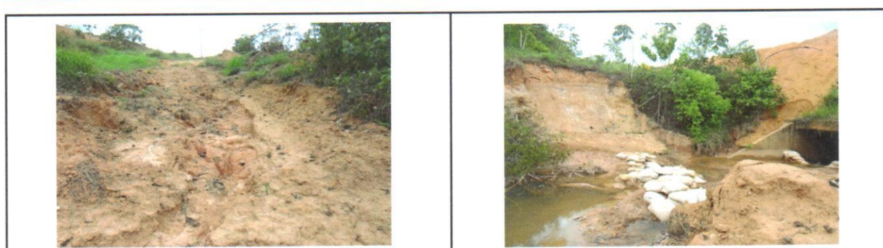
Foto 03 - Vista frontal do talude em processo de erosão (lado esquerdo). Foto 04 - Vista total do material excedente de escavação no leito do córrego.
