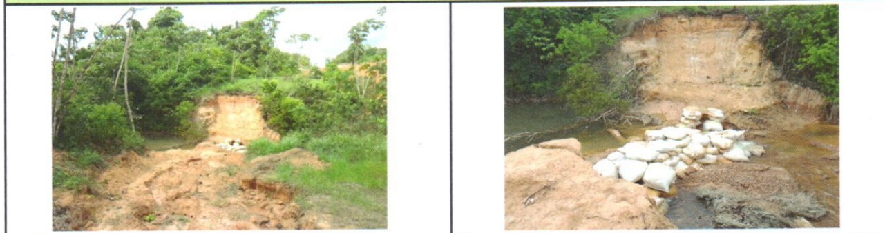
Foto 01 - Caminho de serviço em processo de erosão. Foto 02 - Vista parcial do material excedente de escavação no córrego
