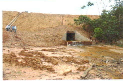
Foto 02 - Obra de arte corrente e assoreamento em APP.
