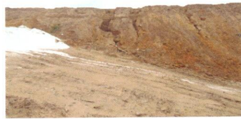
Foto 04 - Erosão no talude de aterro.
