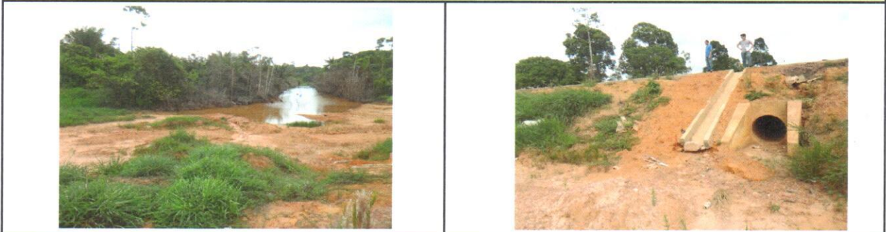
Foto 01 - Excedente de material nas margens do córrego (lado esquerdo).
