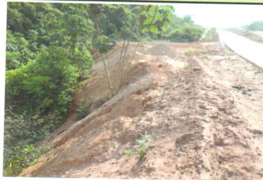
Foto 02 - Erosão no talude de aterro. (Lado Esquerdo).
