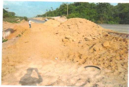
Foto 03 - Material excessivo de construção na faixa de domínio (Direito).
