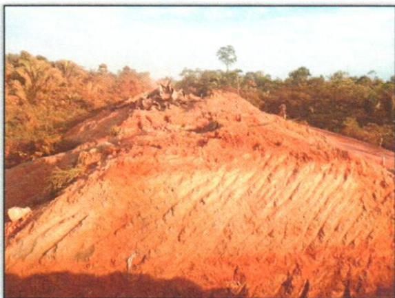
Foto 03 - Restos de bueiro metálico na faixa de domínio. Estaca 2542. Lado esquerdo. S 03.23188° W 051.49794°. 08/08/2012
