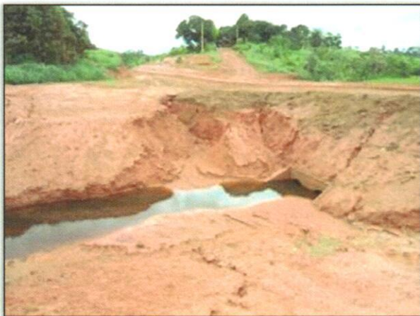
Foto 04 – Processo erosivo na faixa de domínio. Estaca 4109. Lado Direito. S 03.13342° W 051.71781°. 10/02/2012.
