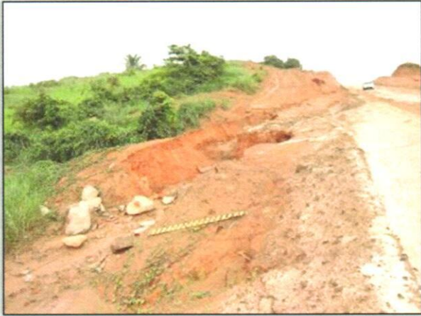
Foto 06 – Processo erosivo na saída do aterro. Estaca 4384. Lado Esquerdo. S 03.12569° W 051.76517°. 10/02/2012.
