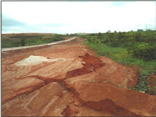
Foto 03 – Processo erosivo na lateral da pista. Estaca 4468. Lado Direito. S 03.12550° W 051.77995°. 09/12/2012.
