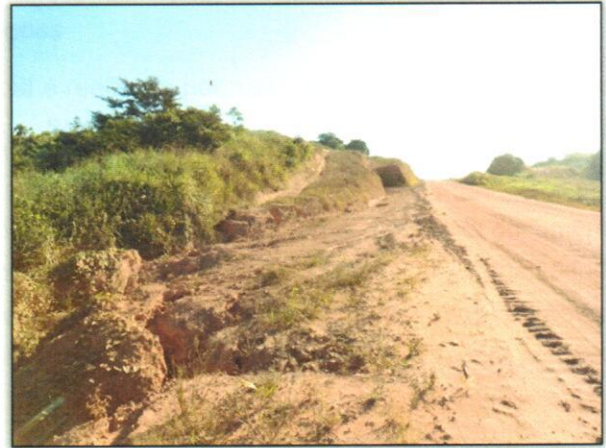
Foto 06 – Foi reconformado o processo erosivo, juntamente com uma drenagem provisória (bigode). Estaca 4384. Lado Esquerdo. S 03.12569° W 051.76517°. 04/07/2012.
