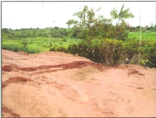
Foto 01 – Processo erosivo na faixa de domínio. Estaca 4222. Lado Direito. S 03.12495° W 051.73584°. 09/02/2012.
