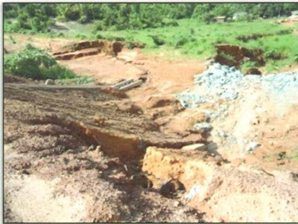
Foto 02 – Processos erosivos na saia do aterro. Estaca 4840. Lado Direito. S 03.10783° W 051.83798°. 09/02/2012.
