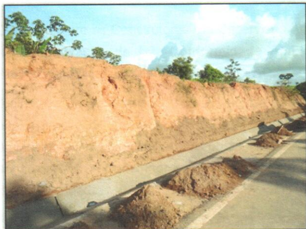
Foto 06 – Processos erosivos. Estaca 5122. Lado Direito. S 03. 09428 ° W 051. 87760 °. 10/02/2012.
