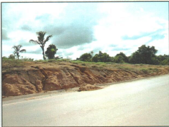
Foto 02 – Processos erosivos. Estaca 4840. Lado Esquerdo. S 03. 10572° W 051. 84259°. 09/02/2012.
