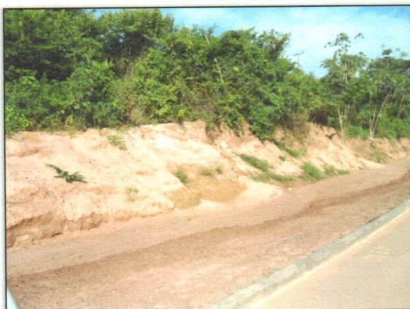
Foto 05 – Processos erosivos. Estaca 4910. Lado Direito. S 03. 10206° W 051. 84932°. 10/02/2012.
