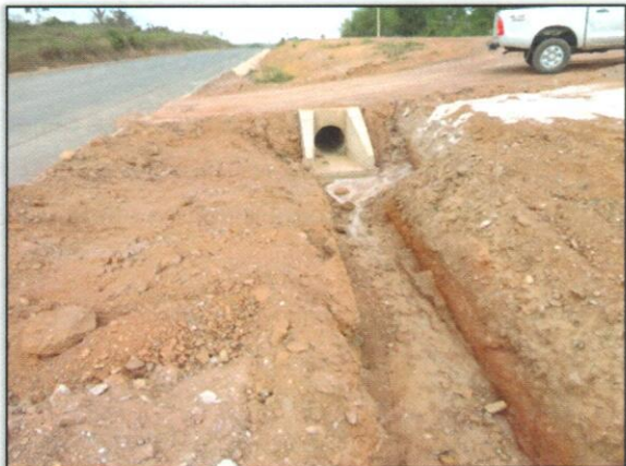
Foto 03 – Material excedente de escavação. Estaca 6008 Lado Esquerdo. S 03.16281° W 052.00312° 07/12/2011
