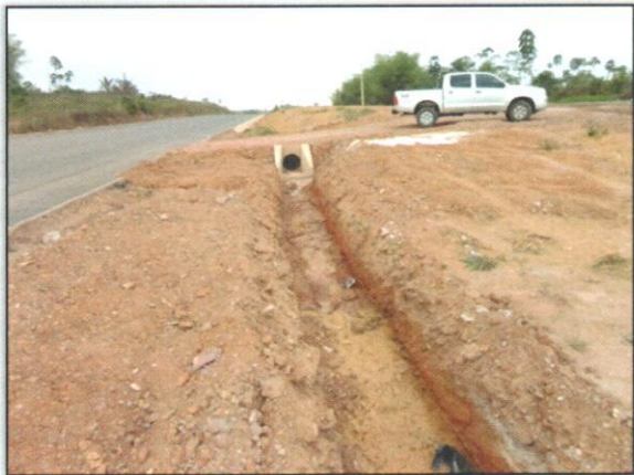
Foto 01 – Material excedente de escavação. Estaca 6008 Lado Esquerdo. S 03.16281° W 052.00312° 07/12/2011
