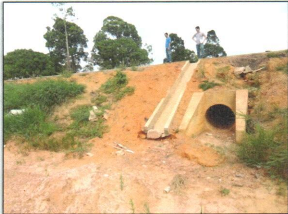
Foto 03 - Processo erosivo na ala do bueiro. Estaca 5920 Lado Esquerdo. S 03.155723° W 051.988967° 08/12/2011
