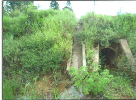
Foto 04 - Realizado hidrossemeadura para conter o processo erosivo. Estaca 5920 Lado Esquerdo. S 03.155723° W 051.988967° 04/06/2012
