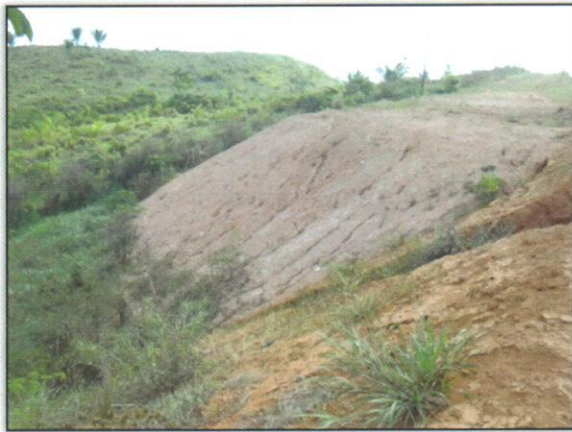
Foto 01 – Processos erosivos. Estaca 6040 Lado Esquerdo. S 03.166434° W 052.007578° 07/12/2011.
