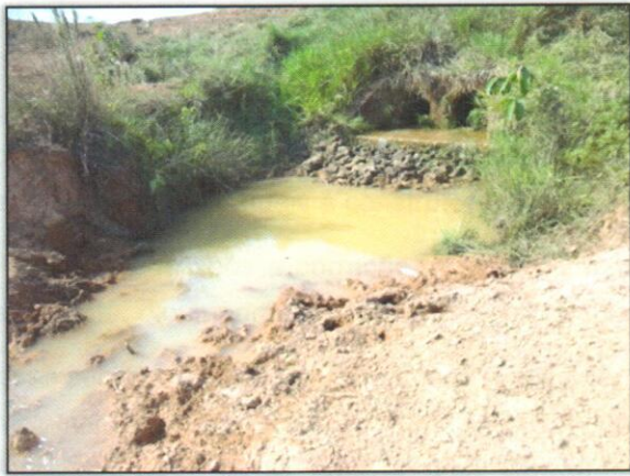
Foto 01 - Assoreamento do Corpo hídrico proveniente da erosão (Foto 03). Estaca 6154 Lado Esquerdo. S 03.169761° W 052.027119° 07/12/2011
