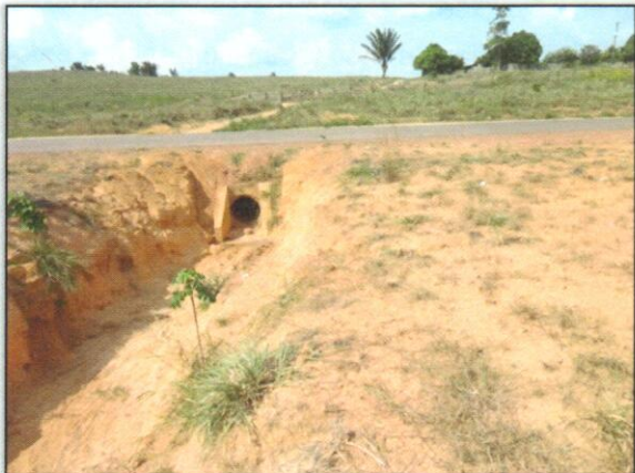
Foto 03 - Ausência de cobertura vegetal e processos erosões na ala do bueiro. Estaca 6200 Lado Esquerdo. S 03.169780° W 052.035398° 07/12/2011
