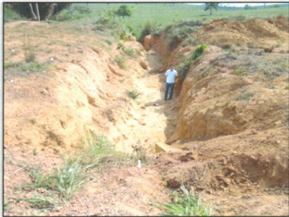
Foto 01 – Processos erosivos na boca do bueiro e nas suas alas. Estaca 6200 Lado Esquerdo. S 03.169780° W 052.035398° 07/12/2011
