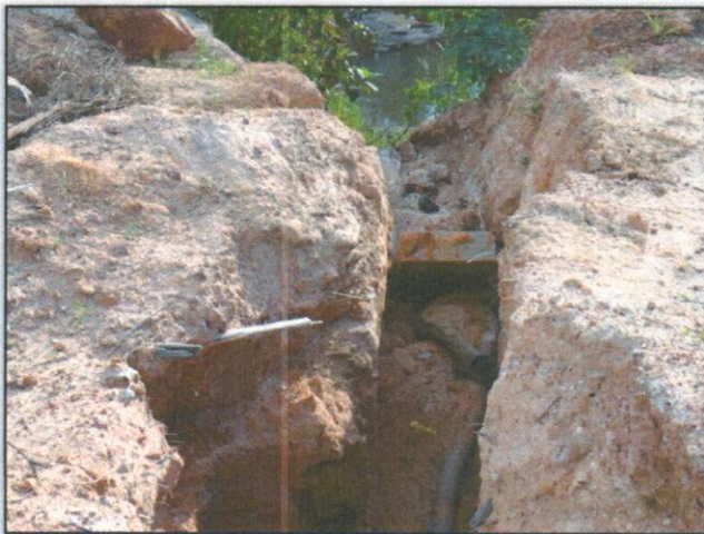
Foto 01: (Antes) Erosão na saia de aterro e dreno profundo danificado. Lado esquerdo. 09/12/2011
