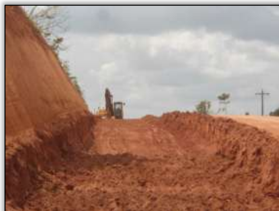
Foto 641 – Corte da rodovia. Lado esquerdo. Estaca 4779. S 03.56930° W 051.08422° 16/09/2013
