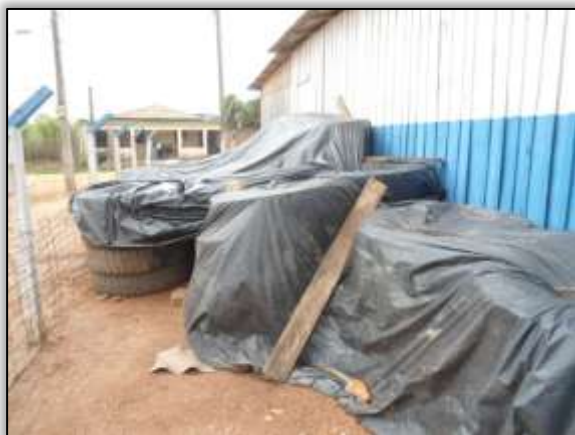
Foto 768 – Armazenamento de pneus no canteiro de obra. Lado esquerdo. Estaca 1827. S 03.30872° W 052.53631° 13/11/2013.
