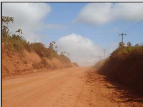
Foto 1102 – Processo erosivo no bordo da pista (antes). Ambos os lados. S 04.20362º W 049.99275º 18/06/2013
