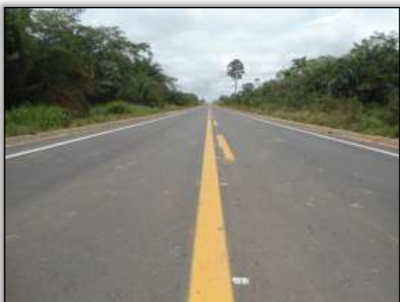
Foto 746- Sinalização horizontal. Lado esquerdo e direito. Estaca 2314. S 03.25880° W 051.46691° 29/10/2013
