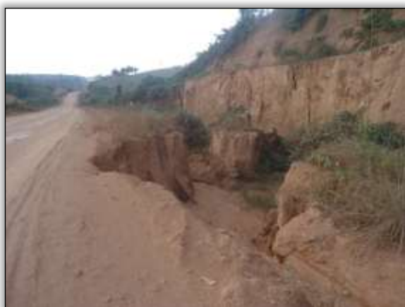
Foto 1058 – Processo erosivo por rompimento de sistema de drenagem em 15/10/2013. Lado direito. S 05.25879° W 049.39858°
