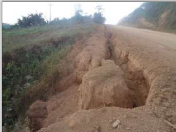
Foto 1051 – Processo erosivo em estágio avançado em 15/10/2013, Lado esquerdo. S 05.13041° W 049.39634°
