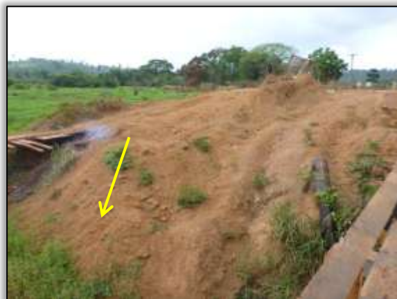
Foto 1364 – Ponto 27 – Assoreamento. 3.905142° S 50.363235° W (12/10/2013).
