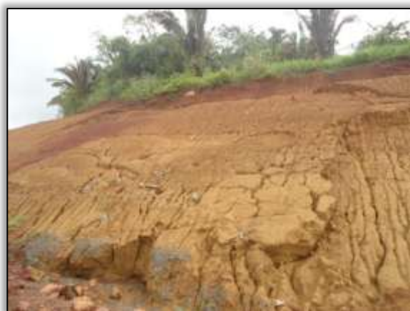
Foto 1207 - Processo erosivo no talude de corte. Lado esquerdo. Estaca 3554. S 03. 43131° W 052. 81432° 28/01/2014
