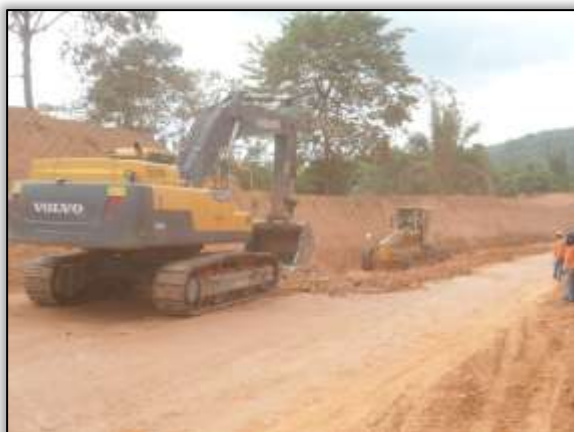
Foto 648 – Corte da rodovia. Lado esquerdo. Estaca 4732. S 03.57645° W 050.07918° 02/10/2013
