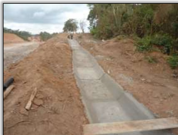
Foto 637 – Dispositivo de drenagem (valeta). Lado esquerdo. Estaca 4945. S 03.55459° W 051.10764° 30/10/2013
