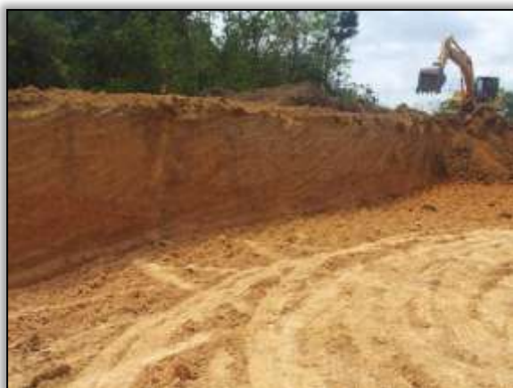
Foto 983 - Corte em talude. Lado esquerdo. Estaca 8763. S 03. 88965° W 054. 27910° 23/10/2013.
