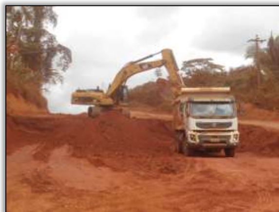
Foto 808 - Corte na pista de rolamento. Estaca 3289. S 03. 40957° W 052. 77177° 14/08/2013
