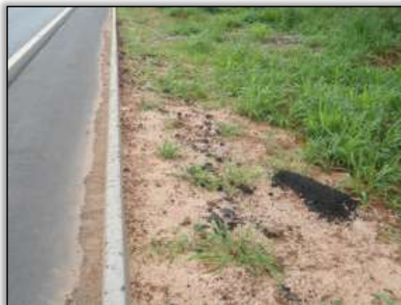
Foto 687– Resíduo de obra. Estaca 3132. Lado Esquerdo. S 03.15604° W 051.57127° 24/01/2014
