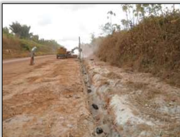
Foto 700 – Construção de sistema de drenagem (dreno profundo). Lado direito. Estaca 592. S 03.44715° W 051.22376° 24/09/2013
