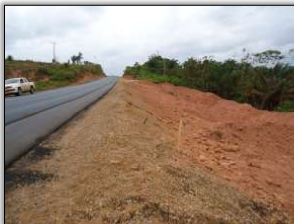
Foto 1113 – Ravinamento parcialmente recuperado (depois). Ambos os lados. S 04.16764º W 050.07422º 18/09/2013
