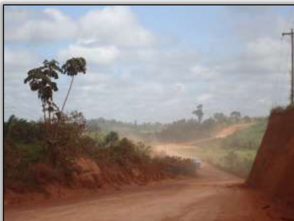
Foto 1106 – Processo erosivo no bordo da pista (antes). Ambos os lados. S 04.19491º W 050.01662º 18/06/2013
