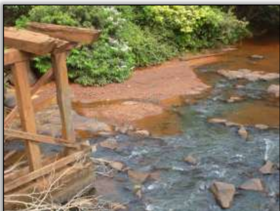
Foto 1470 – Ponto 53 – Assoreamento. S 3.495856° W 52.980855° (09/10/2013).
