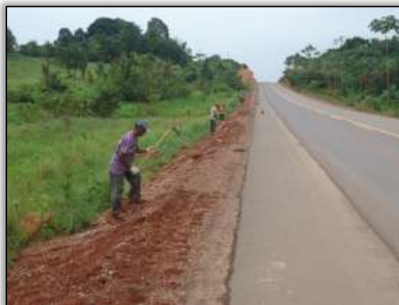
Foto 1079 – Preparação de saia de aterro para realização da hidrossemeadura. Lado esquerdo. S 04.23436° W 049.96729° 15/01/2014
