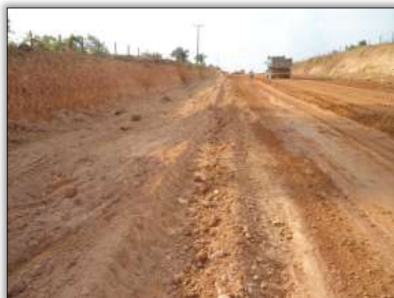
Foto 1028 – Processo erosivo parcialmente recuperado. Lado esquerdo. S 05.22129° W 049.34314° 16/10/2013
