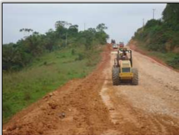
Foto 495 – Atividade de compactação do solo. Lado esquerdo. S 04.25050° W 049.04603° 12/11/2013
