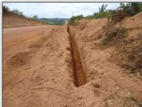
Foto 468 – Abertura para sistema de drenagem. Lado esquerdo. S 05.24361° W 049.33151°. 29/10/2013
