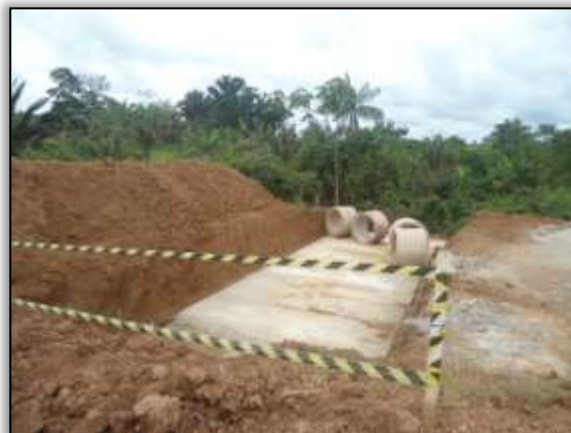
Foto 1006 - Construção de bueiro. S 03.88794° W 054.39463° 30/01/2014
