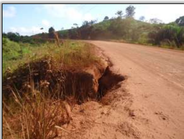
Foto 1098 – Processo erosivo (antes). Lado esquerdo. S 04.22207º W 049.97798º 18/06/2013.
