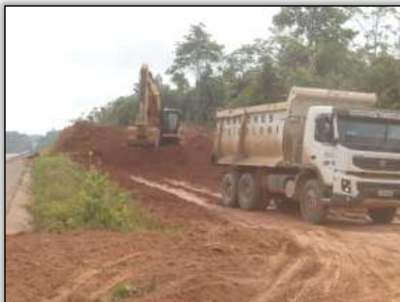
Foto 881 – Corte em talude. Lado esquerdo. Estaca 1356. S 03.28519° W 052.46691° 13/11/2013.
