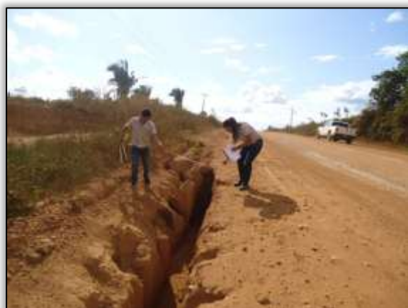
Foto 1027 – Processo erosivo por rompimento de dreno subterrâneo. Lado esquerdo. S 05.22129° W 049.34314°. 22/07/2013
