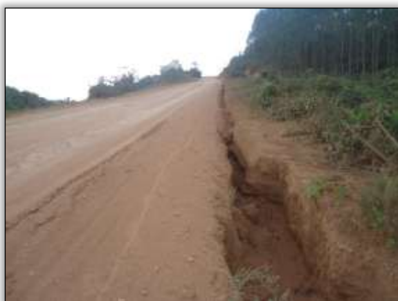
Foto 1041 – Processo erosivo por rompimento de sistemas de drenagem subterrâneos em 15/10/2013. Lado direito. S 05.14288° W 049. 39047°.
