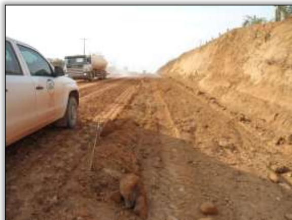
Foto 1026 – Processo erosivo parcialmente recuperado. Lado direito. S 05.22129° W 049.34314°. 16/10/2013.
