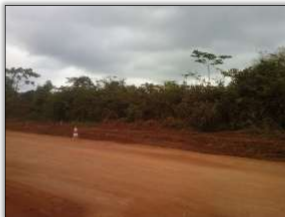
Foto 1214 – Área após a retirada da vegetação de rolamento. Lado esquerdo. S 05.17901° W 049.37054° 21/10/2013
