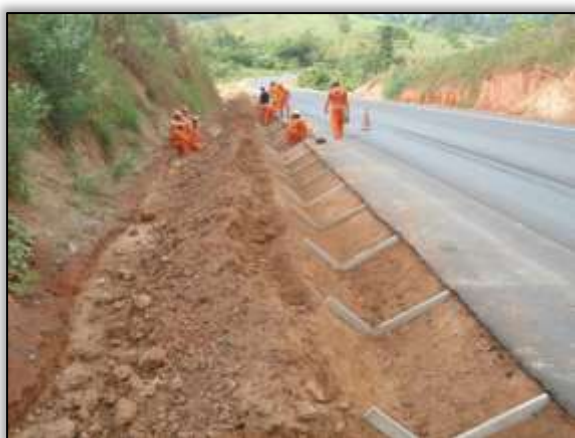
Foto 1140 – Dispositivo de drenagem (Sarjeta). Lado esquerdo. Estaca 4318. S 03.12625° W 051.75865° 20/11/2013
