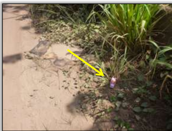
Foto 1305 – Ponto 09 – Lixo sobre a ponte. 5.335456° S 49.220987° W (14/10/2013).
