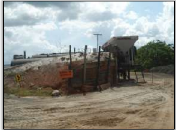
Foto 753 – Usina de asfalto. Lado direito estaca 3775. S 03.44206° W 052. 85213°. 20/08/2013.
