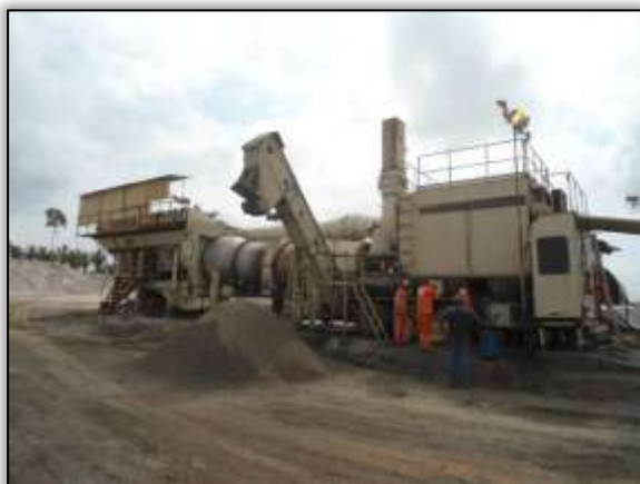
Foto 770 - Usina de asfalto. Lado direito. Estaca 1880. S 03.30814° W 052.54790° 14/11/2013.
