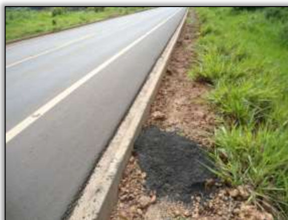
Foto 689– Resíduo de obra. Estaca 2978. Lado Esquerdo. S 03.17878° W 051.55574° 24/01/2014
