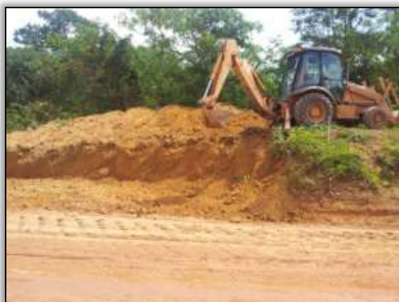
Foto 985 - Corte em talude. Lado esquerdo. Estaca 8773. S 03. 88901° W 054. 28034° 23/10/2013.
