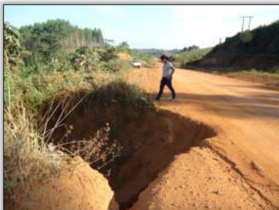
Foto 1056 – Processo erosivo em estágio avançado em 23/07/2013. Lado esquerdo. S 05.12659° W 049.39826°
