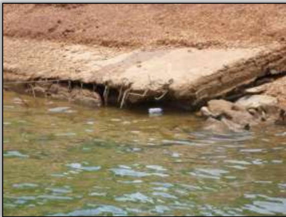
Foto 1410 – Ponto 39 – Esgoto a céu aberto. 3.121991° S 51.698708° W (10/10/2013).
