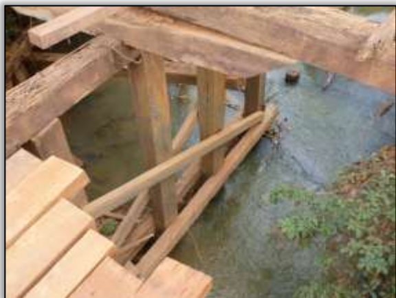
Foto 1441 – Ponto 47 – Montante – Resto de ponte antiga. 3.320154° S 52.567838° W (09/10/2013).
