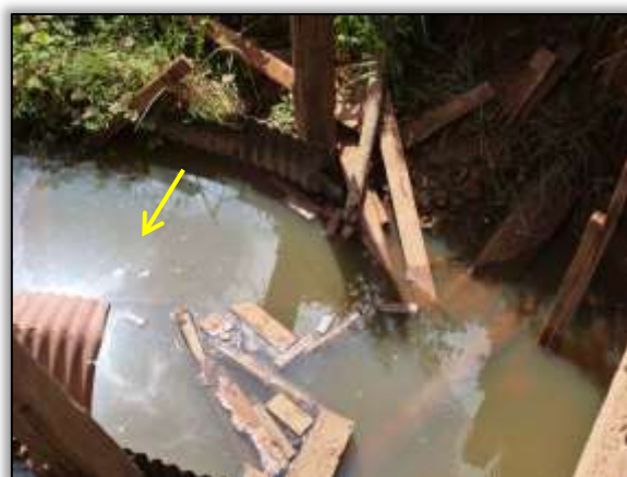
Foto 1330 – Ponto 16 – Jusante – Mancha de óleo na água. 4.764052° S 49.611726° W (14/10/2013).
