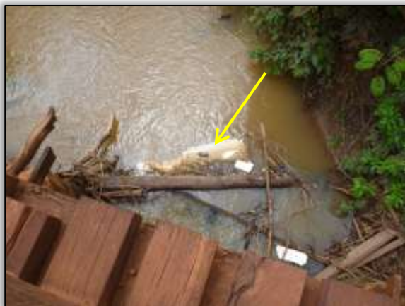
Foto 1466 – Ponto 52 – Jusante – Tora de madeira. S 3.456440° W 52.926058° (09/10/2013).
