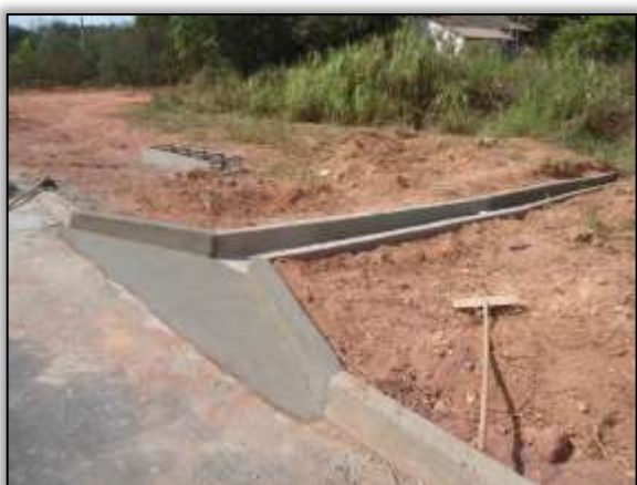
Foto 732 - Construção de sistema de drenagem (descida d'água). Lado direito. Estaca: 3365. S 03.12568° W 051.60022° 22/10/2013
