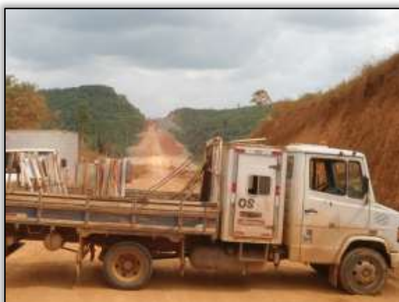
Foto 623 – Interdição para detonação na ladeira do Antônio Gerente. Lado esquerdo. S 03.69612° W 050.92450° 20/11/2013
