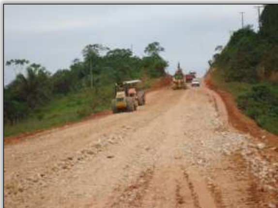
Foto 1053 – Processo erosivo em fase de recuperação. Lado esquerdo. S 05.13041° W 049.39634° . 12/11/2013
