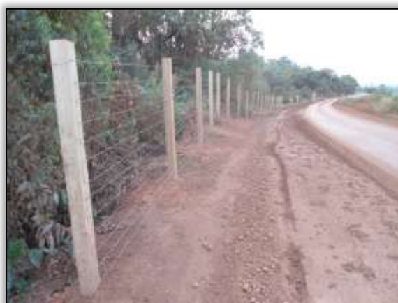
Foto 586 – Cercas instaladas na T.I. Parakanã próximo ao rio Xarayra (baiano). Lado esquerdo. S 04.52939° W 049.83068°. 30/10/2013.
