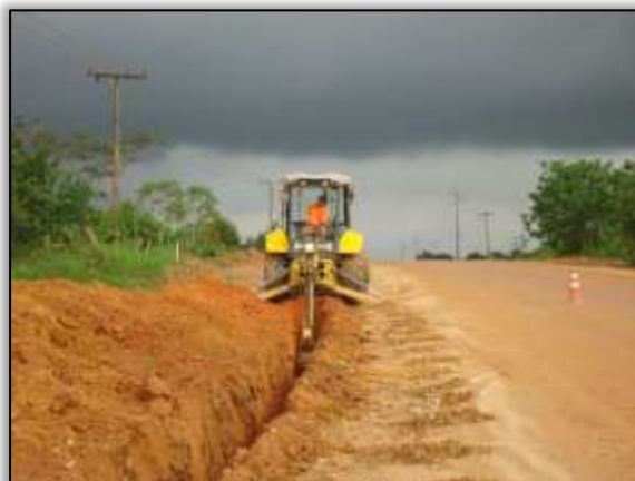
Foto 1034 – Abertura de dreno longitudinal. Lado esquerdo. S 05.20498° W 049.35582° 21/01/2014
