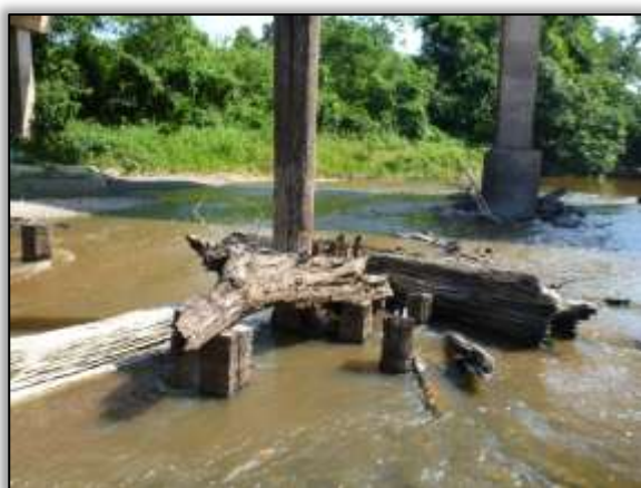
Foto 1299 – Ponto 07 – Galhos debaixo da ponte. 5.376823° S 49.015351° W (15/10/2013).
