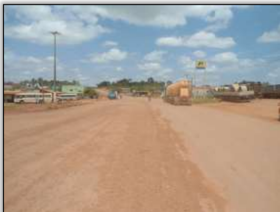
Foto 550 – Rodovia com aplicação da primeira camada asfáltica. Eixo da rodovia. S 04.25213° W 049.94488° 20/11/2013
