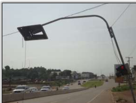
Foto 461 – Semáforo danificado. S 05.35776° W 049.08637° 20/09/2013
