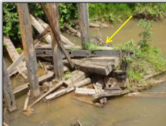
Foto 1500 – Ponto 63 – Montante – Resto de ponte antiga. 3.884206° S 54.368225° W (08/10/2013).
