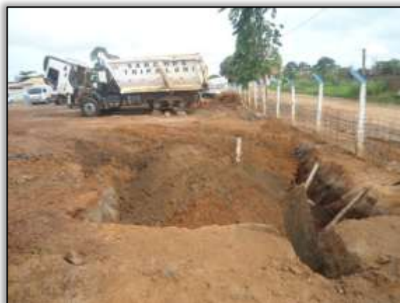
Foto 779 - Fossa desativada. Lado esquerdo. Estaca 1827. S 03.30872° W 052.53631° 28/01/2014
