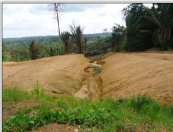
Foto 565 – Processo erosivo em aterro. Lado esquerdo. S 03.93081° W 050.33004° 12/12/2013
