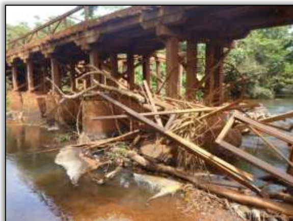
Foto 1471 – Ponto 53 – Galhos atrapalhando o fluxo de água. S 3.495856° W 52.980855° (09/10/2013).
