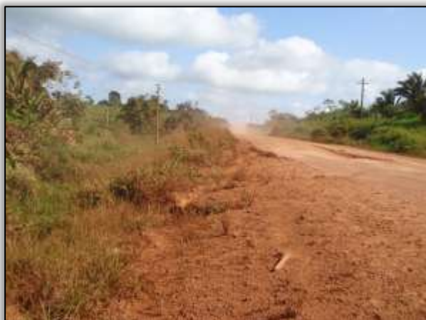
Foto 1096 – Processo erosivo no bordo da pista (antes). Lado esquerdo. S 04.21316º W 049.98400º 18/06/2013
