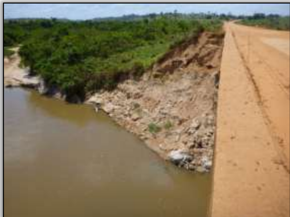
Foto 1310 – Ponto 11 – Erosão as margens – Jusante. 5.211021°S 49.351740° W (14/10/2013).
