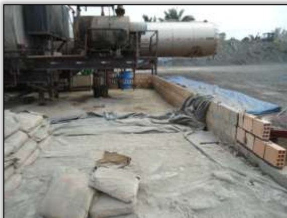
Foto 771 - Usina de asfalto. Lado direito. Estaca 1880. S 03.30814° W 052.54790° 14/11/2013.
