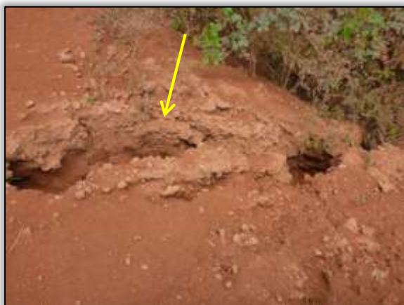
Foto 1501 – Ponto 64 – Erosão as margens. 3.924921° S 54.574391° W (08/10/2013).
