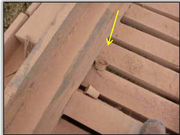
Foto 1484 – Ponto 57 – Lixo sobre a ponte. S 3.704800° W 53.673930° (08/10/2013).
