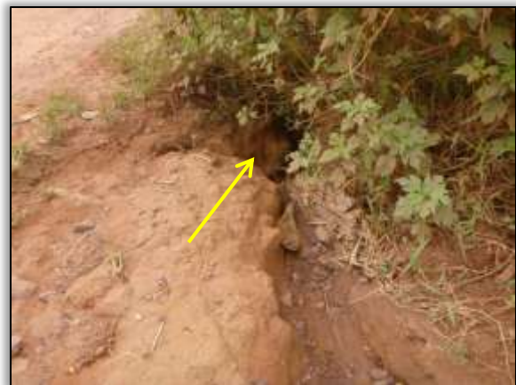
Foto 1467 – Ponto 52 – Erosões as margens. S 3.456440° W 52.926058° (09/10/2013).
