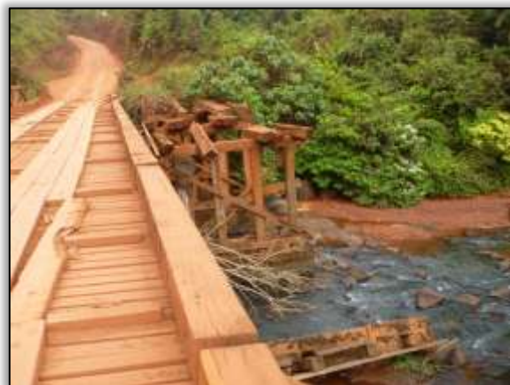
Foto 1469 – Ponto 53 – Jusante – Resto de ponte S 3.495856° W 52.980855° (09/10/2013).
