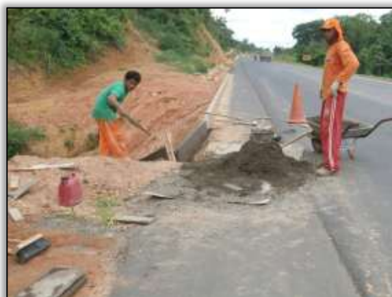
Foto 1133 – Descida d'água. Lado esquerdo. Estaca 4972. S 03.55259° W 051.11128° 08/01/2014
