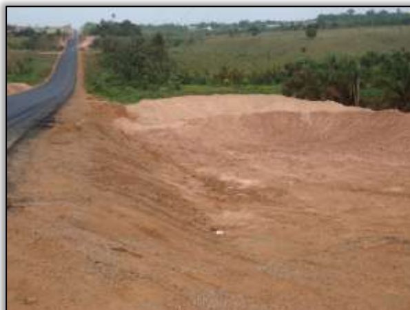
Foto 1109 – Ravinamento parcialmente reconformado (depois). Ambos os lados. S 04.18025º W 050.03599º 18/09/2013
