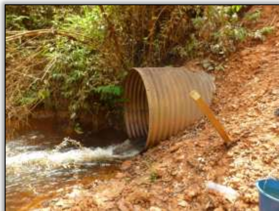
Foto 1502 – Ponto 64 – Jusante – Bueiro Armco – Erosão nas margens assoreando o igarapé. 3.924921° S 54.574391° W (08/10/2013).
