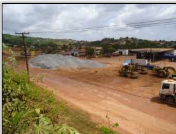
Foto 544 – Vista ampla da duplicação em Novo Repartimento. Eixo da rodovia. S 04.25213° W 049.94488° 01/10/2013
