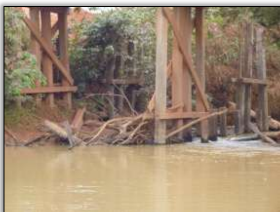
Foto 1449 – Ponto 49 – Jusante – Resto de ponte dentro do Igarapé S 3.387970° W 52.692354° (09/10/2013).
