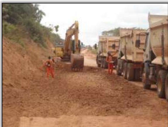
Foto 640 – Corte da rodovia. Lado esquerdo. Estaca 4987. S 03.55305° W 051.11077° 16/09/2013
