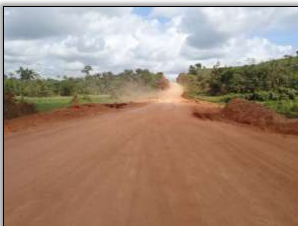
Foto 1110 – Bueiro a jusante e a montante com processo erosivo no bordo da pista (antes). Ambos os lados. S 04.16943º W 050.06872º 18/06/2013
