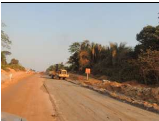
Figura 50. Obra de terraplenagem na BR-230/PA acompanhada pela equipe de Salvamento. Data: 31/10/13 _ 22M 0798835 E / 9370670 N
