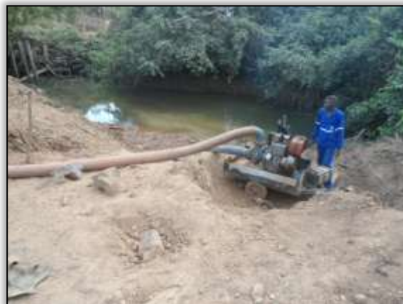
Foto 804 - Captação de água igarapé Arrependido. Lado esquerdo. S 03. 32021° W 052. 56824° 27/09/2013
