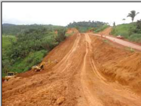
Foto 503 – Correção da saia de aterro. S 03.69789° W 050.67567° 21/08/2013
