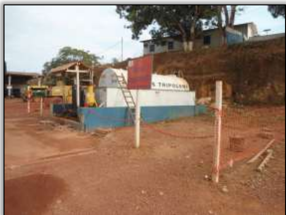
Foto 553 – Área de abastecimento. S 04.23928° W 049.95531° 23/10/2013.
