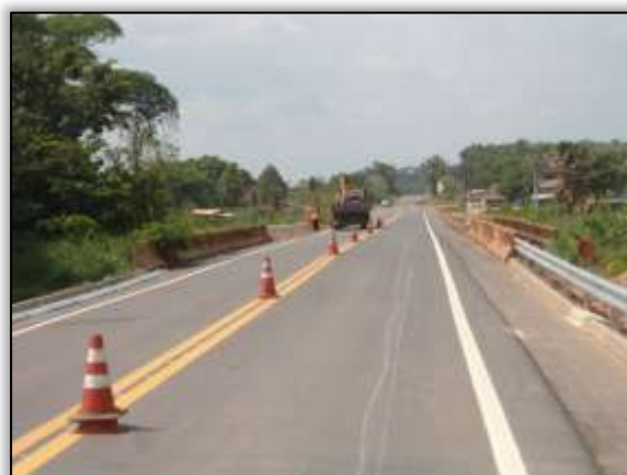
Foto 707– Defesa metálica. Estaca 3292. Lado Direito. S 03.13557° W 051.59121° 06/12/2013.
