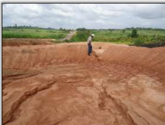
Foto 561 – Rompimento de bacia de contenção. Lado direito. S 04.18025° W 050.03599° 12/12/2013
