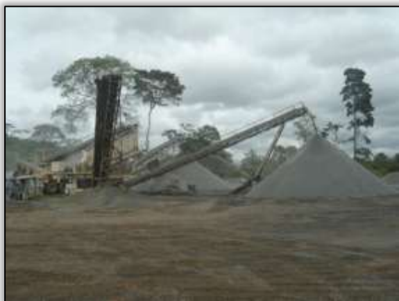
Foto 780 - Britador em funcionamento. Lado direito. estaca 3775. S 03.44206° W 052.85213° 28/01/2014
