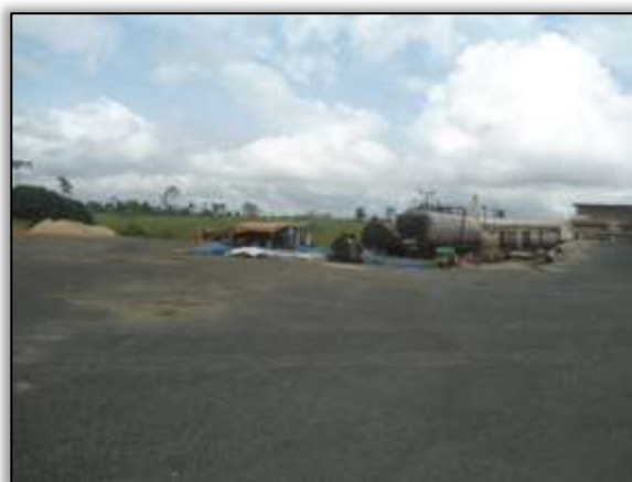
Foto 783 - Usina de asfalto. Lado direito. Estaca 1880. S 03.30814° W 052.54790° 23/01/2014.
