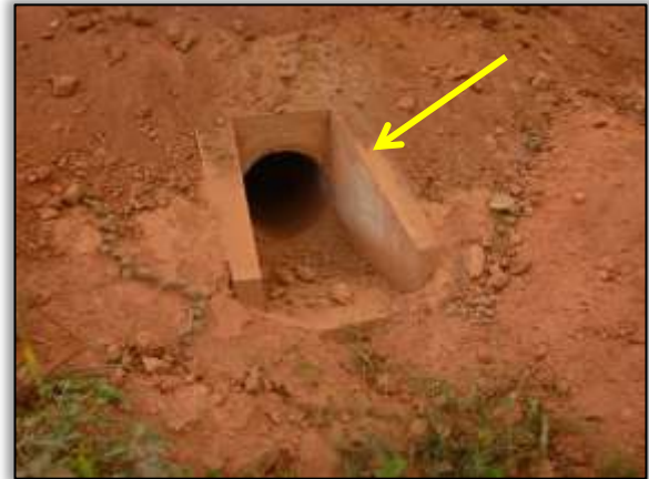
Foto 1394 – Ponto 35 – Jusante – Bueiro 3.564519° S 51.086520° W (11/10/2013).
