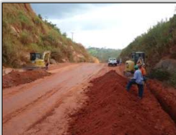
Foto 697 – Dreno profundo. Lado direito/esquerdo. Estaca 4065. S 03.13222° W 051.71058° 29/08/2013.
