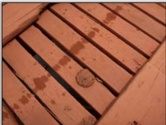
Foto 1468 – Ponto 53 – Fezes sobre a ponte. S 3.495856° W 52.980855° (09/10/2013).
