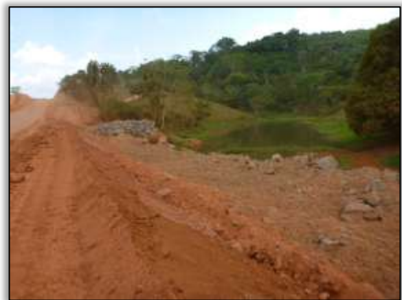
Foto 1396 – Ponto 35 – Assoreamento. 3.564519° S 51.086520° W (11/10/2013).
