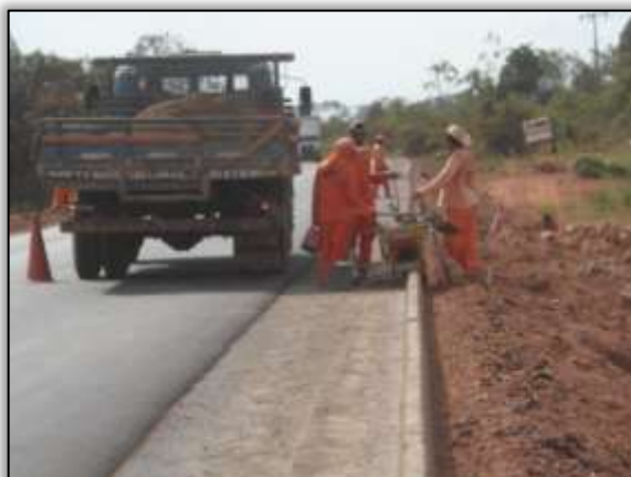
Foto 729 – Construção de sistema de drenagem (meio fio). Lado direito. Estaca: 3558. S 03.11580° W 051.68281° 09/10/2013
