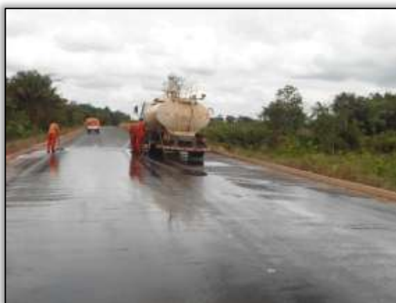
Foto 745- Preparo da pista para a sinalização (lavagem). Lado esquerdo e direito. Estaca 2948. S 03.18307° W 051.55235° 29/10/2013
