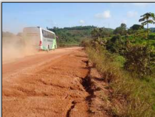
Foto 1090 – Processo erosivo no bordo da pista (antes). Lado direito. S 04.23299° W 049.96426° 18/06/2013
