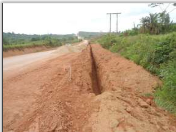
Foto 1031 – Processo erosivo por rompimento de dreno subterrâneo em 24/10/2013. Lado direito. S 05.14222° W 049.39058°
