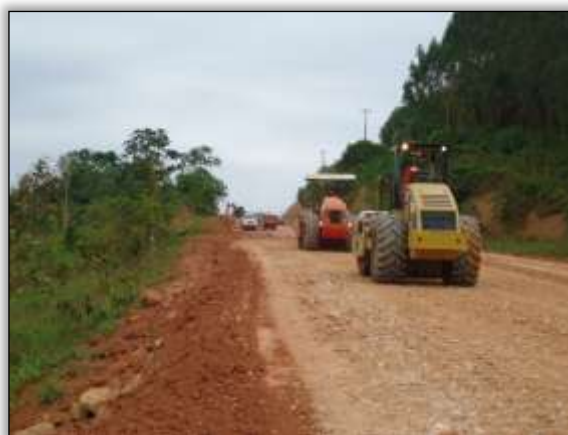
Foto 1055 – Processo erosivo em fase de recuperação. Lado esquerdo. S 05.13041° W 049.39634° . 12/11/2013
