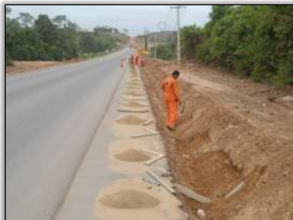
Foto 1139 – Dispositivo de drenagem (Sarjeta). Lado esquerdo. Estaca 4730. S 03.57708° W 051.07933° 12/11/2013
