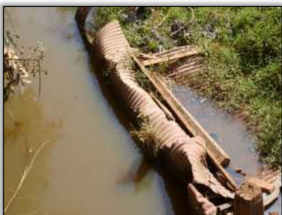
Foto 1329 – Ponto 16 – Jusante – Resto de bueiro Armco. 4.764052° S 49.611726° W (14/10/2013).
