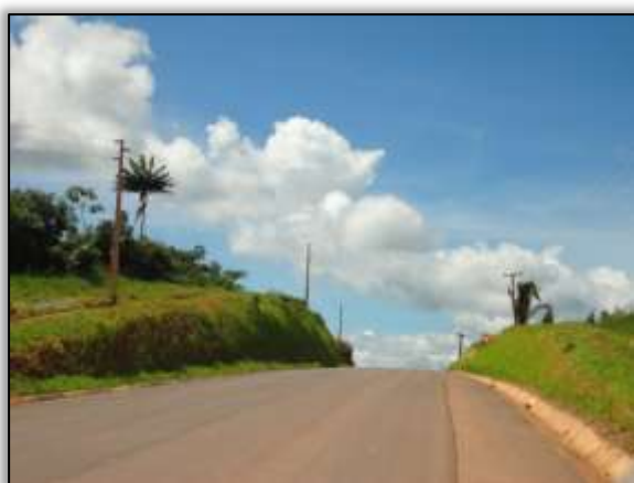
Foto 1076 – Talude de corte com revestimento vegetal. Ambos os lados. S 03.99534º W 050.27109º 29/08/2013
