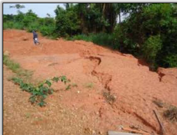
Foto 558 – Processo erosivo em aterro. Lado direito. S 04.19449° W 050.01511° 29/01/2014
