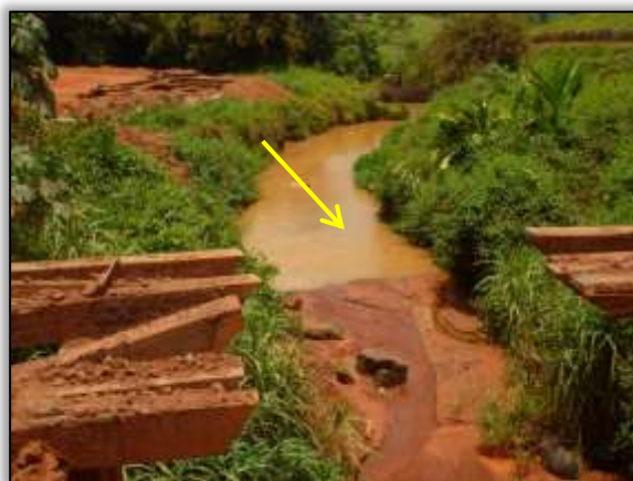
Foto 1458 – Ponto 50 – Montante – Mudança do percurso do igarapé devido à obra de OAC. S 3.411988° W 52.777656° (09/10/2013).
