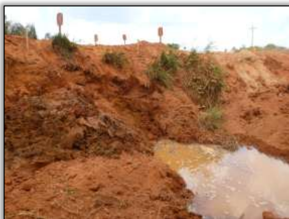
Foto 1390 – Ponto 34 – Bueiro aterrado. 3.625925° S 51.009338° W (11/10/2013).
