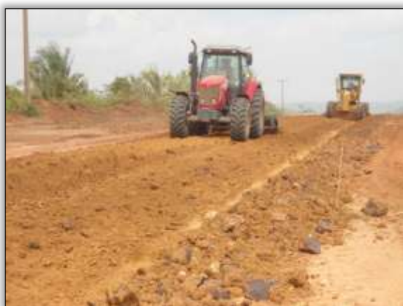
Foto 476 – Gradeamento no corpo estradal. Lado direito. S 05.21997° W 049.34412° 04/12/2013
