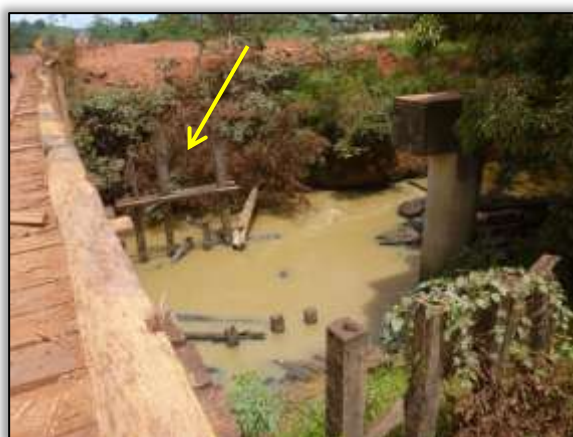
Foto 1450 – Ponto 49 – Montante – Resto de ponte. S 3.387970° W 52.692354° (09/10/2013).
