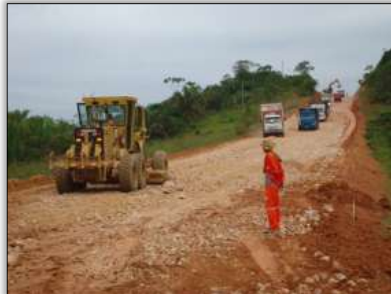
Foto 1052 – Processo erosivo em recuperação. Ambos os lados. S 05.13041° W 049.39634° . 12/11/2013
