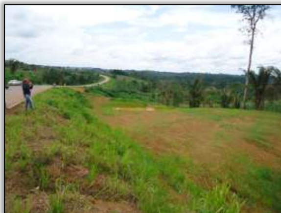
Foto 568 – Revestimento vegetal em aterro e bacia de contenção. Lado esquerdo. S 03.93082° W 050.33002° 29/01/2014
