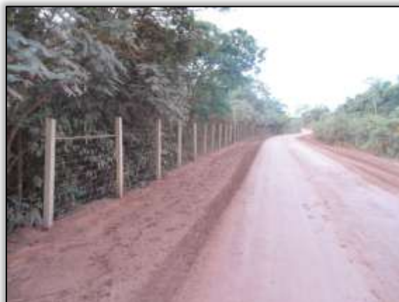
Foto 582 – Cerca instalada na T.I. Parakanã próximo ao rio Xataopawa. Lado esquerdo. S 04.59291° W 049.78441°. 30/10/2013
