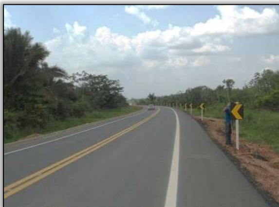
Foto 708– Sinalização vertical. Estaca 3098. Lado Direito. S 03.16118° W 051.56741° 06/12/2013.
