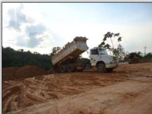
Foto 1066 – Processo erosivo em fase de recuperação. Lado esquerdo. S 05.13041° W 049.39634° 04/12/2013
