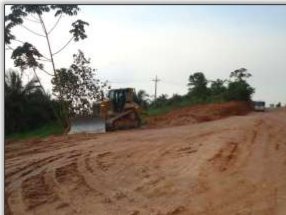
Foto 1067 – Processo erosivo em fase de recuperação. Lado direito. S 05.13041° W 049.39634° 04/12/2013
