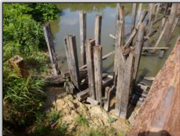
Foto 1505 – Ponto 65 – Montante – Resto de ponte antiga. 4.035205° S 54.698925° W (08/10/2013).
