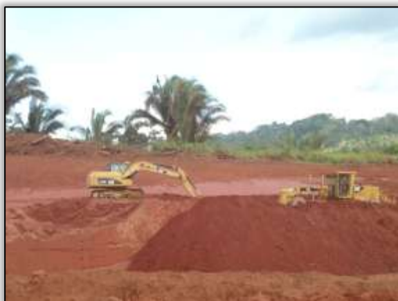
Foto 847 – Corte em talude. Lado esquerdo. Estaca 3556. S 03. 43265° W 052. 81540° 10/09/2013.
