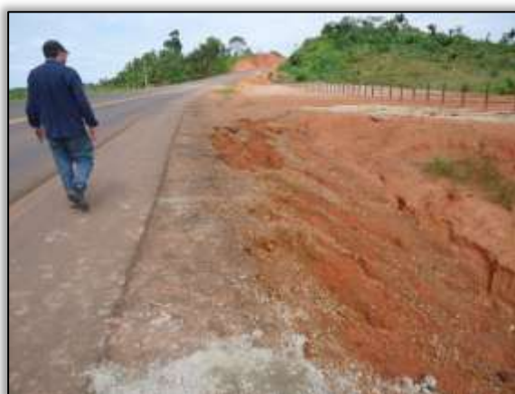
Foto 560 – Processo erosivo no bordo da rodovia. Lado direito. S 04.19280° W 050.02330° 12/12/2013
