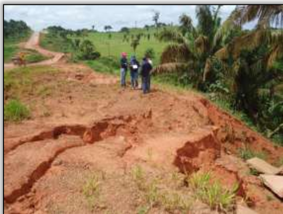
Foto 563 – Rompimento de drenagem. Lado esquerdo. S 04.02377° W 049.28563° 29/01/2014
