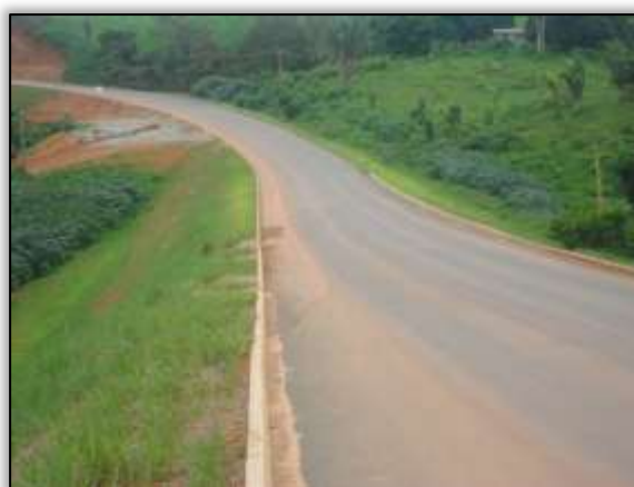
Foto 1077 – Revestimento Vegetal em saia de aterro. Lado esquerdo. S 03.93097º W 050.32787º 29/08/2013
