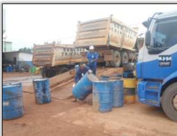
Foto 767 – Coleta de óleo no canteiro de obra. Lado esquerdo. Estaca 1827. S 03.30872° W 052.53631° 13/11/2013.
