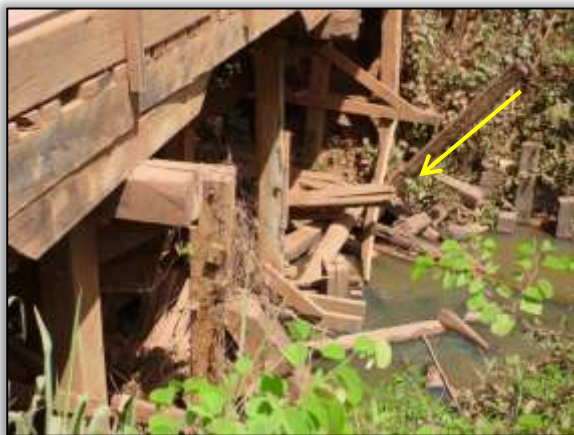
Foto 1324 – Ponto 15 – Montante – Galhos e madeiras no pé da ponte atrapalhando o fluxo de água. 4.810354° S 49.566275° W (14/10/2013).
