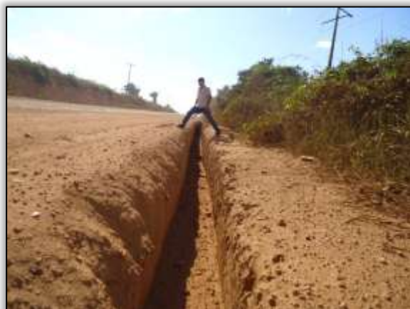
Foto 1025 – Processo erosivo por rompimento de dreno subterrâneo. Lado direito. S 05.22129° W 049.34314° 22/07/2013.
