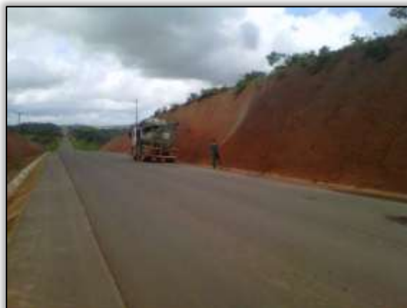
Foto 1075 – Regagem em talude de corte. Lado direito. S 04.00123º W 050.28542º 29/08/2013
