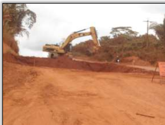
Foto 807 - Corte na pista de rolamento. Estaca 3289. S 03. 40957° W 052. 77177° 14/08/2013
