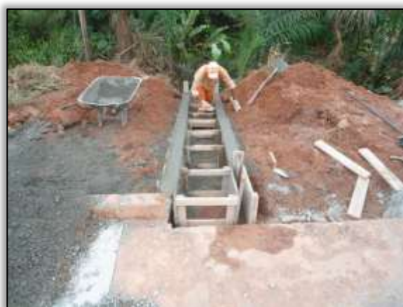
Foto 1141 – Descida d'água. Lado esquerdo. Estaca 3672. S 03.10585° W 051.65064° 20/11/2013
