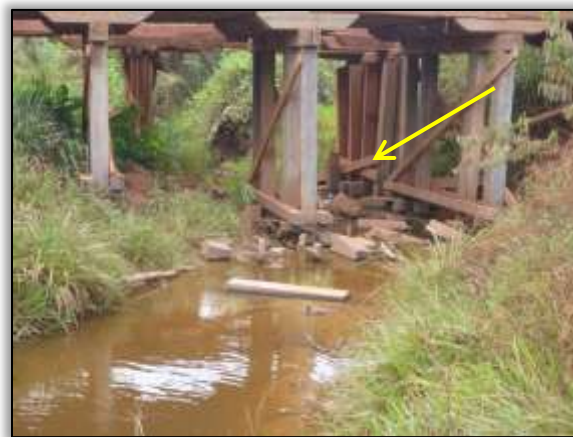
Foto 1352 – Ponto 23 – Montante – Resto de material usado para construção da ponte às margens. 4.159753° S 50.105869° W (12/10/2013).
