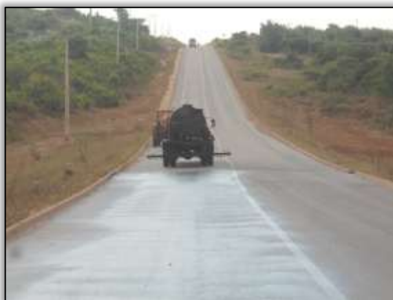
Foto 741- Preparo para colocar camada de asfalto - jogando ADP (asfalto diluído de petróleo). Lado esquerdo. Estaca 4812. S 03.10994° W 051.83340° 22/10/2013
