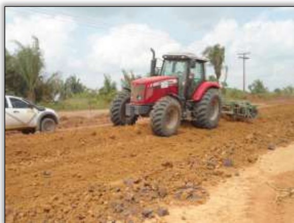
Foto 477 – Gradeamento no corpo estradal. Lado direito. S 05.21997° W 049.34412° 04/12/2013
