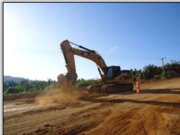
Foto 504 – Correção da saia de aterro. S 03.92769° W 050.35977° 31/07/2013
