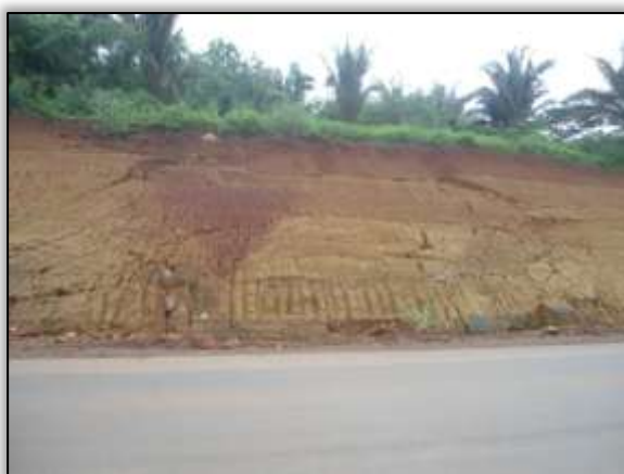
Foto 1206 – Processo erosivo no talude de corte. Lado esquerdo. Estaca 3554. S 03. 43131° W 052. 81432° 28/01/2014
