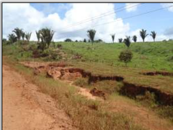
Foto 1114 – Ravinamento em saia de aterro (antes). Ambos os lados. S 04.15903º W 050.12743º 18/06/2013
