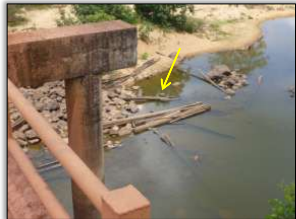
Foto 1405 – Ponto 38 – Jusante – Madeiras e pedras no leito do rio. 3.104357° S 51.645421° W (10/10/2013).
