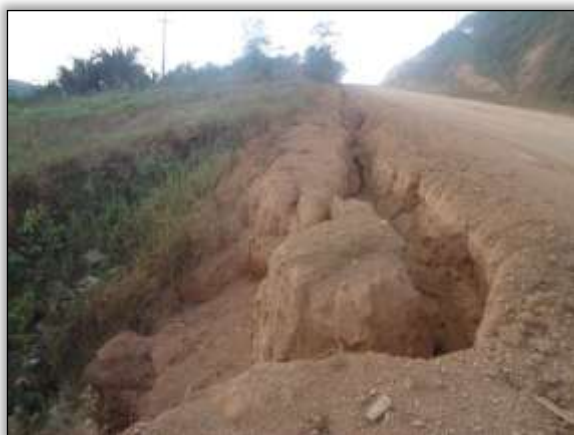
Foto 1064 – Processo erosivo em estágio avançado. Lado esquerdo. S 05.13041° W 049.39634° 15/10/2013
