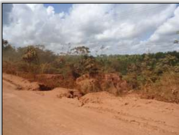
Foto 1112 – Ravinamento em saia de aterro (antes). Ambos os lados. S 04.16764º W 050.07422º 18/06/2013
