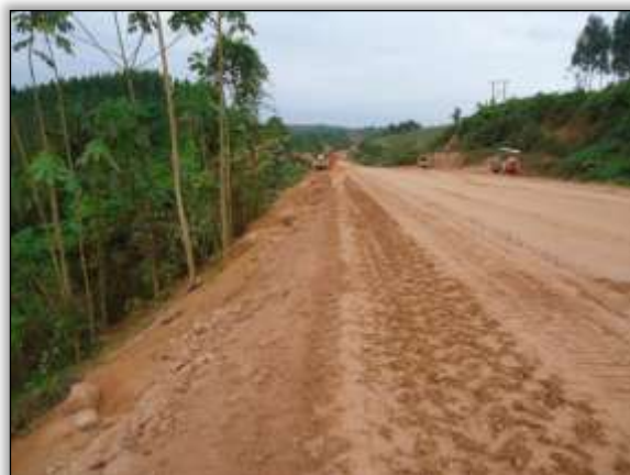
Foto 1057 – Processo erosivo recuperado. Lado esquerdo. S 05.12659° W 049.39826° 12/11/2013
