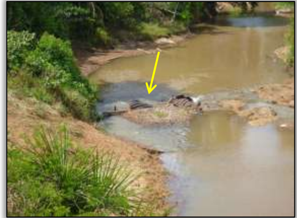
Foto 1418 – Ponto 41 – Jusante – Resto de Bueiro Armco. 3.118070° S 51.816424° W (10/10/2013).
