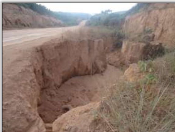
Foto 1060 – Erosão avançando para pista de rolamento em 15/10/2013. Lado direito. S 05.25879° W 049.39858°
