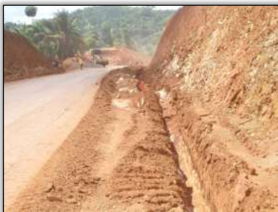
Foto 1126 – Dreno profundo. Estaca 4730. Lado direito. S 03.57708° W 051.07933° 12/11/2013
