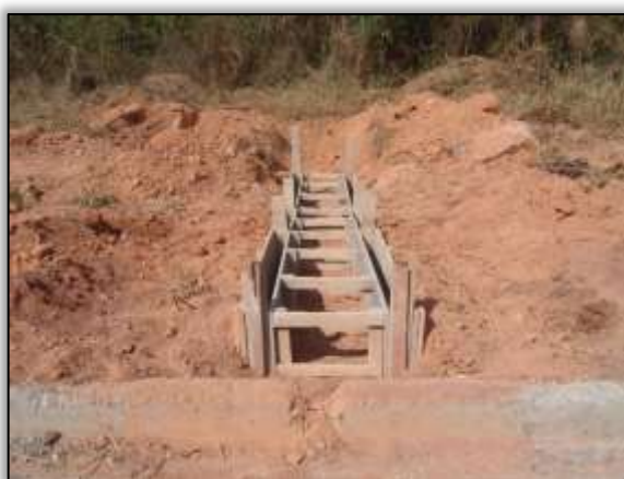
Foto 733 - Construção de sistema de drenagem (descida d'água). Lado direito. Estaca: 3368. S 03.12524° W 051.60093° 09/10/2013
