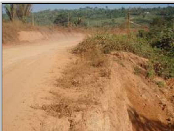
Foto 1094 – Processo erosivo no bordo da pista (antes). Lado direito. S 04.22874° W 049.97234° 18/06/2013
