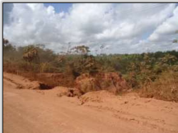
Foto 1068 – Ravinação em saia de aterro. Lado esquerdo. S 04.16764° W 050.07422° 15/08/2013
