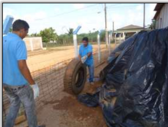
Foto 750 – Retirada dos pneus que estavam armazenados em local inadequado no canteiro de obras. Lado esquerdo. Estaca 1827. S 03.30872° W 052. 53631 14/08/2013
