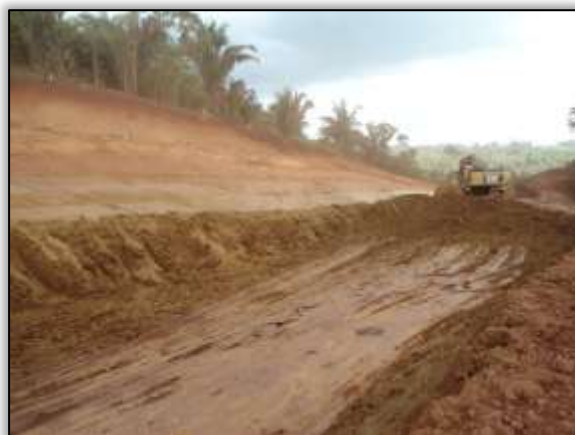
Foto 848 – Corte na pista de rolamento. Lado esquerdo. Estaca 3547. S 03. 43161° W 052. 81446° 10/09/2013.
