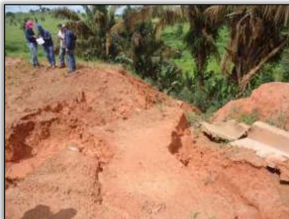
Foto 564 – Rompimento de drenagem. Lado esquerdo. S 04.02377° W 049.28563° 29/01/2014
