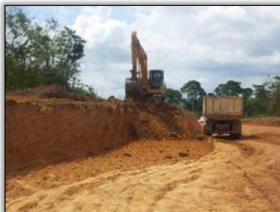
Foto 984 - Corte em talude. Lado esquerdo. Estaca 8763. S 03. 88965° W 054. 27910° 23/10/2013.
