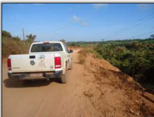
Foto 1092 – Processo erosivo no bordo da pista (antes). Lado direito. S 04.22884° W 049.97191° 18/06/2013
