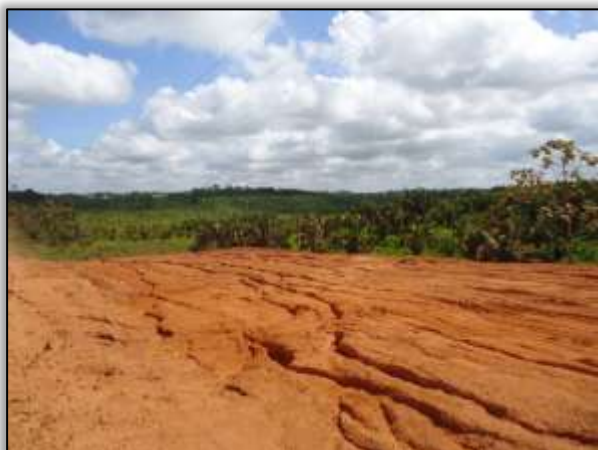
Foto 1108 – Ravinamento em Saia de Aterro (antes). Ambos os lados. S 04.18025º W 050.03599º 18/06/2013
