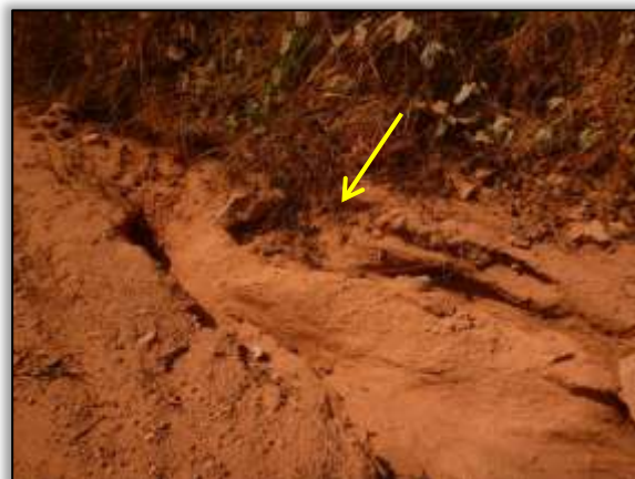
Foto 1385 – Ponto 32 – Montante – Erosão as margens. 3.795758° S 50.763908° W (11/10/2013).
