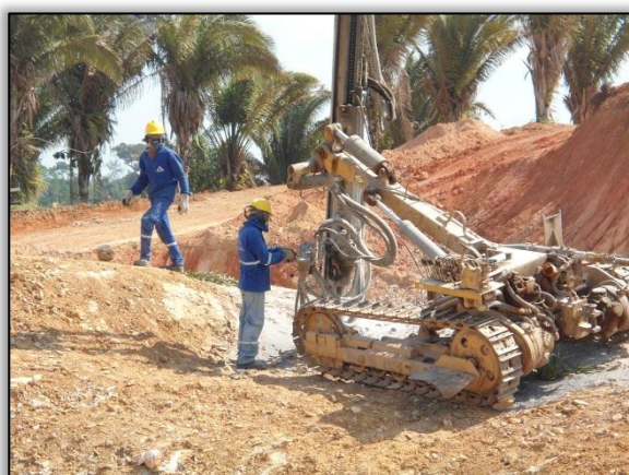
Foto 530 - Uso de Equipamento de Proteção Individual - EPI. Lado Esquerdo. Estaca 570. S 03.44747° W 051. 22433°. 31/07/2012
