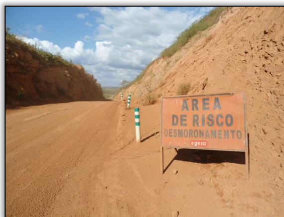
Foto 222 – Sinalização vertical temporária indicando risco de desmoronamento. Lado direito. S 03.85325° W 050.49027° 27/06/2012.
