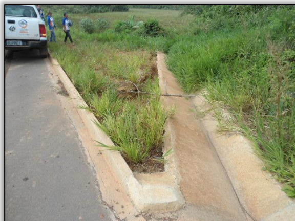
Foto 496 – (Antes) Prolongamento da sarjeta de plataforma danificada. Lado esquerdo. Estaca 08. S 03.54973° W 050.20805°. 05/07/2012
