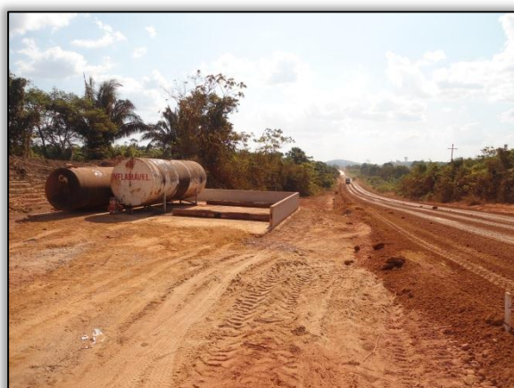
Foto 290 - Tanque de armazenamento de CM30. Lado esquerdo. Estaca 1238. S03. 37465° W051 31404° 31/07/2012
