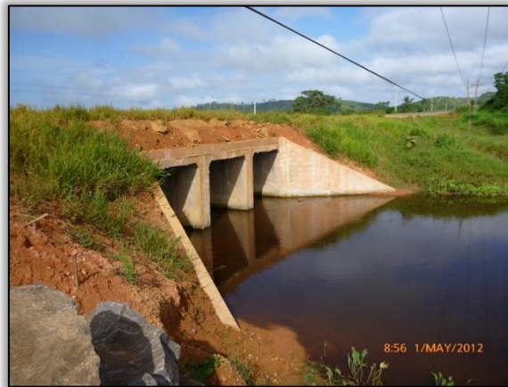
Foto 411 – Ponto 29 – Jusante – Bueiro Triplo. 3.852984°S 50.472992°W
