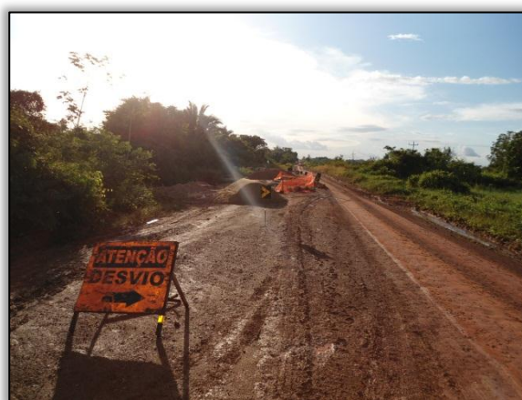
Foto 505 - Construção de bueiro, sinalização de desvio e presença de material. Lado esquerdo. S 03.20085° W 051.53682°. 04/06/2012.
