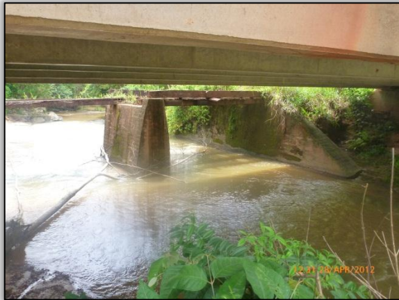
Foto 448 – Ponto 43 – Galhos presos à antiga estrutura da ponte de concreto. 3.133642°S 51.941217°W
