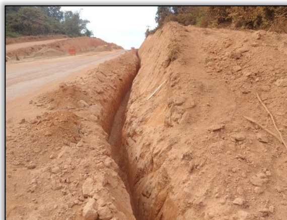
Foto 279 - Dreno longitudinal profundo. Lado esquerdo. Estaca 1981. S 03.30014° W 051.42395° 08/08/2012
