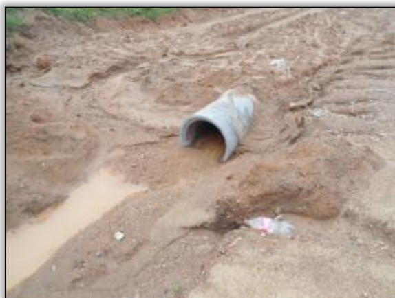
Foto 315 - Bueiro obstruído por material oriundo da escavação. Lado direito. S 05.34983º W 049.11438º 13/02/2012
