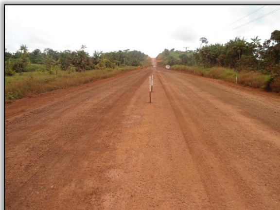
Foto 181- Estaqueamento no eixo da rodovia para implantação do BSTC, na estaca 4280. S 04.03490° W 050.29128°. 30/05/2012
