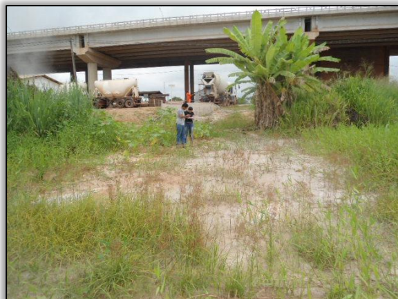
Foto 323 – Área afetada por carreamento de concreto. S 05.35471° W 049.12199°. Em 16/11/2011
