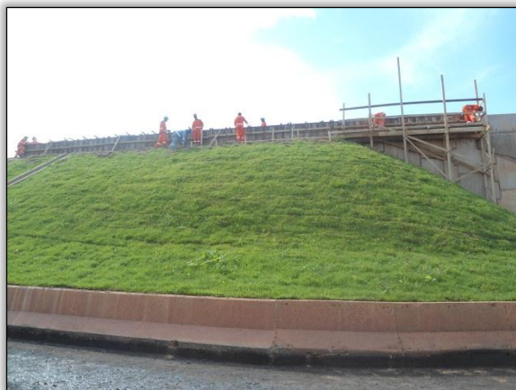
Foto 151 - Talude recuperado na marginal. Lado direito. S 05.35031° W 049.11910° 04/05/2012
