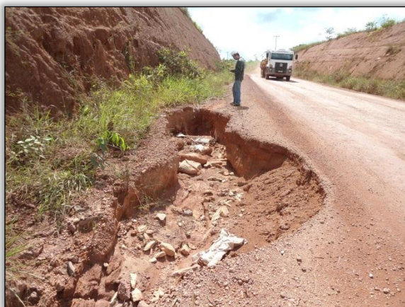
Foto 328 - Erosão na pista avançando para a pista de rolamento. Lado esquerdo. S 04.18287° W 050.03202° 24/04/2012
