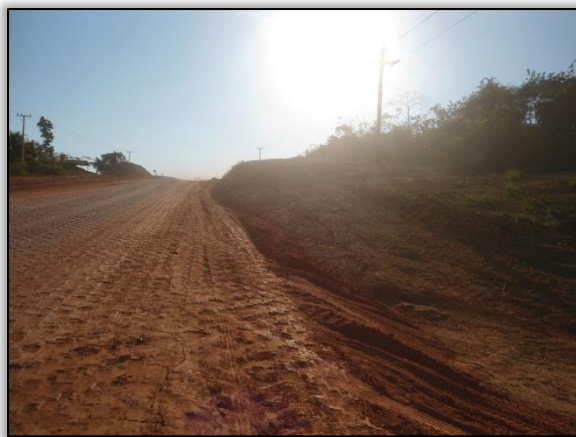
Foto 64 – Área de supressão vegetal ao longo da faixa de domínio. Lado direito. Estaca 1293. S 03.84692º W 050.55413º 31/07/2012.
