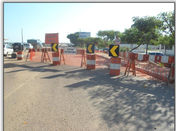
Foto 162 - Sinalização alertando sobre o desvio na rodovia. S 05.35926° W 049. 12276°. 06/06/2012.
