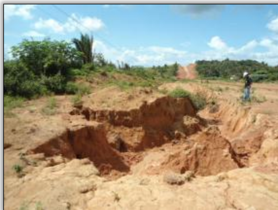
Foto 339 - Processo erosivo em caixa de empréstimo avançando para vegetação remanescente. Lado esquerdo. 11/04/2012. S 04.02733° W 050.28764°
