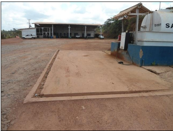
Foto 207 - Canaletas em torno do tanque de abastecimento. S 04.23835° W 049.95459° 14/08/2012
