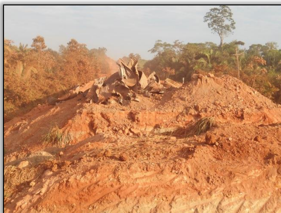
Foto 280 - Restos de bueiro armco. Lado esquerdo. Estaca 2542. S 03.23188° W 051.49794° 08/08/2012
