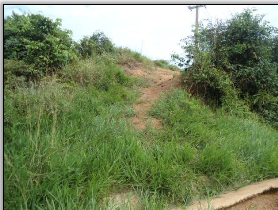
Foto 361 - (Antes) Ausência de valeta de proteção e sarjeta. Lado esquerdo. Estaca 08. S 03.54973° W 050.20805°. 05/07/2012
