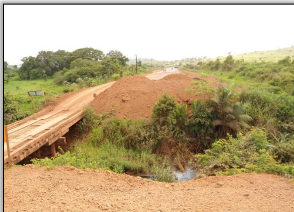
Foto 355 - Material depositado as margens do corpo hídrico em 02/01/2012. Estaca 120. S 03.90519° W 050.36320°
