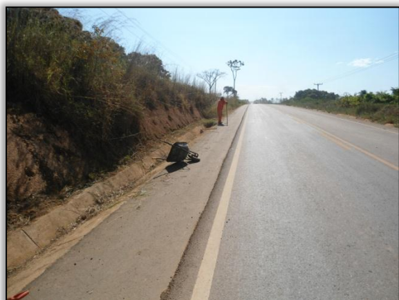
Foto 488 – Colaborador realizando a limpeza da sarjeta as margens da rodovia. Lado esquerdo. S 03.91576° W 050.34739°. 31/072012.
