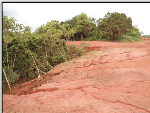
Foto 363 - Processo erosivo no aterro da rodovia avançando para APP em 09/02/2012. Lado Direito. S 03.13222º W 051.72134º
