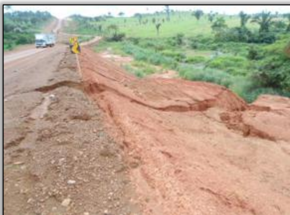
Foto 347 - Processo erosivo em 14/02/2012. Lado direito. S 04.02404° W 050.28588°
