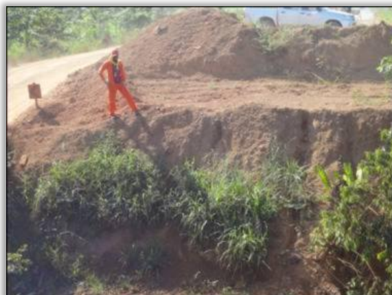
Foto 356 - Material foi afastado da margem do corpo hídrico cerca de 8 metros. Estaca 120. S 03.90519° W 050.36320° 28/06/2012
