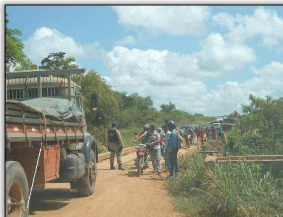
Foto 220 – Conserto provisório da ponte realizada pela CCM para liberar o fluxo. S 03.40500° W 051.27692° 06/06/2012.
