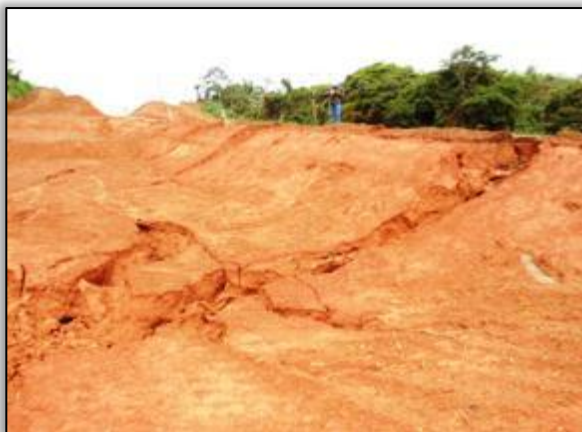
Foto 349 - Vista da saída de aterro em processo erosivo em 14/02/2012. S 04.02404° W 050.28588°
