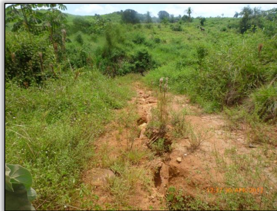
Foto 419 – Ponto 32 – Erosão nas margens decorrente das chuvas. 3.795758° S 50.763908° W
