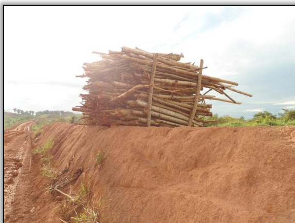
Foto 66 – Material enleirado oriundo da supressão vegetal. Lado direito. Estaca 566. S 03. 44983º W 051. 22015º. 29/06/2012.
