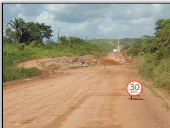
Foto 510 – Sinalização vertical temporária indicando redução de velocidade e desvio, devido a construção de um bueiro. Lado esquerdo. Estaca 724. S 03.19019° W 052.19188°. 16/05/2012.
