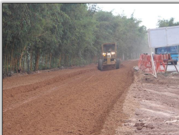
Foto 153 - Terraplenagem na marginal de acesso a ponte sobre o rio Itacaiúnas. Lado direito. S 05.34979° W 049. 11759° 16/05/2012
