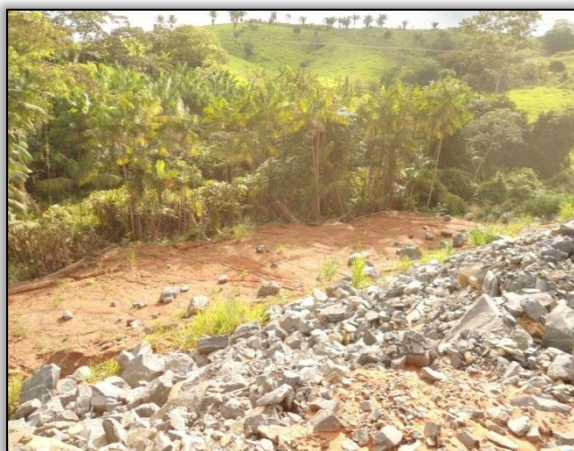
Foto 357 - Material depositado em lugar impróprio avançando para APP e soterrando a vegetação em 13/02/2012. S 03.70309° W 050.91462°
