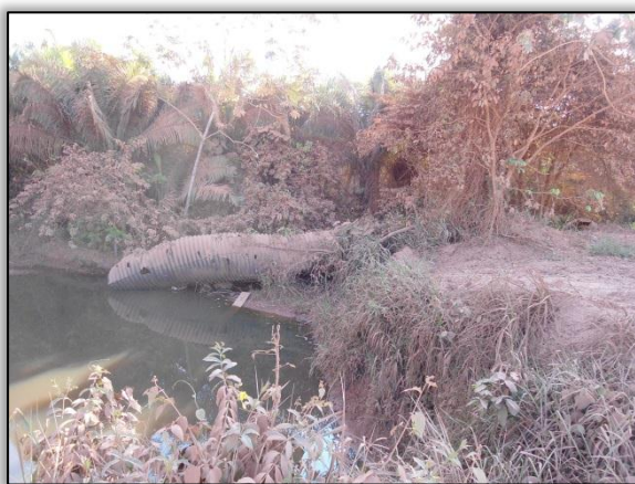
Foto 282 - Bueiro armco em APP. Lado esquerdo. Estaca 3155. S 03.15285° W 051.57433° 06/08/2012
