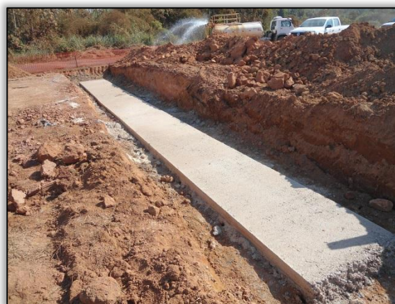
Foto 285 - Base de concreto para bueiro simples tubular de concreto. Estaca 3575. S 03.10868° W 051.63405° 06/08/2012
