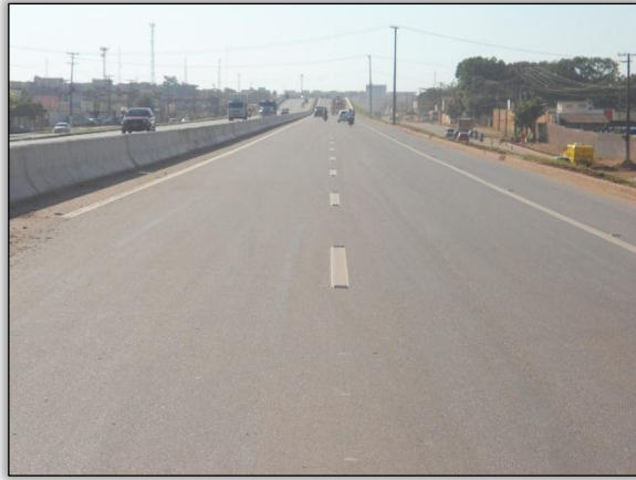
Foto 157 - Sinalização horizontal. Lado esquerdo. 06/06/2012. S 05.35014° W 049. 11846°
