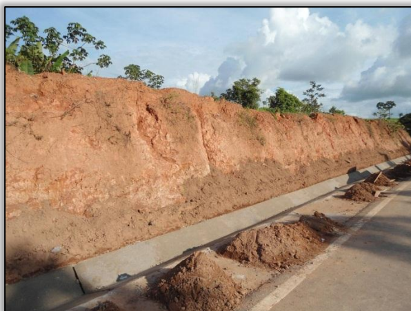
Foto 375 – Processos erosivos em 10/02/2012. Estaca 5122. Lado Direito. S 03.09428 ° W 051.87760°
