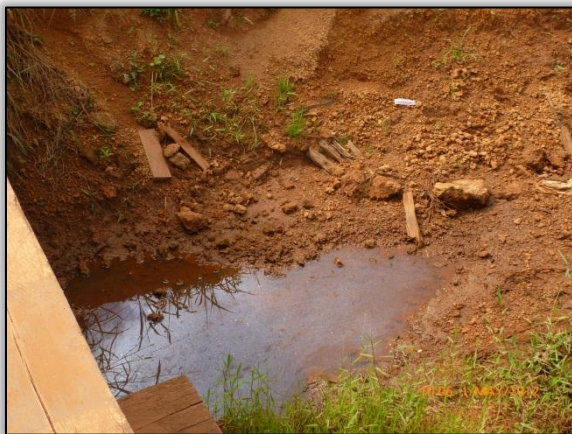
Foto 404 – Ponto 27 – Jusante - Assoreamento. 3.905142° S 50.363235° W
