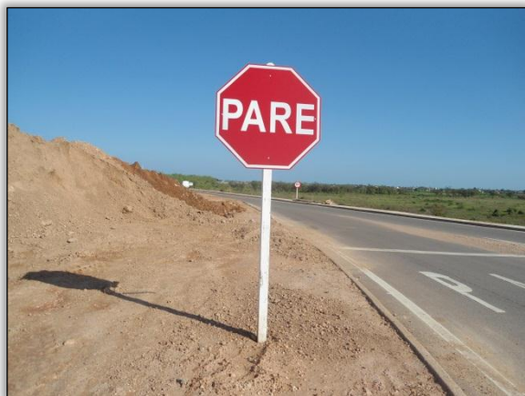
Foto 161 - Sinalização vertical na marginal. Lado direito. S 05.35005° W 049. 11774°. 06/06/2012.
