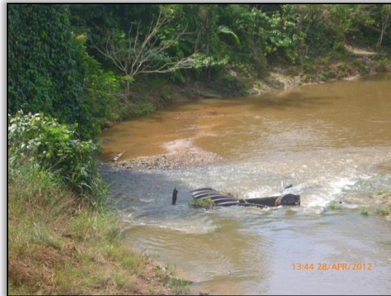
Foto 444 – Ponto 41 – Jusante – Resto de bueiro Armco dentro do rio. 3.118070°S 51.816424°W
