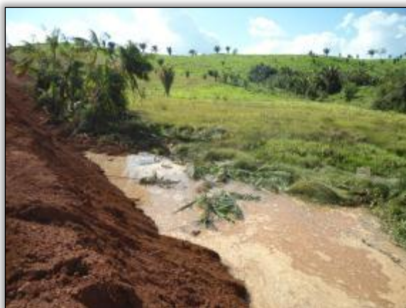
Foto 351 - Vegetação depositada em local inadequado em 12/06/2012. Lado direito. S 03.96160° W 050.27191°
