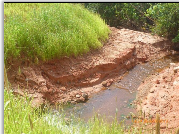
Foto 439 – Ponto 40 – Jusante. Assoreamento nas margens. 3.133422°S 51.717803°W
