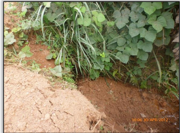
Foto 425 – Ponto 35 – Jusante – Bueiro tampado devido a conserva da estrada. 3.564519°S 51.086520°W
