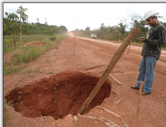
Foto 329 - Buraco devido ao rompimento de bueiro tipo ARMCO no km 323,6. S 04.17223 W 050.06030° 24/04/2012
