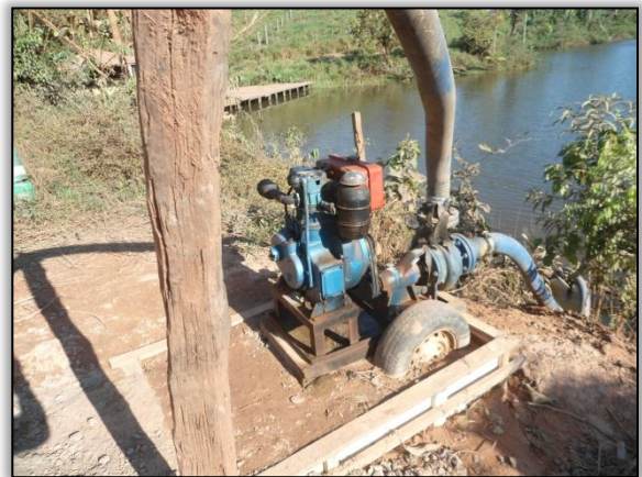
Foto 236 - Moto-bomba e caixa de contenção. Lado esquerdo. Estaca 1203. S 03.84412° W 050.53922° 31/07/2012
