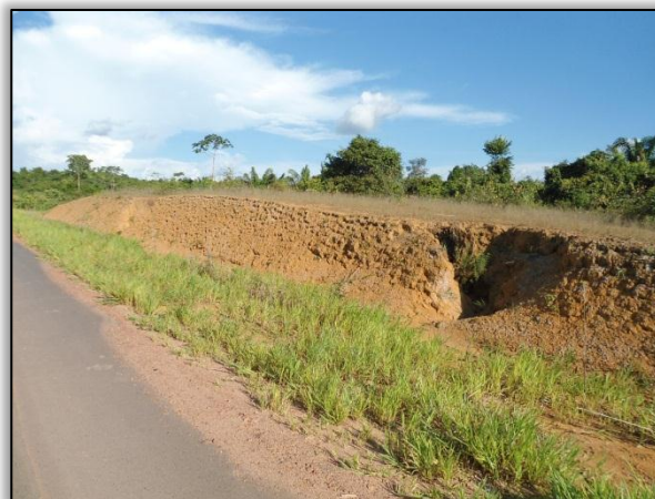
Foto 372 – Realizada hidrossemeadura, mas não houve a germinação total. Recomenda-se que no próximo inverno seja refeita. Lado Esquerdo. S 03.10414º W 051.84574º. 28/06/2012.
