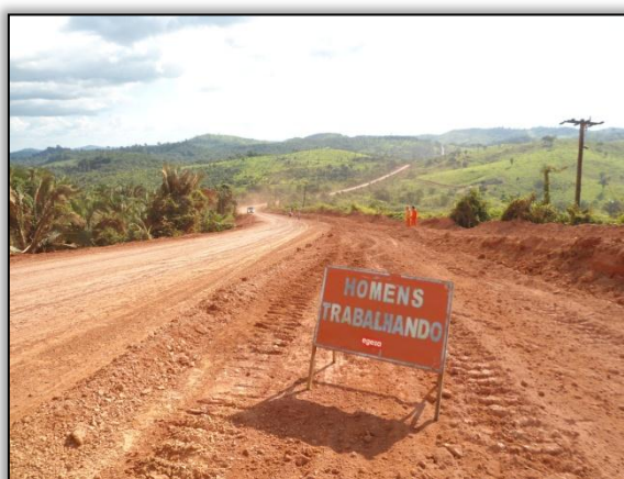
Foto 223 – Sinalização vertical temporária onde está acontecendo a supressão vegetal. Lado direito. Estaca 1330. S 03.84566° W 050.56038° 27/06/2012.
