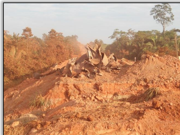
Foto 557 - Restos de bueiro armco. Lado esquerdo. Estaca 2542. S 03.23188° W 051.49794°. 08/08/2012
