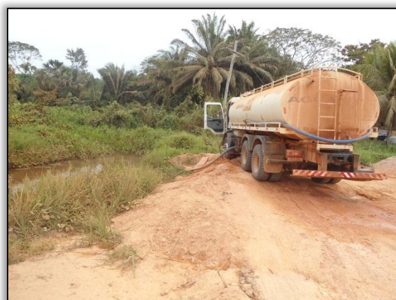
Foto 565 - Captação de água. Lado direito. Estaca 2048. S 03.29291° W 051.43317° . 08/08/2012
