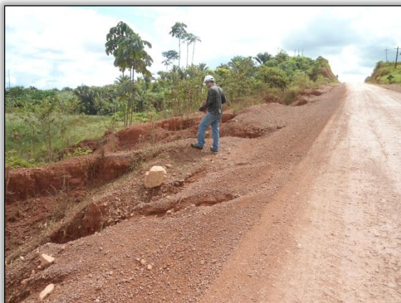
Foto 330 - Processos erosivos devido ao escoamento de águas pluviais. Lado esquerdo S 04.17232º W 050.19154 24/04/2012
