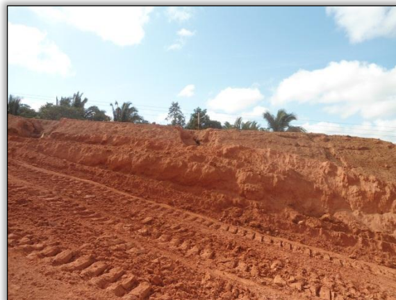
Foto 350 - Processo erosivo em saída de aterro recuperado. S 04.02404° W 050.28588° 04/07/2012
