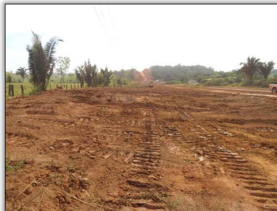
Foto 340 - Processo erosivo em caixa de empréstimo recuperado. Lado esquerdo 29/05/2012. S 04.02733° W 050.28764°
