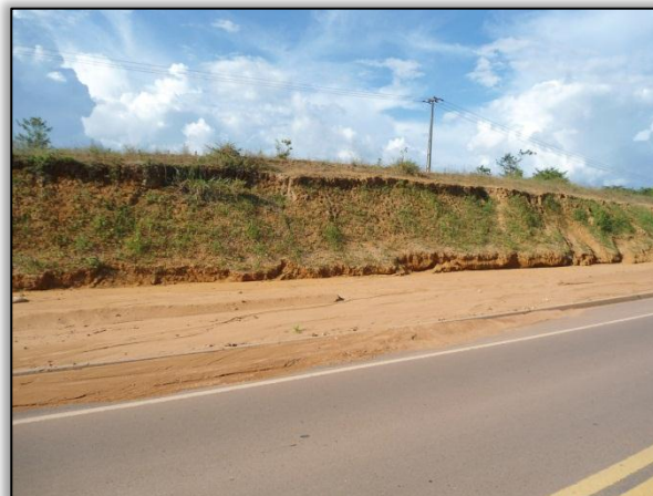
Foto 370 – Realizado hidrossemeadura para conter o processo erosivo. Lado Direito. S 03.10414º W 051.84574º 28/06/2012
