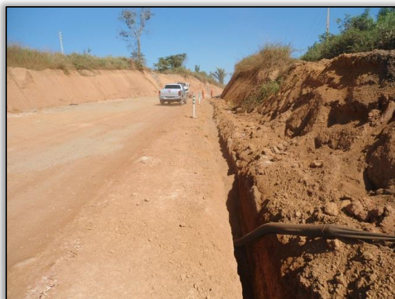
Foto 225 – Drenagem profunda. Lado direito. S 03. 85345° W 050. 46827° 19/07/2012.
