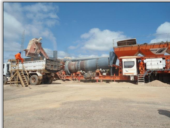
Foto 173 - Visão ampla da fábrica de asfalto. S 05.36744° W 049.05860° 17/05/2012
