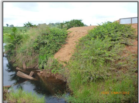
Foto 405 – Ponto 27 – Jusante – Aterro e madeira dentro do igarapé. 3.905142° S 50.363235° W
