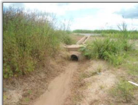
Foto 316 - Assoreamento em boca de bueiro. Lado direito. S 05.34996º W 049.11887º 29/03/2012
