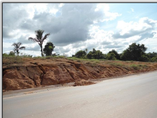
Foto 367 – Processos erosivos em 09/02/2012. Estaca 4840. Lado Esquerdo. S 03.10572º W 051.84259º
