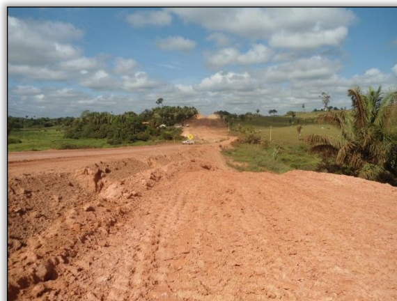
Foto 348 - Processo erosivo em saia de aterro recuperado. Lado direito. S 04.02404 W 050.28588° 04/07/2012
