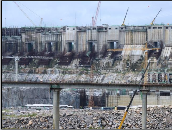
Foto 40 – Ponte em construção na Transamazônica, no trecho de desvio na rodovia Transamazônica que atravessa o canteiro do Sítio Belo Monte. 23/04/2015
